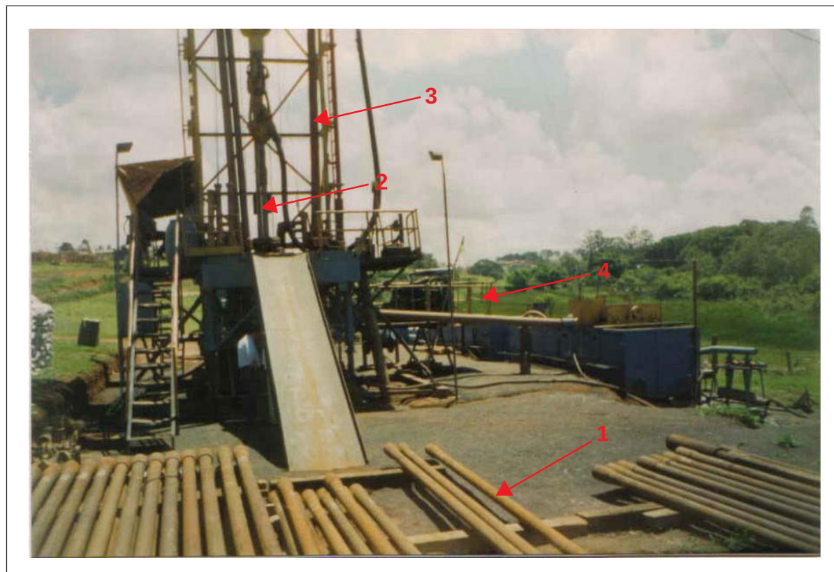
Figura 7.- Detalhes de instalação de uma sonda rotativa
