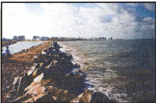
ISL 6 – Encoramento (“rip-rap”) exposto
