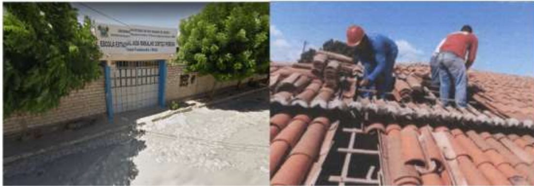
Figura 32 – Foto da fachada e de parte das obras - ESCOLA ESTADUAL AINDA RAMALHO DE CORTEZ PEREIRA - Mossoró/RN
