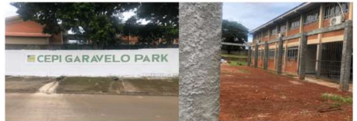
Figura 31 – Foto da fachada e de parte das obras - CEPI GARAVELLO PARK - Aparecida de Goiânia/GO
