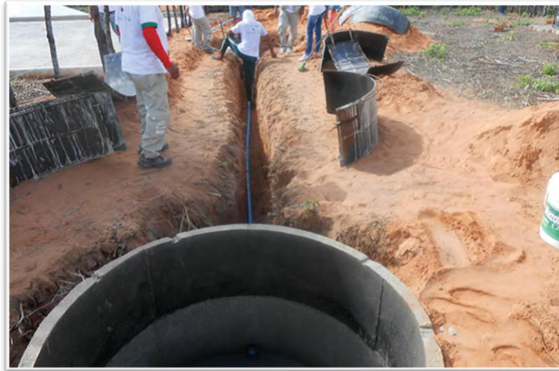
Figura 12: Conexão do filtro biológico ao tanque de reuso
