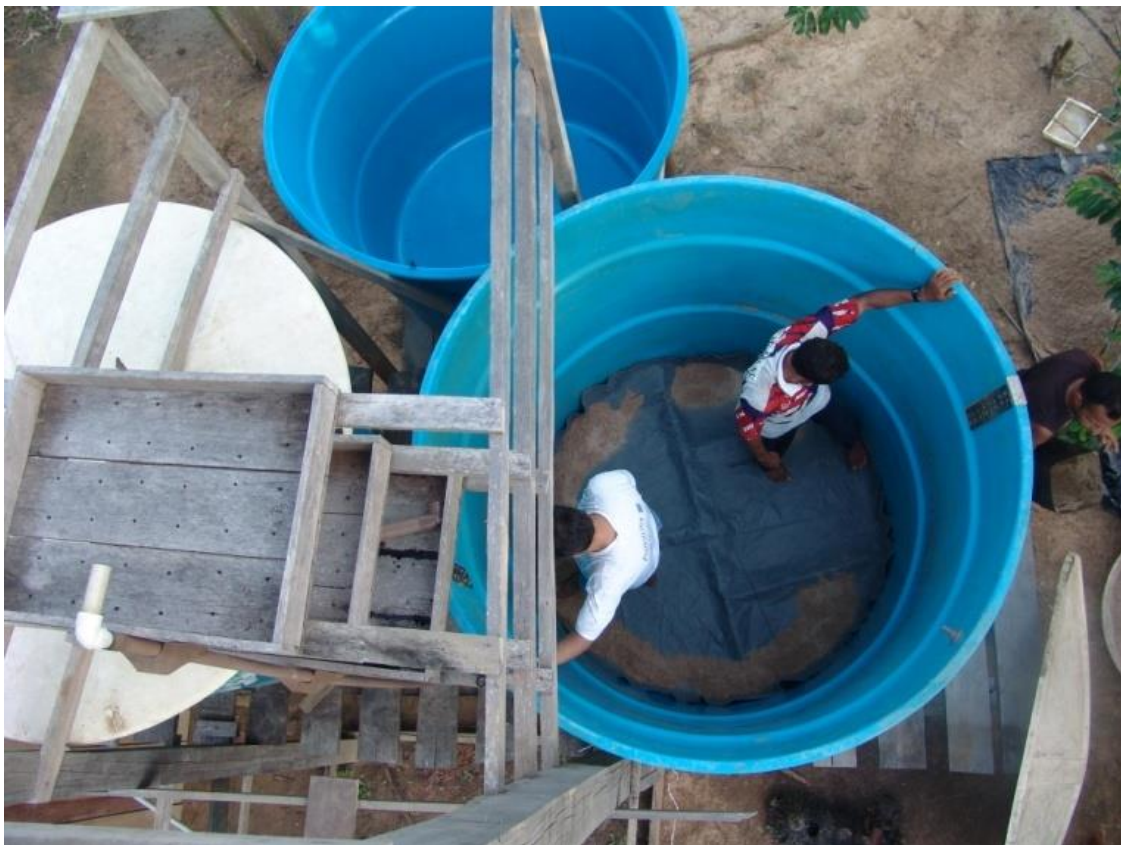
Figura 8: Exemplo de filtro lento de areia construído com caixa de 5.000 litros.
