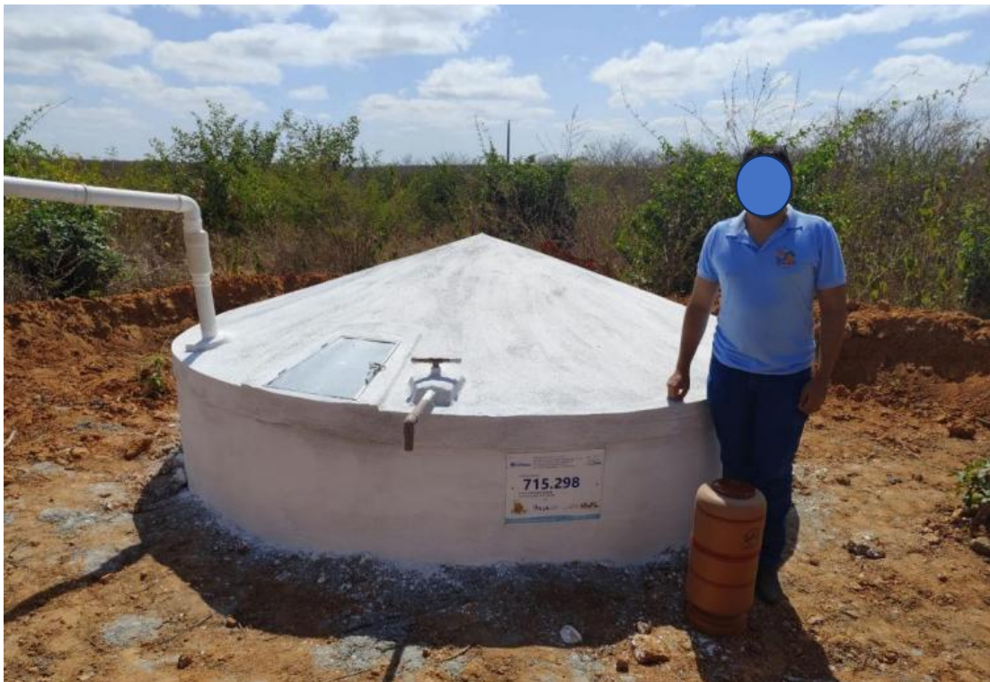
Foto 2: Modelos de registros fotográficos para visualização do dispositivo de descarte, filtro de barro, calha, telhado e beneficiário
