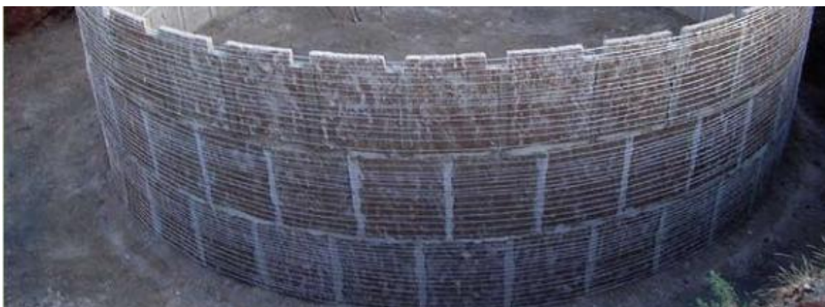
Figura 6: Amarração da parede da cisterna
