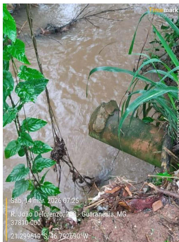
Figura 3-- Lançamento direto de efluentes sanitários in natura oriundos da rede unitária municipal diretamente no leito do Rio Canoas, evidenciando a degradação da qualidade da água.
