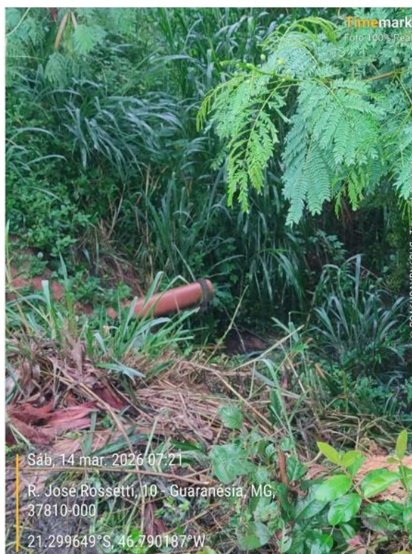
Figura 4-Tubulações de esgoto de residências ribeirinhas desaguando clandestinamente nas margens dos cursos d'água na Sede do município de Guaraniésia, cenário que será erradicado com a implantação dos interceptores.
