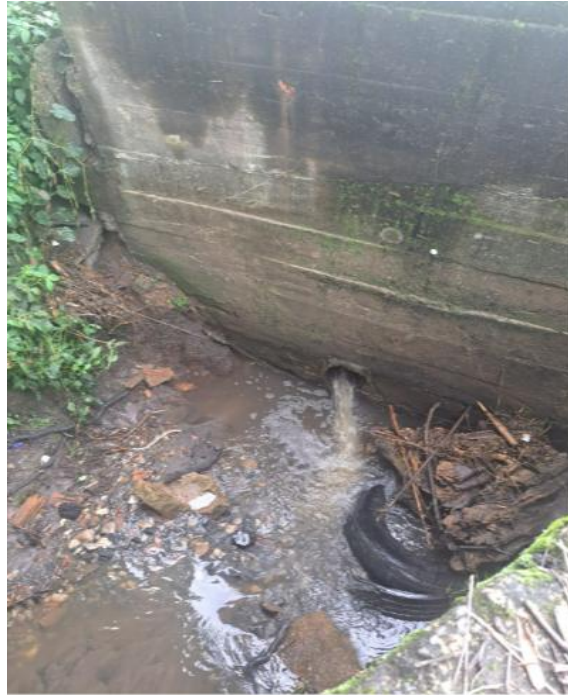
FOTO 1: Lançamento de esgoto in natura no corpo hídrico.
