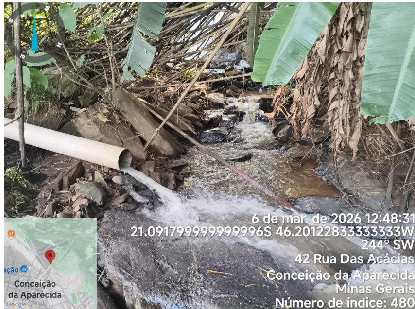
Figura 1: Ponto de lançamento de esgoto bruto ( in natura ) oriundo da rede coletora municipal. Nota-se o impacto direto no corpo hídrico receptor e a alteração das características físicas da água.
