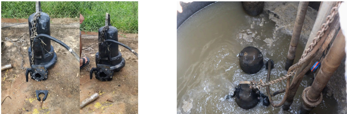
Figura 02 – Conjunto motobomba submersível apresentando falha operacional crítica, evidenciando a necessidade de substituição e aquisição de equipamentos reserva para assegurar a continuidade do sistema.
