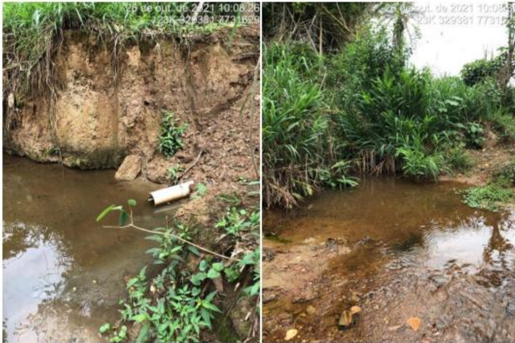
Figura 3-Lançamento do esgoto bruto da parte alta do Distrito de Babilônia no Córrego da Vargem.
