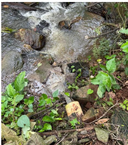
Figura 1-Lançamento de esgoto in natura no Ribeirão do Cavaco.
