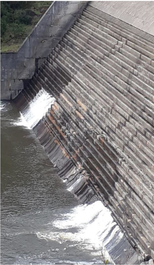
Vazamento detectado no corpo da barragem.
