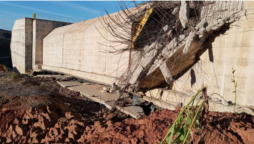
Conduto de tomada d'água rompido. Foto: SEDEC
