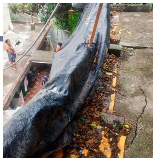
Figura 7. Trinca em muro de retenção de mais de 3 metros. Fonte: LabGRis, 2020.
