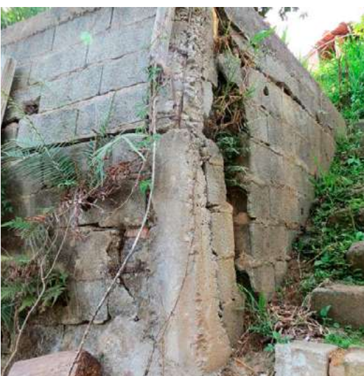
Figura 5. Muro embarrigado. Fonte: LabGRis, 2020.
