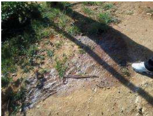
Figura F6: Vazamento em rede de água em talude de corte
