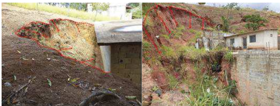
Figura F9: Deslizamentos planares associados a áreas desmatadas
