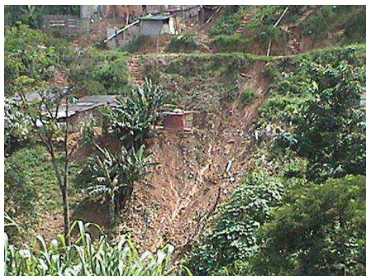
Figura F15: Vista de cicatriz de deslizamento planar em área de risco
