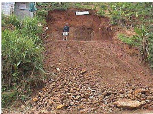
Figura F2: Vista de corte em encosta de área de risco
