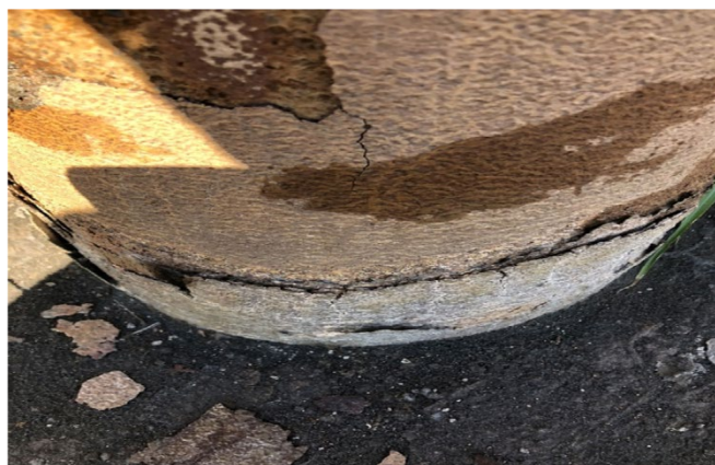
Figura 94 - Tubo de aço corroído, sem pintura
