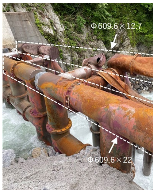
Figura 111 - Diferença entre os danos causados em tubos de aço com distintas espessuras
