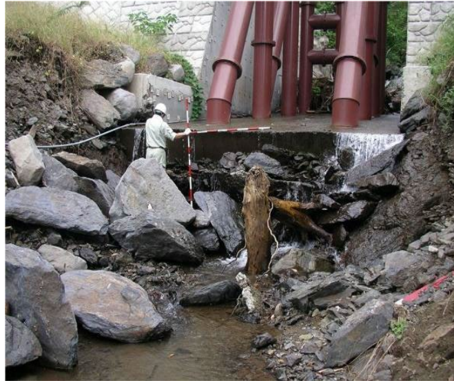
Figura 124 - Erosão a jusante do bloco de ancoragem
