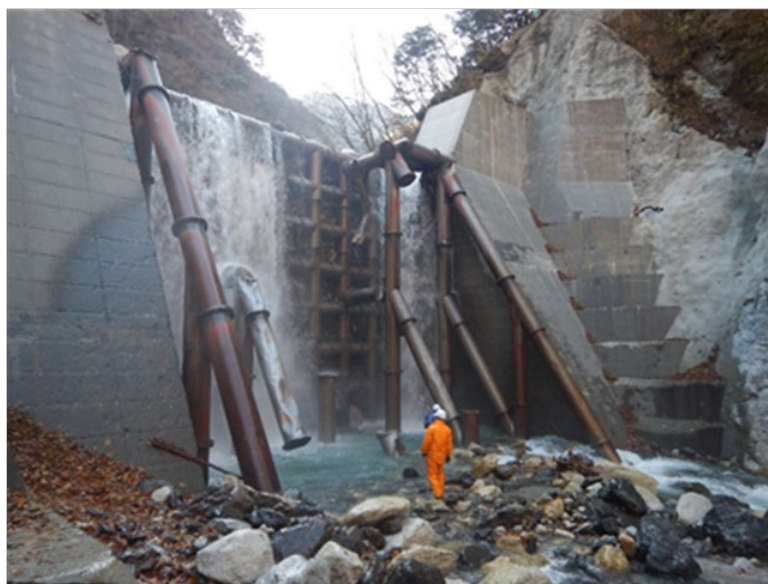
Figura 100 - Perda de partes da estrutura de aço a jusante, causada por detritos que sobrepassaram a barreira
