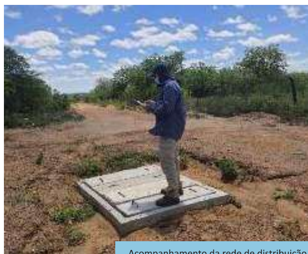
Acompanhamento da rede de distribuição do sistema de irrigação da VPR Lafayette.
