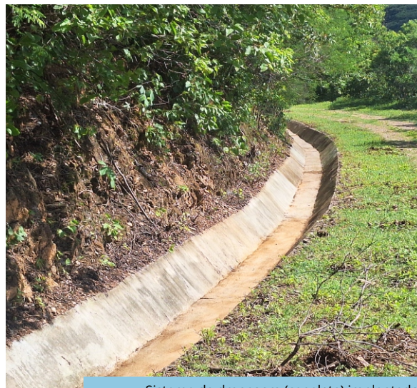
Sistema de drenagem (canaleta) implantado no entorno do reservatório Atalho (WBS 1112), Trecho II, Eixo Norte do PISF (abril/2026).
