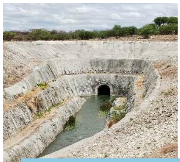
Sistema de drenagem (overchute) implantado no segmento de canal WBS 2218, Trecho V, Eixo Leste do PISF.
