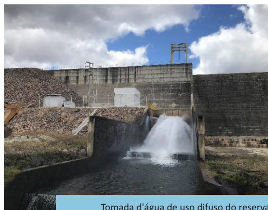
Tomada d'água de uso difuso do reservatório Porcos, WBS 1113, Trecho II, Eixo Norte do PISF, em Brejo Santo/CE.
