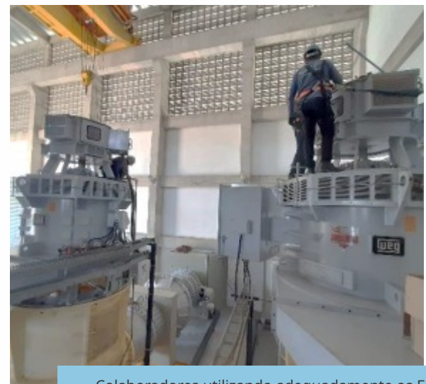
Colaboradores utilizando adequadamente os EPIs (trabalho em altura), durante manutenção no sistema de bombeamento da EBV-5, Trecho V, Eixo Leste.
