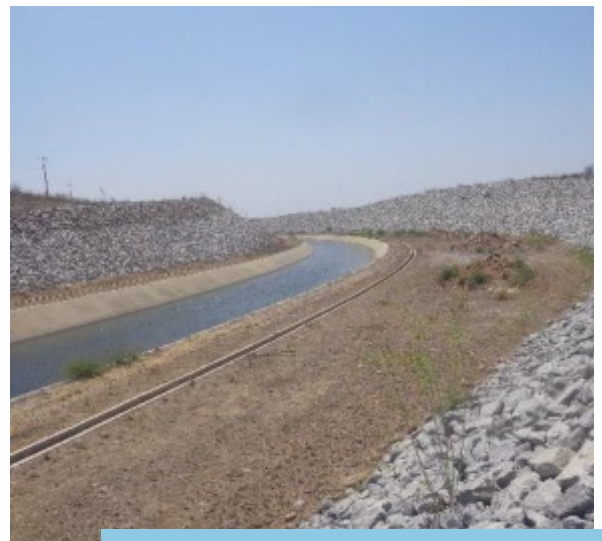
Enrocamento de proteção em talude na faixa de domínio do segmento de canal WBS 2204, Eixo Leste.
