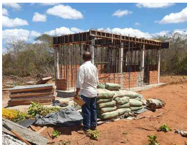
Construção do booster do sistema de irrigação da VPR Vassouras (Brejo Santo - CE).
