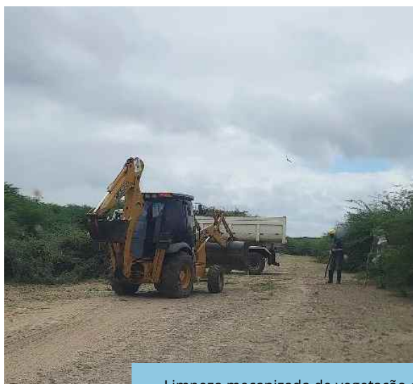
Limpeza mecanizada de vegetação em via de acesso, no segmento de canal WBS 2204.
