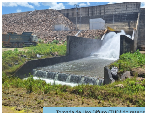
Tomada de Uso Difuso (TUD) do reservatório Porcos (WBS 1113), Brejo Santo/CE - Trecho II, Eixo Norte do PISF (jan/2026).
