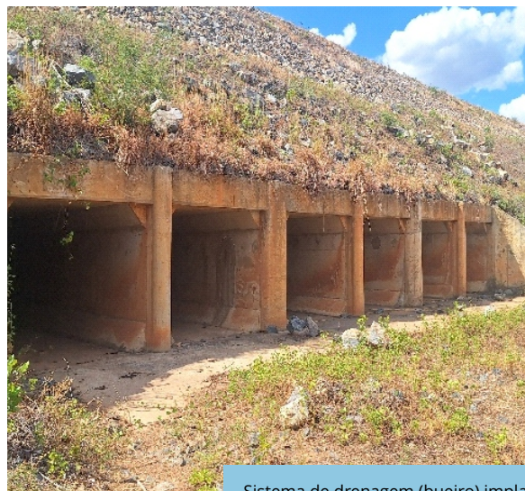
Sistema de drenagem (bueiro) implantado no segmento de canal WBS 1229, Trecho II, Eixo Norte do PISF (dez/2025).
