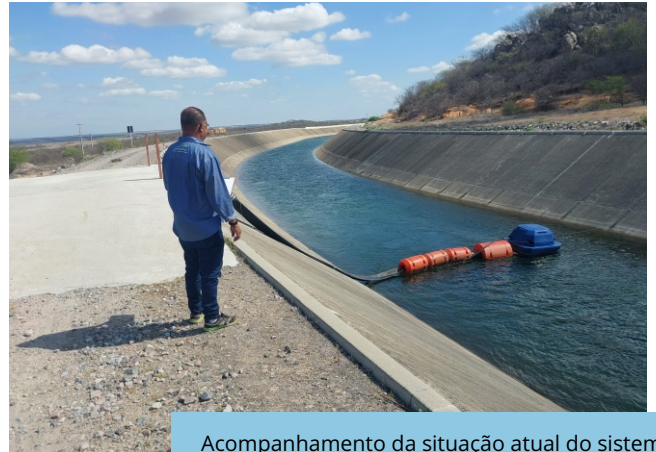
Acompanhamento da situação atual do sistema de irrigação implantado na VPR Uri, Salgueiro/PE.
