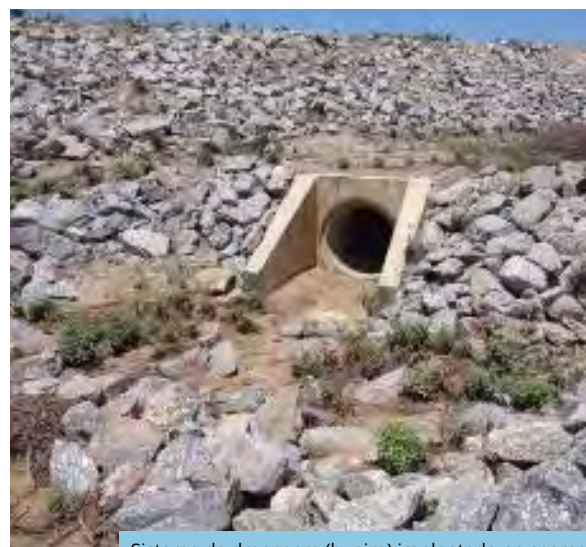
Sistema de drenagem (bueiro) implantado no segmento de canal WBS 2208, Trecho V, Eixo Leste do PISF (dez/2025).
