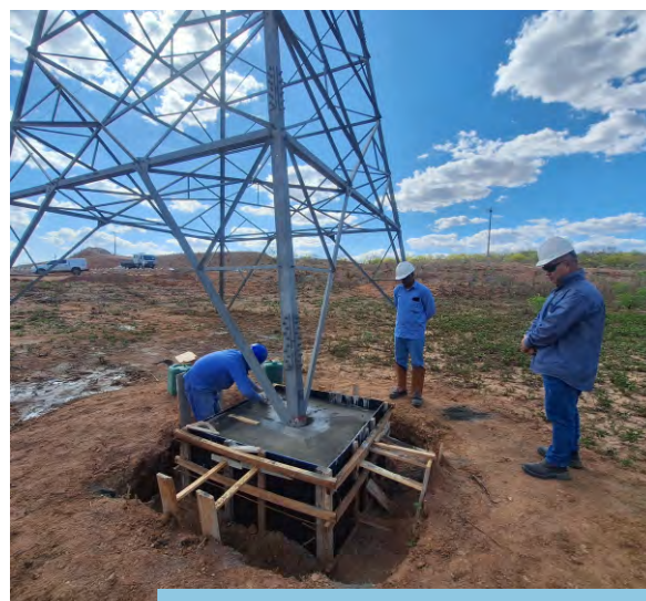
Reforço em estrutura da LT, localizada no entorno do segmento de canal WBS 2212, Trecho V do Eixo Leste do PISF, em Floresta/PE (jan/2026).
