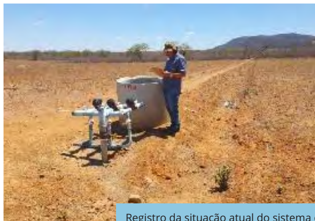
Registro da situação atual do sistema de irrigação implantado na VPR Baixio dos Grandes (Cabrobó/PE), em 12/11/2025.
