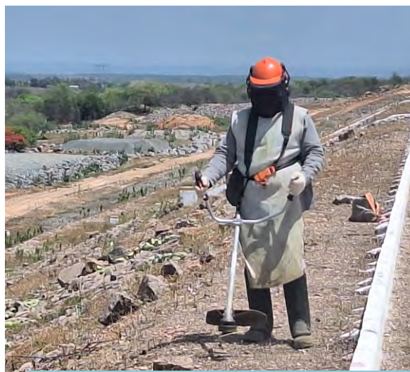
Colaborador do Consórcio Operador em atividade de limpeza de rebota em barragem do reservatório Cipó (WBS 1115), Trecho II, Eixo Norte do PISF (jan/2026).
