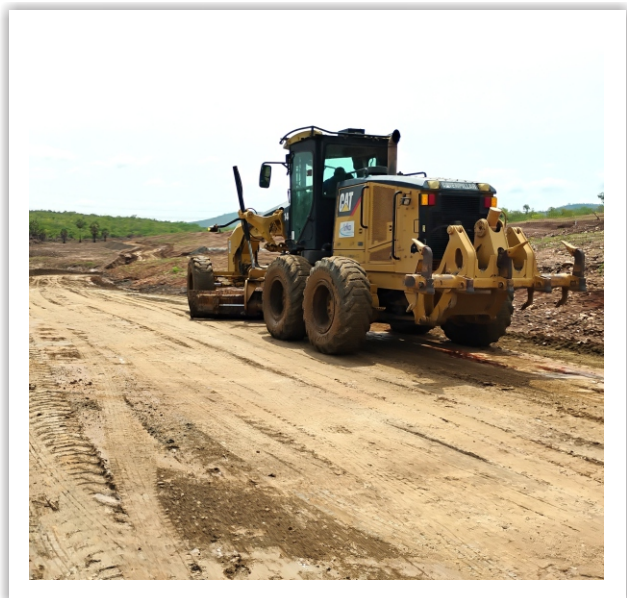
Motoniveladora realizando a manutenção da estrada de serviço do Segmento de Canal 08.
