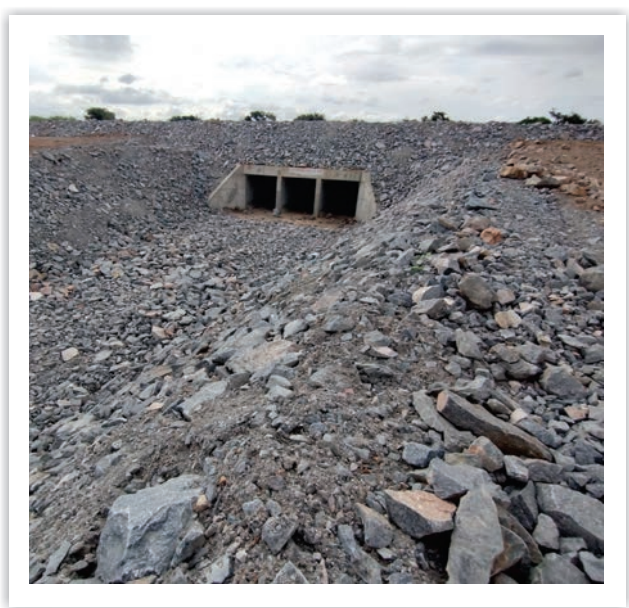
Proteção do talude de aterro e do canal de restituição com enrocamento, no segmento do canal 14B.
