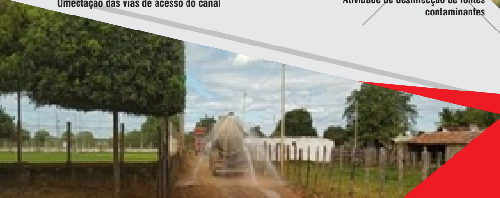
Umectação das vias de acesso do canal
