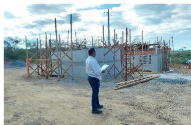
Implantação da estação de bombeamento do sistema de irrigação da VPR Malícia, Pena Forte - CE.
