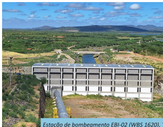
Estação de bombeamento EBI-02 (WBS 1620), Trecho I, Eixo Norte do PISF, em Cabrobó/PE (junho/2026).
