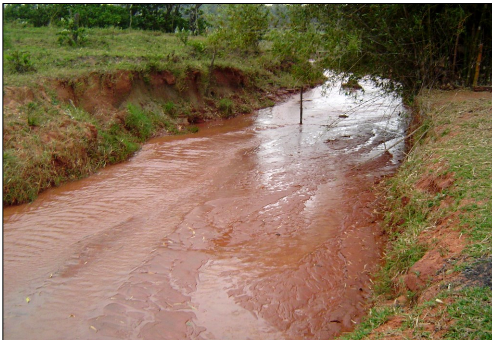
Figura 13 – Taludes marginais sujeitos a erosão (Fonte: Ministério das Cidades, Instituto de Pesquisas Tecnológicas do Estado de São Paulo – IPT, 2007).
