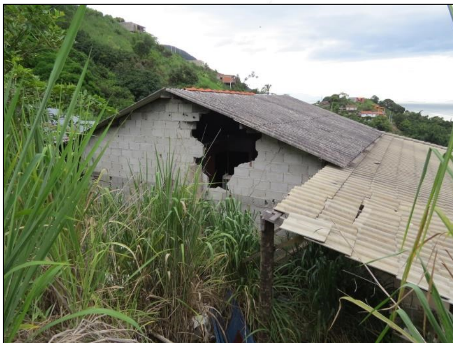
Figura 10 – Moradia atingida por bloco que rolou da encosta, no bairro Morro do Abrigo, São Sebastião (SP). (Fonte: Sirden-CTGeo-IPT).
