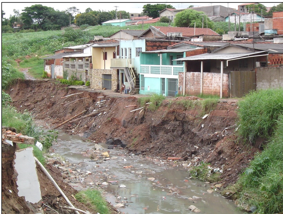
Figura 14 – Situação de risco associada a erosão e solapamento dos taludes marginais, com ocupação ribeirinha (Ministério das Cidades, Instituto de Pesquisas Tecnológicas do Estado de São Paulo – IPT, 2007).
