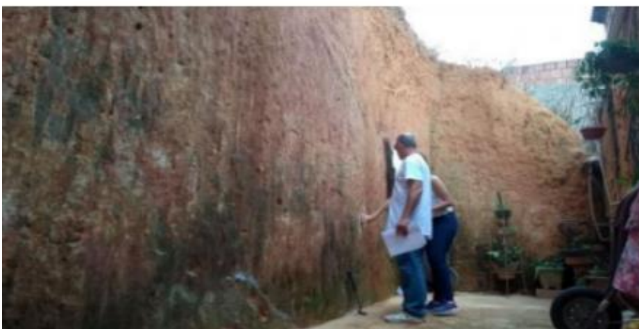
Região com risco de deslizamentos, bairro Posse
