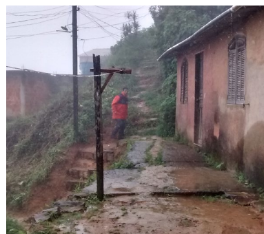
ÁREA DE RISCO DE DESLIZAMENTO EM PETRÓPOLIS (RJ).
