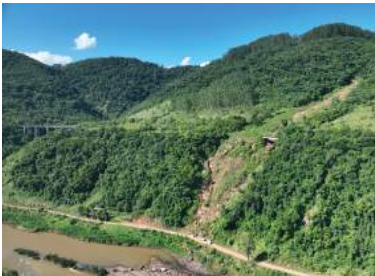
Figura 14. Imagem aérea da EF-491 - Ferrovia do Trigo. À esquerda, Viaduto 11; ao centro, cicatriz de movimento de massa que removeu parte da infraestrutura da linha férrea deixando-a sem apoio no solo; na porção inferior, o Rio Guaporé.
