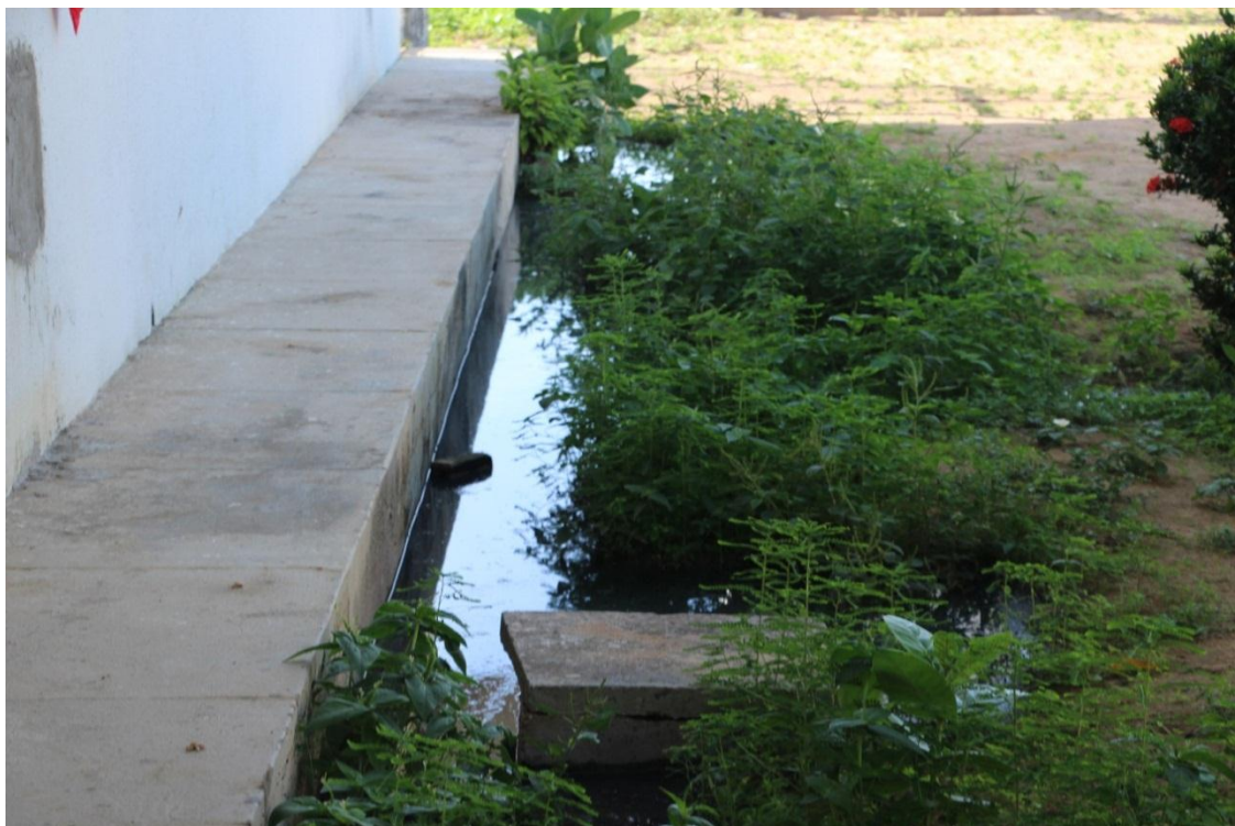
Legenda: esgoto a céu aberto no entorno da edificação da unidade
