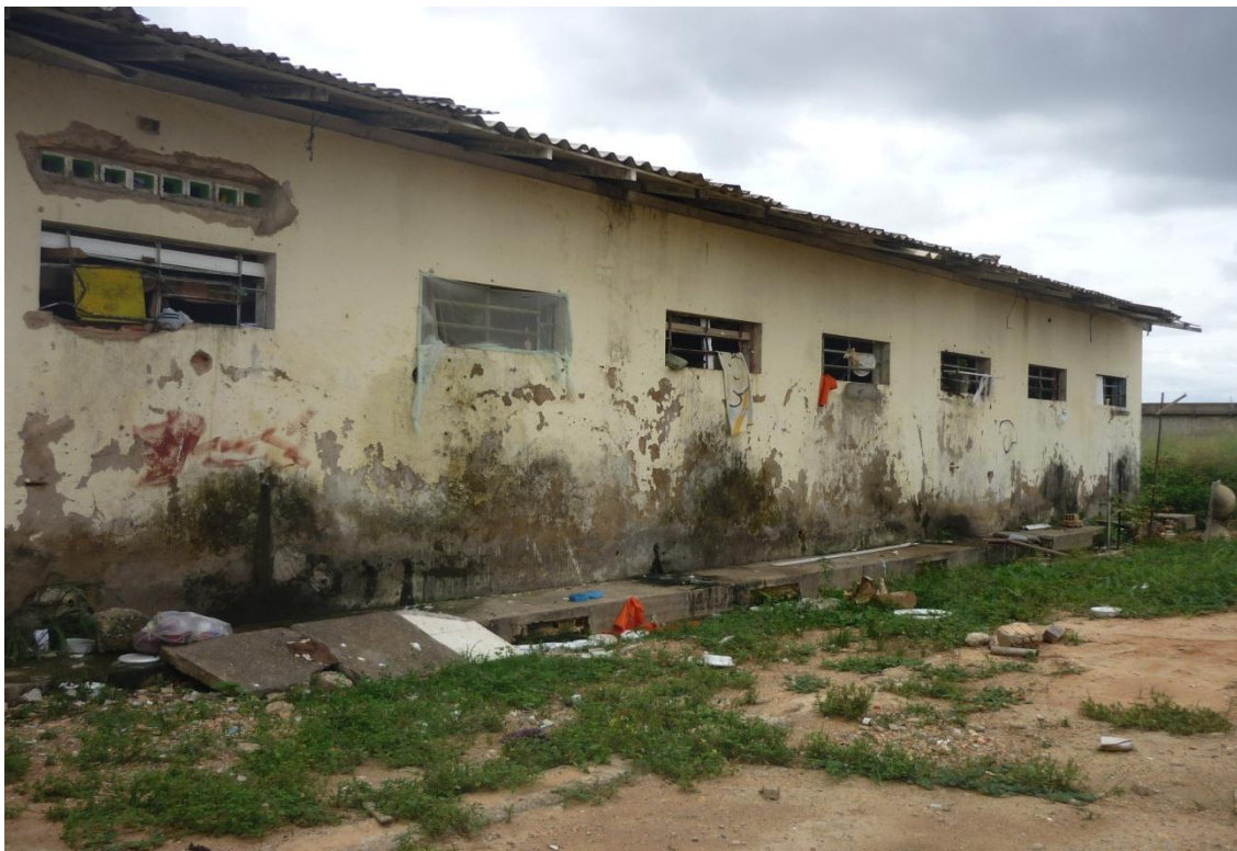
Legenda: Área externa da Ala de Saúde totalmente degradada – Ala 9
