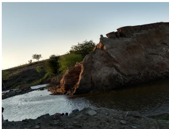
Área de rompimento da Barragem do Quati.
