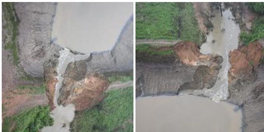
Barragem do Quati rompida. Fonte: Defesa civil do estado da Bahia.
