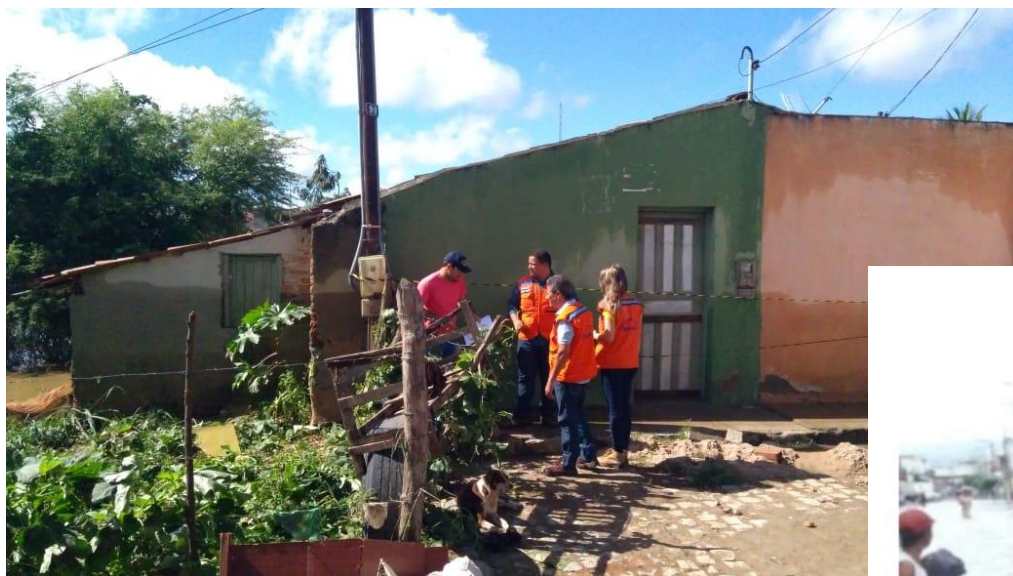
Vistoria das casas inundadas.
