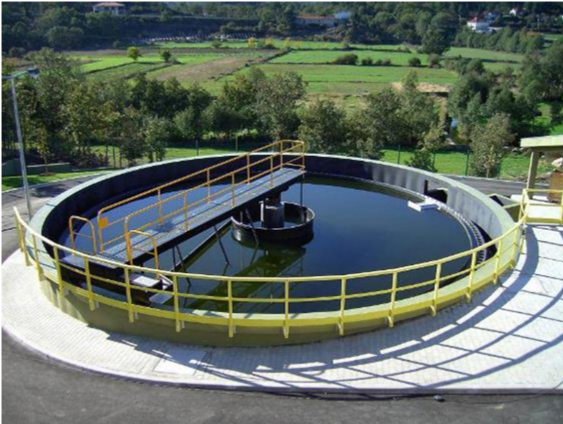
Figura 30 – Tratamento Primário de Esgotos – Decantador Primário
