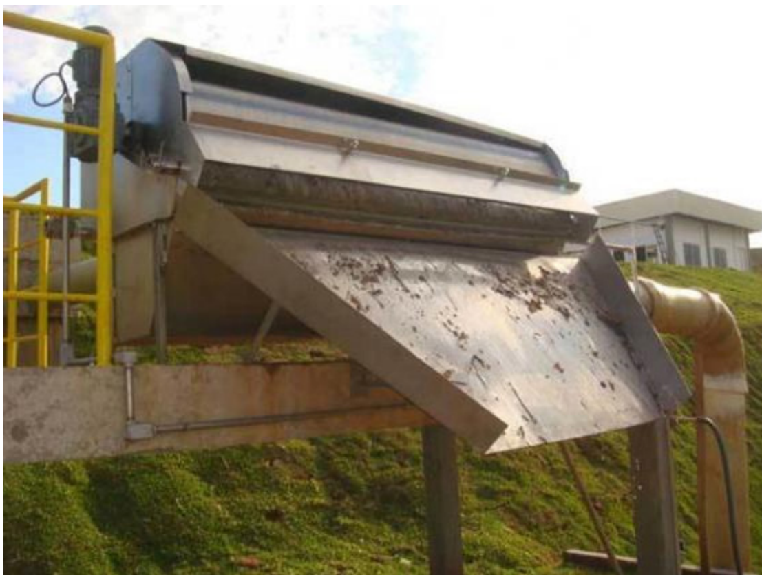
Figura 28 – Tratamento Preliminar de Esgotos – Peneira Rotativa
