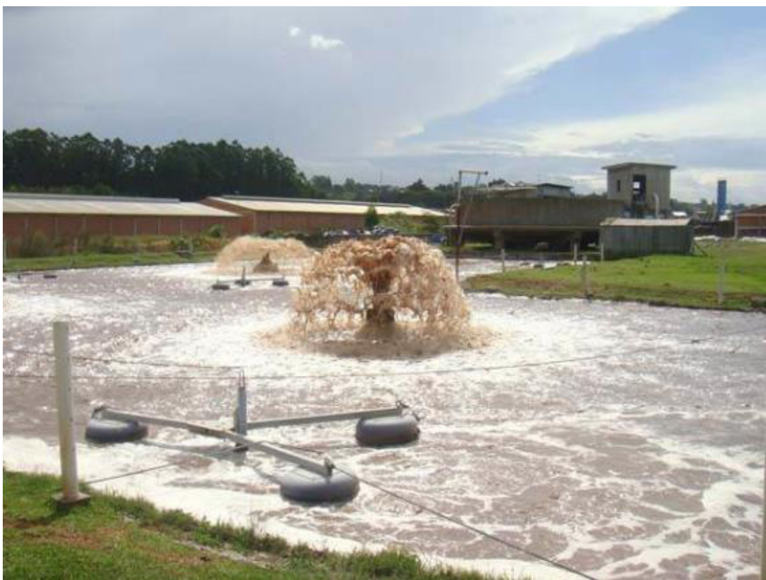
Figura 32 – Tratamento Secundário de Esgotos – Tanque Aerador
