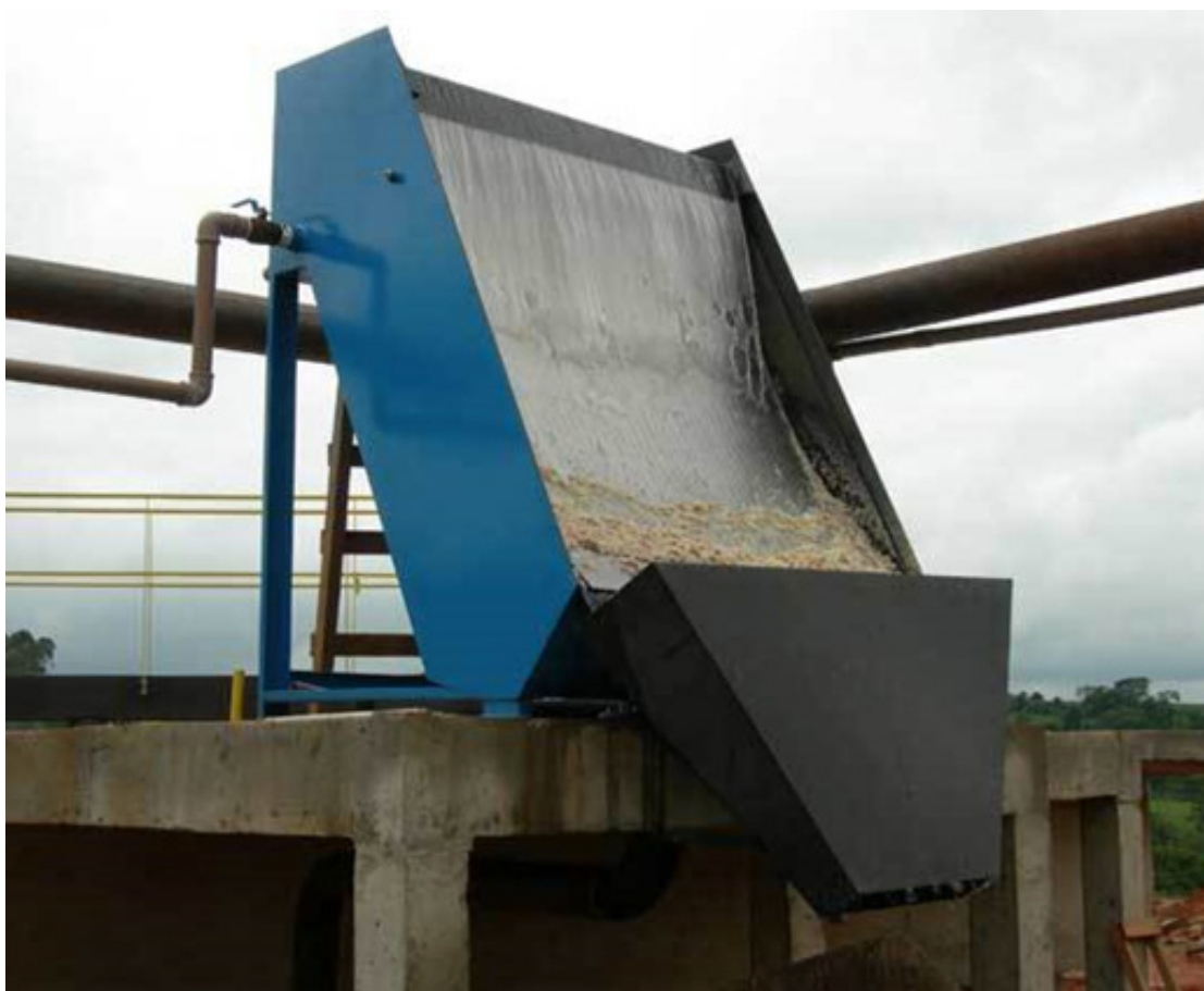
Figura 27 – Tratamento Preliminar de Esgotos – Peneira Estática
