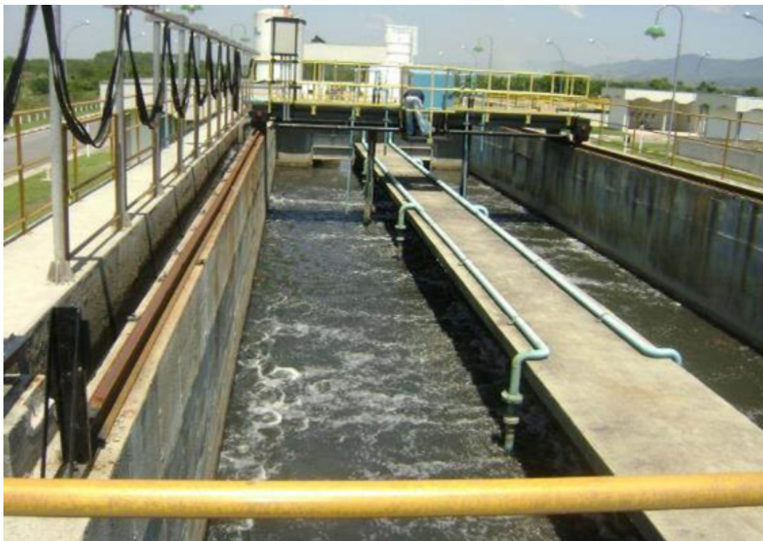
Figura 29 – Tratamento Preliminar de Esgotos – Caixa de Areia
