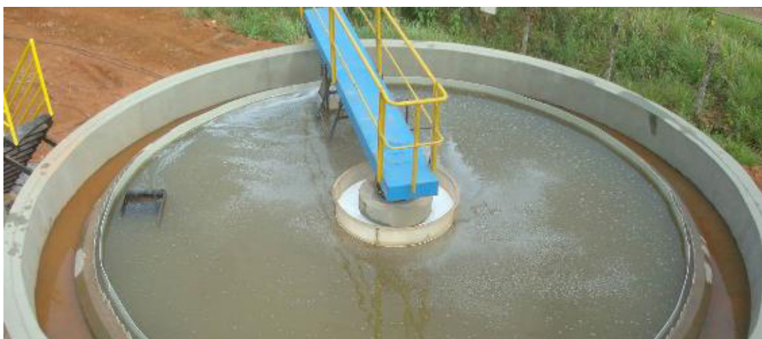
Figura 33 – Tratamento Secundário de Esgotos – Decantador Secundário
