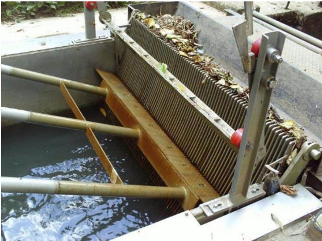
Figura 26 – Tratamento Preliminar de Esgotos – Gradeamento
