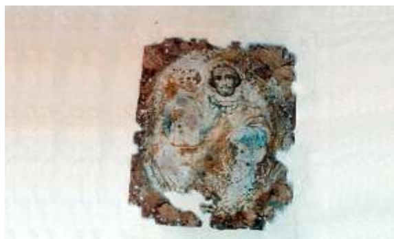
Biodeterioração da pintura
