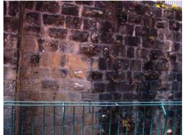
Biodeterioro de la piedra
