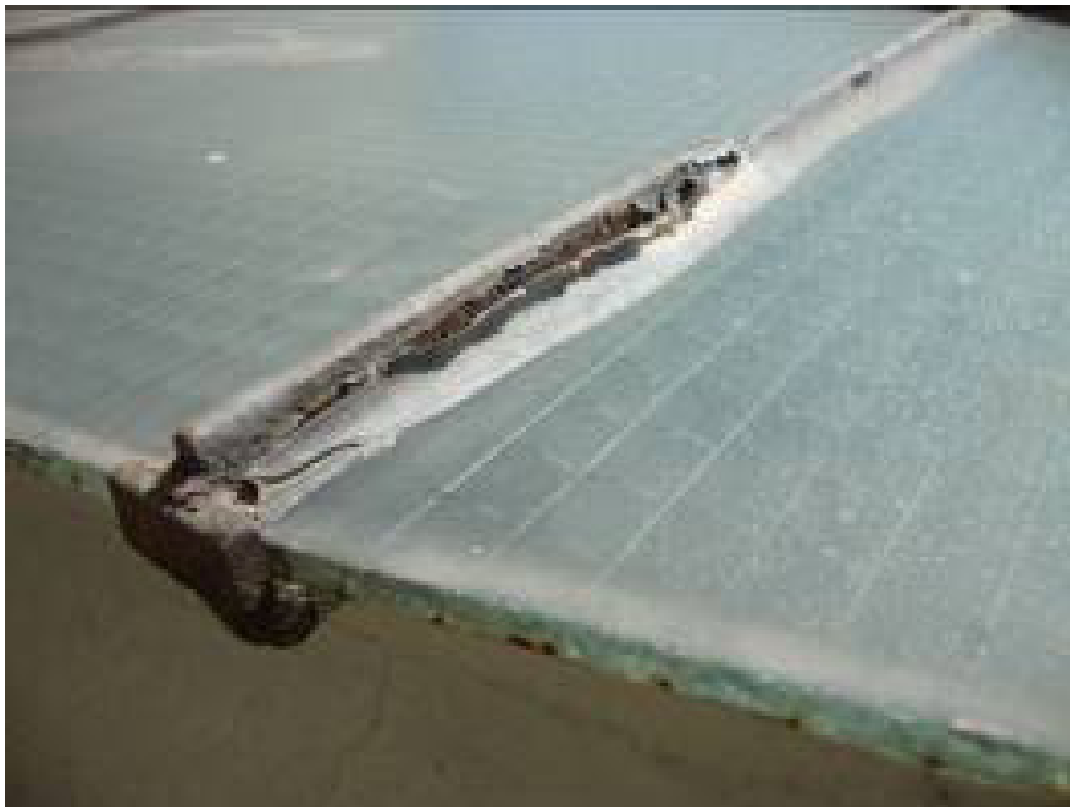
Figura 23 - Detalhe do encontro do perfil metálico e a folha de vidro aramado com desprendimento do material. Fotografia: Arquivo do SEPTC/COMUS.
