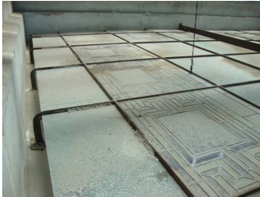
Figura 27 - Conservação: acúmulo de sujidades sobre o vitral. Fotografia: Arquivo do SEPTC/COMUS.
