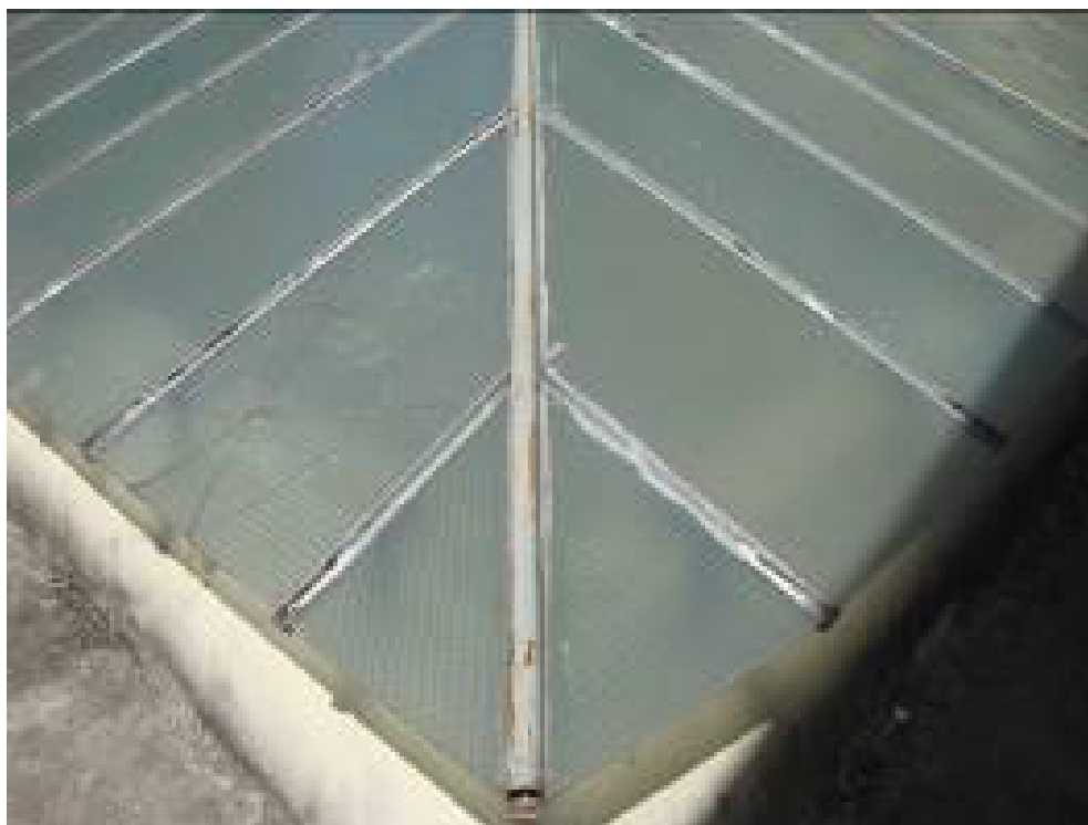
Figura 22 - Peça de vidro quebrada. Fotografia: Arquivo do SEPTC/COMUS.
