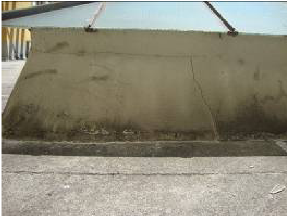
Figura 28 - Fissuras na argamassa. Fotografia: Arquivo do SEPTC/COMUS.
