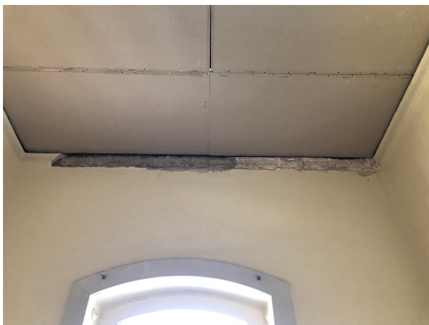
Figura 14 - Área coberta com Dry-wall provisório - vemos lacuna na sanca por desprendimento de material original, possivelmente ocasionado por umidade descendente originada anteriormente às obras de restauração da cobertura do edifício sede do MAST. Fotografia: Ivo Almico, 14/08/2018.
