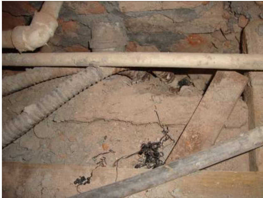
Figura 8 - Detalhe mostrando área deteriorada por insetos xilófagos, além de instalações elétricas e hidráulicas antigas. Fotografia: Ivo Almico, 03/05/2013.
