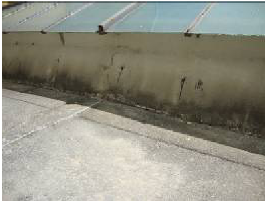
Figura 25 - Fissura entre a gola de alvenaria e a laje do terraço de cobertura do edifício. Fotografia: Arquivo do SEPTC/COMUS.
