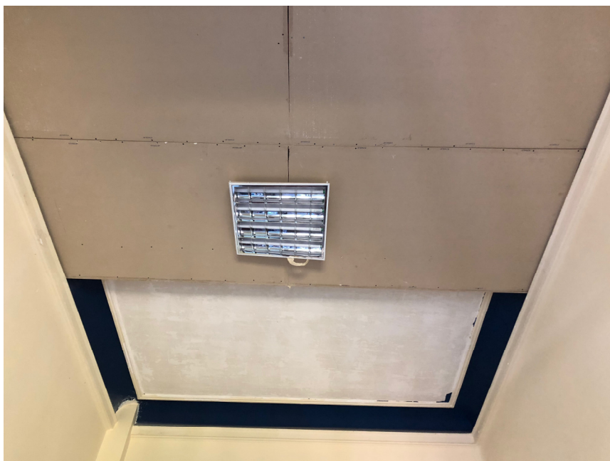
Figura 13 - Área da entrada com forro provisório da sala 2 - onde se vê o teto original, e parte do forro provisório que foi instalado substituindo o trecho do teto que estava com desprendimento, sendo retirado e substituído por dry-wall (provisório). Fotografia: Ivo Almico, 14/08/2018.
