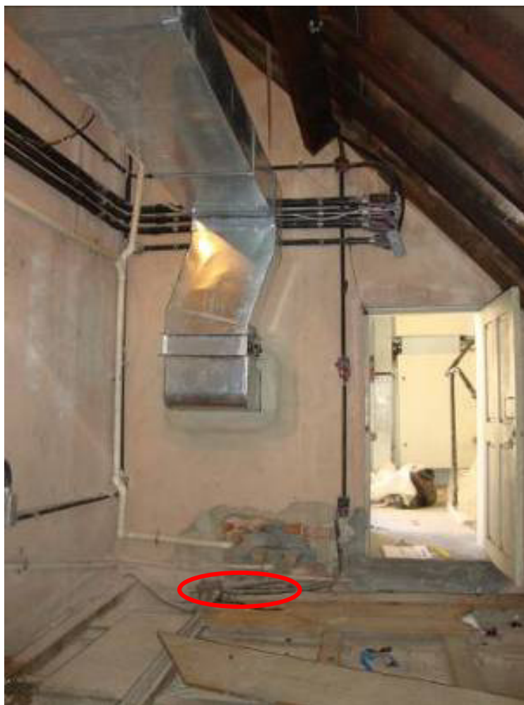
Figura 7 - Vista do interior do desvão sobre a sala 3 - em destaque a área deteriorada por insetos xilófagos. A porta de acesso tem passagem pela escada para a visita de manutenção. Fotografia: Ivo Almico, 03/05/2013.
