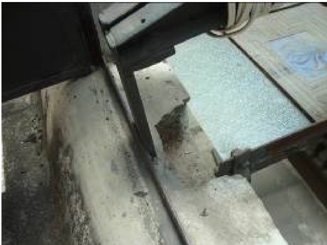
Figura 29 - Lacuna da alvenaria no ponto de fixação da estrutura metálica. Fotografia: Arquivo do SEPTC/COMUS.
