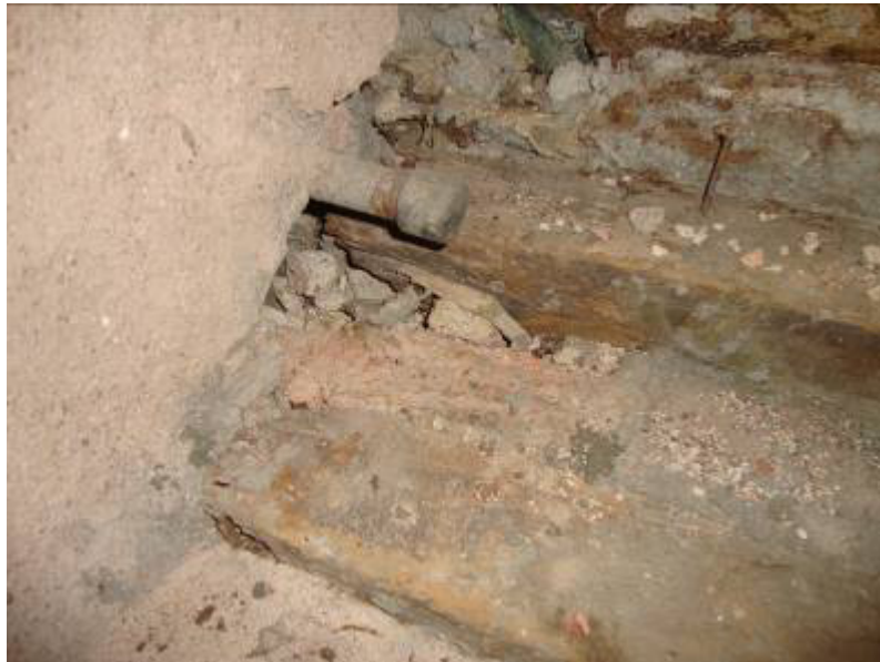
Figura 10 - Argamassa e partes da madeira de estrutura deterioradas e tubulação antiga aparente. Fotografia: Ivo Almico, 13/06/2013.
