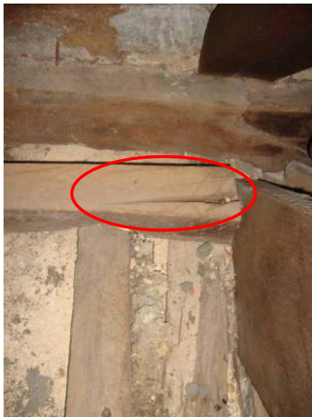
Figura 12 - Trinca aparente em peça de madeira da estrutura. Fotografia: Ivo Almico, 13/06/2013.
