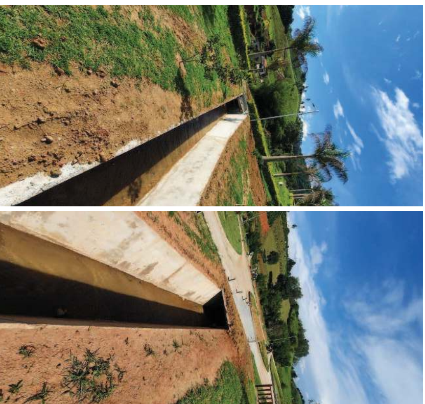
Aduelas de captação de grande volume hídrico pluvial.
