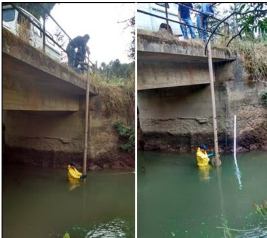
Figura 19 - Instalação dos suportes para os sensores de nível d'água e de turbidez da Estação Fluviométrica SOLAR ML 2000.
