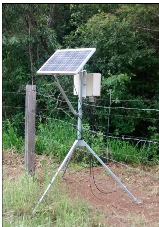
Figura 20 - Instalação definitiva do datalogger da Estação Fluviométrica SOLAR ML 2000.
