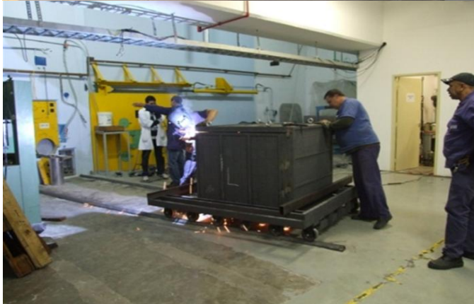
Figura 22. Montagem do beam-catcher nas oficinas do IPEN (cima), e a instalação da blindagem no BH nº14 do Reator Nuclear IEA-R1 (baixo).
