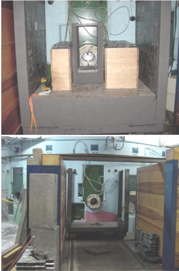
Figura 15 – Reestruturação do canal BH-8 do equipamento de radiografia com nêutrons. Detalhe da saída do feixe de nêutrons e as blindagens laterais de chumbo e de parafina borada e concreto.
