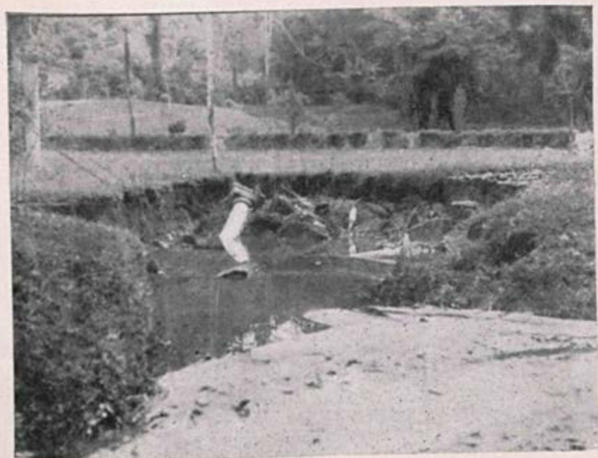
Grande ravina produzida pela enxurrada fez desabar duas columnas da pergola das bougainvilleas. (Photo C. Lacerda).
