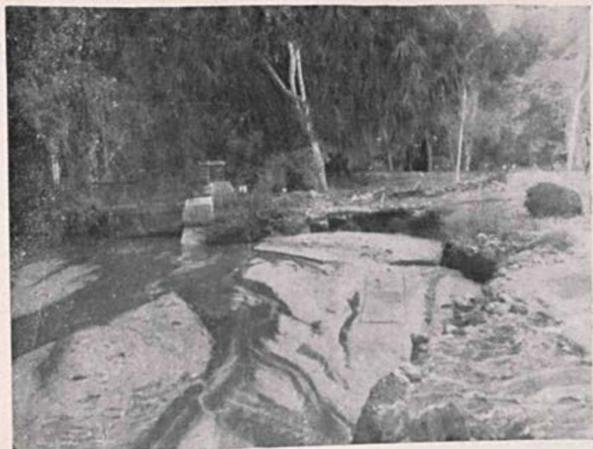
Erosão do leito do rio Macacos destruindo grande trecho de uma rua. (Photo C. Lacerda).
