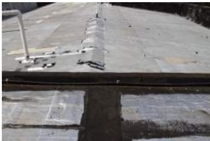
Figura 64. Degradação material pontual com remendos nas telhas e mantas de impermeabilização do Edifício Sede. Imagem: Alba Bispo, mar/2020.
