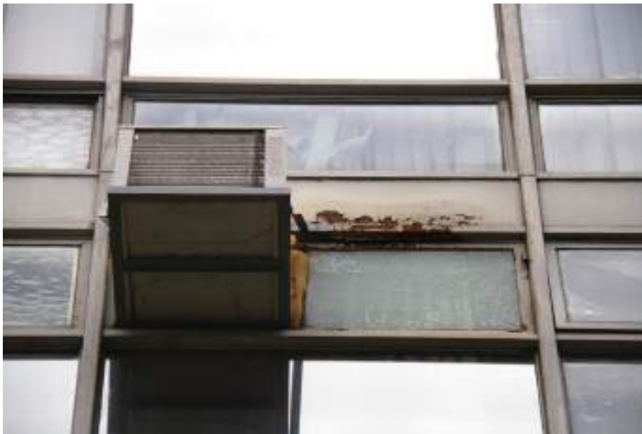
Figura 211. Oxidação e corrosão nas esquadrias da Fachada Leste; esquadrias interseccionadas por unidades aparentes de ar-condicionado. Imagem: Alba Bispo, mar/2020.
