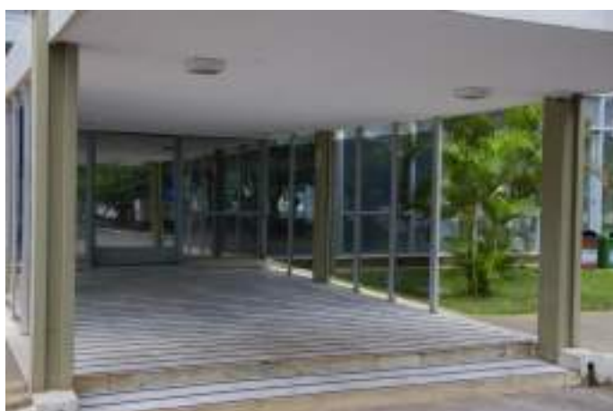
Figura 144. Visão geral do piso da marquise que apresenta fissuras e deformações pontuais com pequeno rebaixo no piso da marquise da entrada privativa em função de movimentações de recalque no Edifício Sede. Imagem: Alba Bispo, mar/2020.
