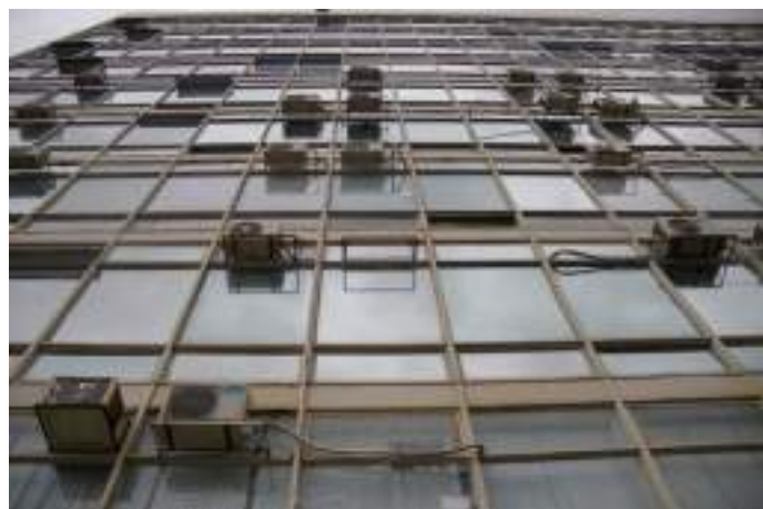
Figura 109. Visão geral da tubulação de coleta para reuso da água derivada das unidades aparentes de ar-condicionado na Fachada Leste do Edifício Sede, incluindo tubos que interseccionam esquadrias e dutos que projetam pingos d'água constantemente na fachada, provocando danos de corrosão nas esquadrias e infiltrações pontuais, com. Imagem: Alba Bispo, mar/2020.
