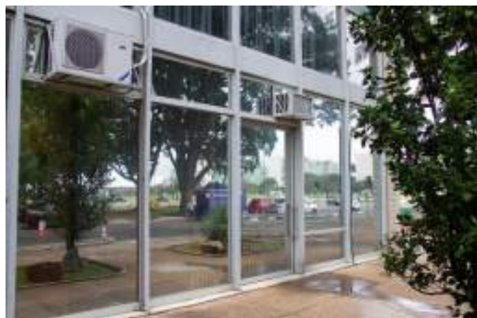
Figura 26. Adição de unidades de ar-condicionado aparentes na Fachada Leste do Edifício Sede, incluindo tubos que interseccionam esquadrias e dutos que projetam pingos d'água constantemente na fachada, provocando danos de corrosão nas esquadrias e infiltrações pontuais. Imagem: Alba Bispo, mar/2020.
