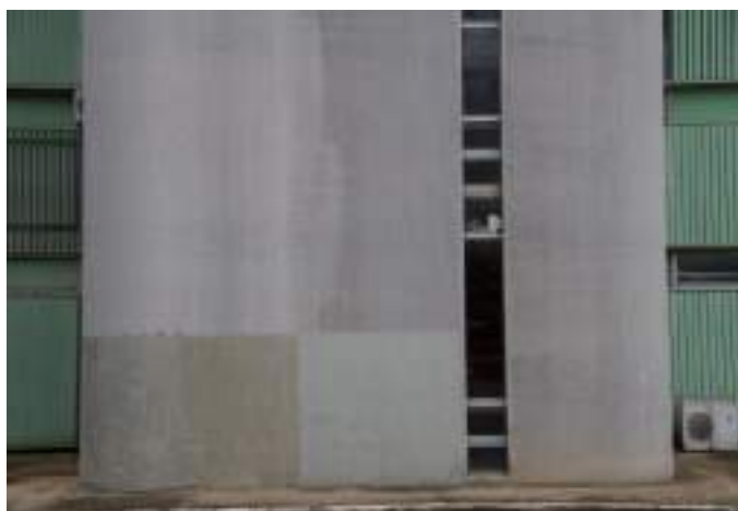
Figura 171. Alterações cromáticas em função de limpeza do concreto aparente das escadas de emergência na Fachada Oeste do Edifício Sede. Imagem: Alba Bispo, mar/2020.
