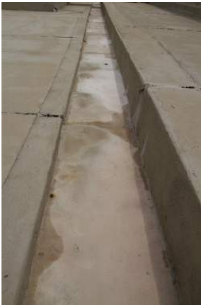
Figura 185. Umidade localizada na área da calha da cobertura do Edifício Sede. Imagem: Alba Bispo, mar/2020.
