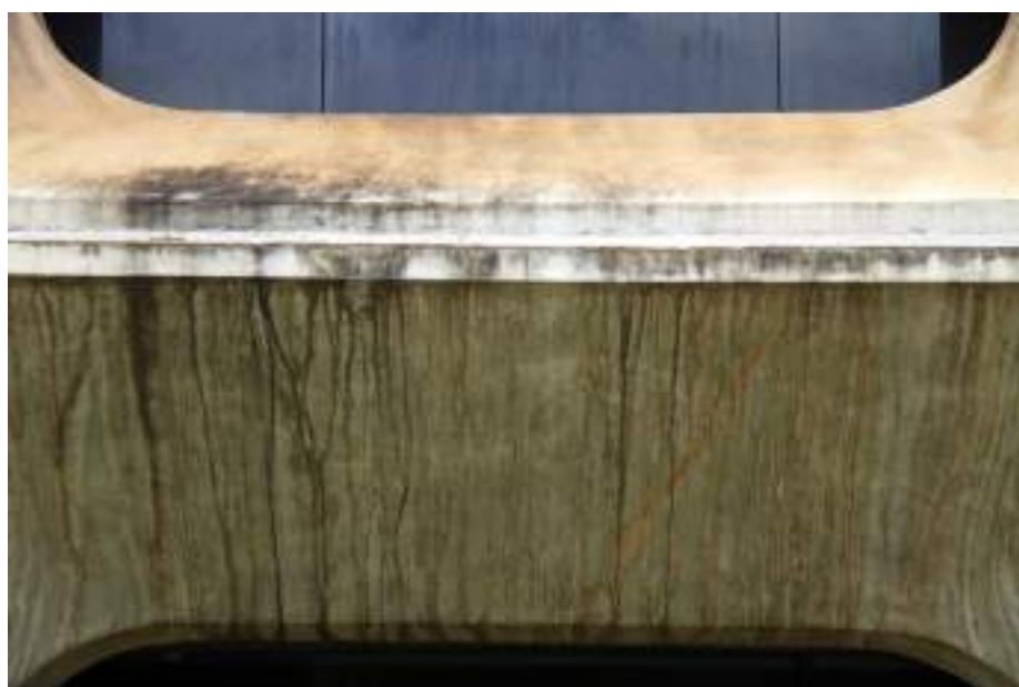
Figura 233. Sujidades e manchas de infiltrações no concreto na Fachada Oeste na área dos jardins internos do Edifício Anexo. Imagem: Alba Bispo, mar/2020.
