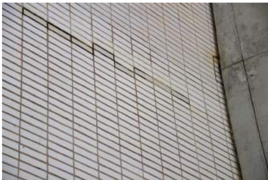
Figura 156. Fissuras pontuais com destacamento do revestimento cerâmico na Fachada Sul do Edifício Sede. Imagem: Alba Bispo, mar/2020.
