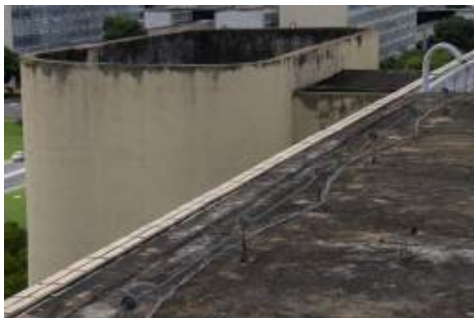
Figura 84. Sujeidades na escada de emergência do Edifício Sede. Imagem: Alba Bispo, mar/2020.
