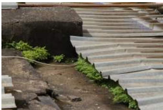
Figura 99. Colonização biológica na cobertura do Edifício Anexo. Imagem: Alba Bispo, mar/2020.
