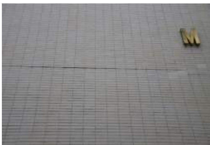
Figura 163. Fissuras entre o térreo e a sobreloja, na Fachada Norte do Edifício Sede. Imagem: Alba Bispo, mar/2020.
