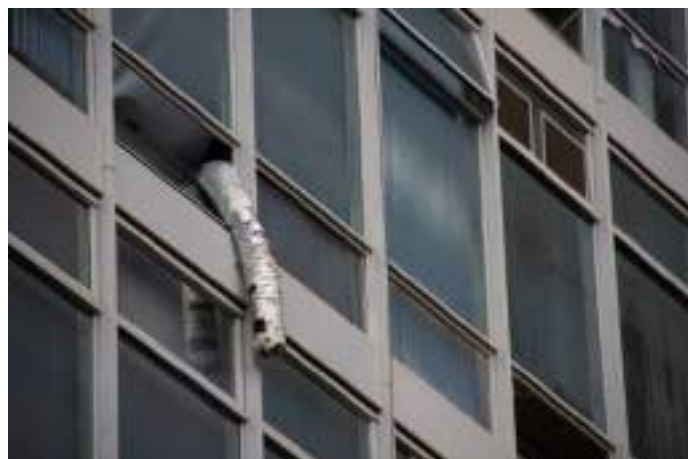
Figura 23. Adição pontual de venezianas em substituição ao vidro e interferências de elementos não pertencentes à construção original, incluindo tubos que interseccionam esquadrias e dutos que projetam pingos d'água constantemente na fachada, provocando danos de corrosão nas esquadrias e infiltrações pontuais na Fachada Leste do Edifício Sede. Imagem: Alba Bispo, mar/2020.
