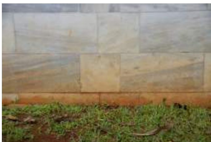
Figura 88. Sujidades pontuais em mármore branco no térreo da fachada do Edifício Anexo. Imagem: Alba Bispo, mar/2020.
