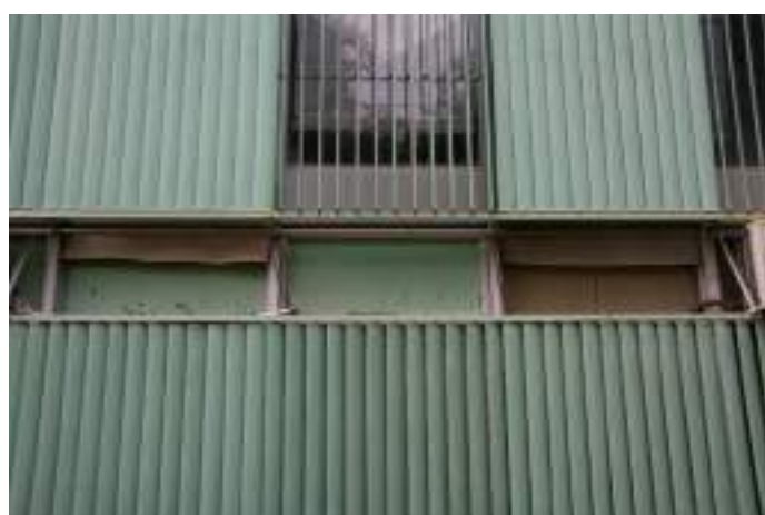
Figura 33. Desgaste de películas; adição de papelões na Fachada Oeste do Edifício Sede. Imagem: Alba Bispo, mar/2020.
