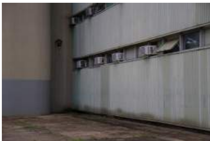
Figura 72. Adição de unidades de ar-condicionado aparentes na Fachada Oeste, incluindo tubos que interseccionam esquadrias e dutos que projetam pingos d'água constantemente na fachada, provocando danos de corrosão nas esquadrias e infiltrações pontuais; sobretudo no térreo; notar umidade localizada nos brises. Imagem: Alba Bispo, mar/2020.
