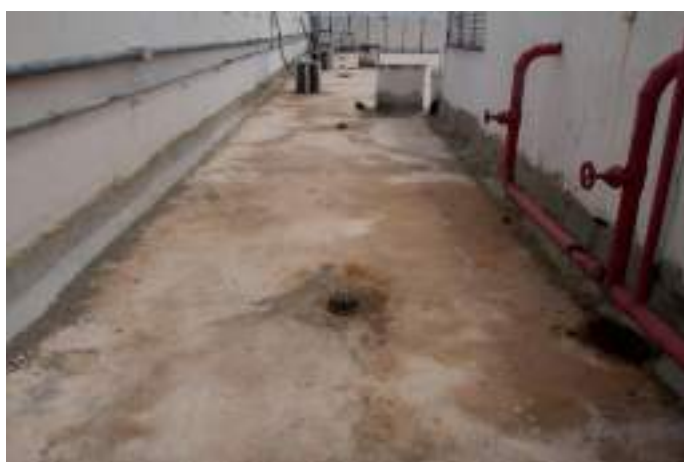
Figura 18. Manchas e sujidades na laje plana impermeabilizada da cobertura e umidade localizada no bloco de caixas d'água do Edifício Sede. Imagem: Alba Bispo, mar/2020.
