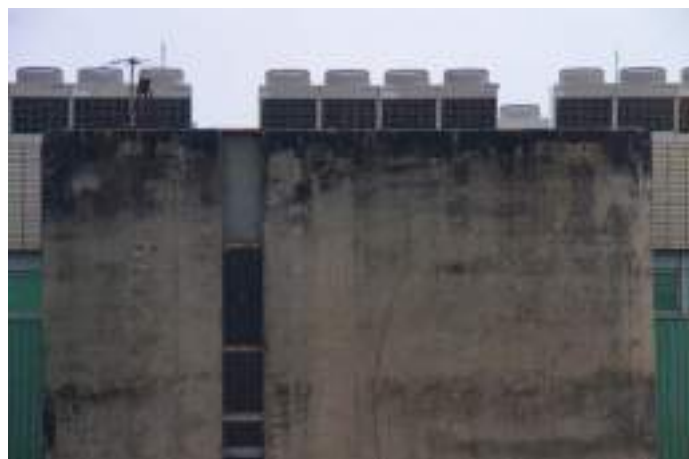
Figura 39. Umidade localizada com sujidades nas escadas de emergência da Fachada Oeste do Edifício Sede; notar oxidação das esquadrias. Imagem: Alba Bispo, mar/2020.
