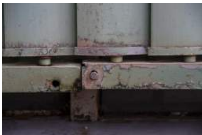
Figura 108. Corrosão metálica pontual, desgastes na pintura dos brises e umidade localizada na Fachada Oeste do Edifício Sede derivada da água das unidades aparentes de ar-condicionado. Imagem: Alba Bispo, mar/2020.
