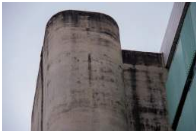
Figura 38. Umidade localizada com sujidades nas escadas de emergência da Fachada Oeste do Edifício Sede. Imagem: Alba Bispo, mar/2020.
