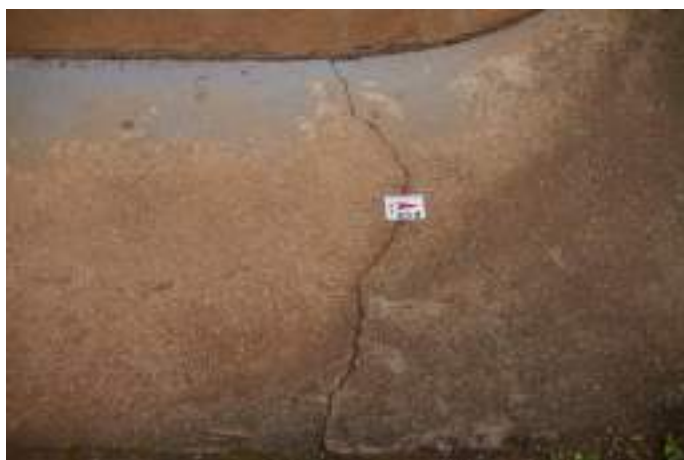
Figura 132. Trinca no passeio da Fachada Oeste, próximo ao volume das escadas de emergência decorrentes de movimentação de recalque no Edifício Sede. Imagem: Alba Bispo, mar/2020.
