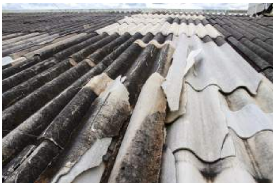
Figura 159. Substituição pontual com remendos e telhas quebradas do Edifício Sede. Imagem: Alba Bispo, mar/2020.
