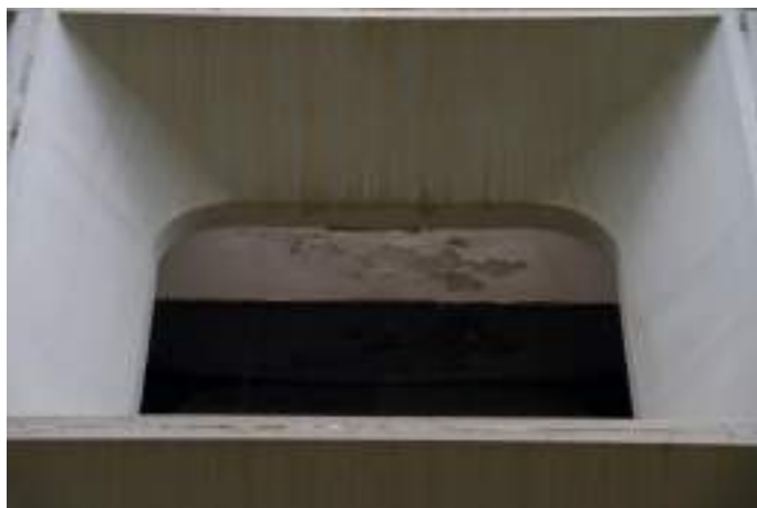
Figura 90. Umidade localizada no teto, infiltrações pontuais, manchas e sujidades no concreto. Imagem: Alba Bispo, mar/2020.
