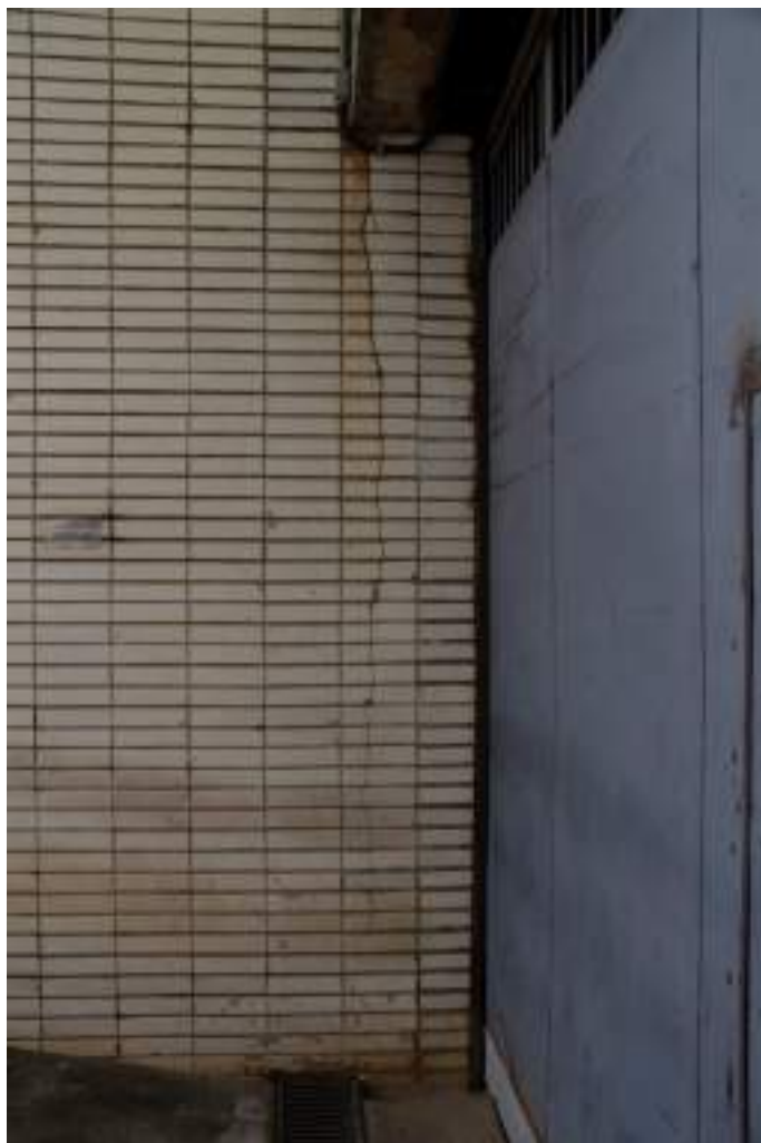
Figura 53. Degradação material com destacamento de placas cerâmicas, umidade localizada, fissuras, trincas e rachaduras na entrada do acesso veicular do Edifício Sede. Imagem: Alba Bispo, mar/2020.
