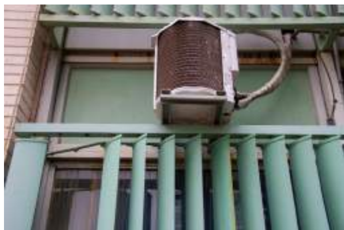
Figura 28. Adição de unidades de ar-condicionado aparentes na Fachada Oeste do Edifício Sede, incluindo tubos que interseccionam esquadrias e dutos que projetam pingos d'água constantemente na fachada, provocando danos de corrosão nas esquadrias e infiltrações pontuais; notar supressão pontual de brises. Imagem: Alba Bispo, mar/2020.
