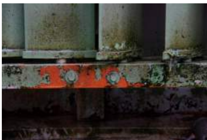
Figura 63. Umidade localizada, sujidades, oxidação e degradação material com desgastes na pintura dos brises, sobretudo no térreo da Fachada Oeste. Imagem: Alba Bispo, mar/2020.
