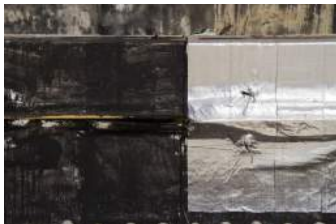
Figura 117. Na cobertura das torres das escadas de emergência do Edifício Sede é possível observar umidade localizada com sujidades e descontinuidade da manta de impermeabilização nas platibandas. Imagem: Alba Bispo, mar/2020.
