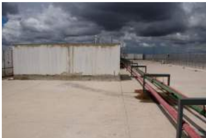
Figura 19. Manchas e sujidades na laje plana impermeabilizada da cobertura e umidade localizada no bloco de caixas d'água do Edifício Sede. Imagem: Alba Bispo, mar/2020.
