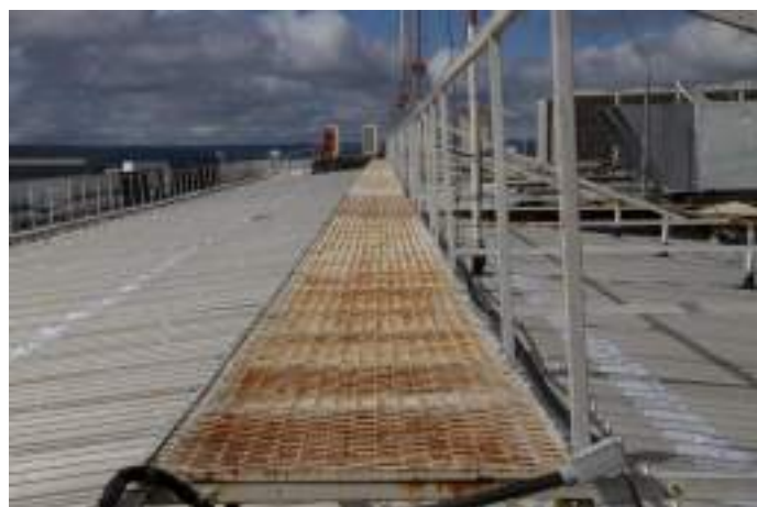
Figura 116. Corrosão metálica pontual da passarela de circulação da cobertura; remendos pontuais nas telhas; descontinuidade da manta de impermeabilização nas platibandas do Edifício Sede. Imagem: Alba Bispo, mar/2020.
