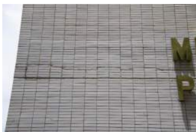
Figura 67. Deformações estruturais, trincas e rachaduras na laje da sobreloja, com destacamento do revestimento cerâmico na Fachada Norte do Edifício Sede. Imagem: Alba Bispo, mar/2020.
