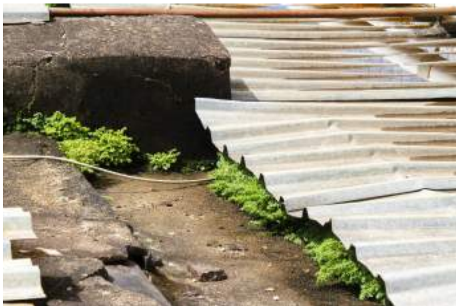
Figura 173. Colonização biológica na cobertura do Edifício Anexo. Imagem: Alba Bispo, mar/2020.
