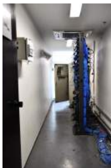
Figura 438. Sala técnica na ala sul do primeiro pavimento.
