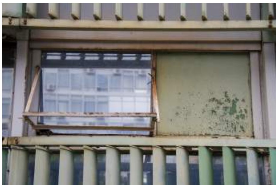
Figura 152. Oxidação de brises e esquadrias na Fachada Oeste do Edifício Sede; películas desgastadas. Imagem: Alba Bispo, mar/2020.
