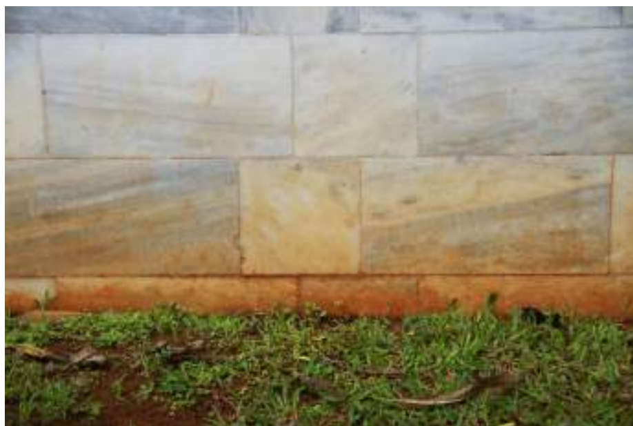
Figura 162. Sujidades pontuais em mármore branco no térreo da fachada do Edifício Anexo. Imagem: Alba Bispo, mar/2020.
