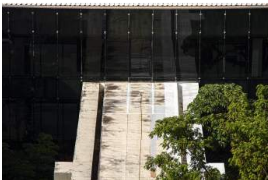
Figura 227. Sujidades e reparos pontuais na impermeabilização da cobertura da passarela de conexão entre o Edifício Sede e o Edifício Anexo. Imagem: Alba Bispo, mar/2020.
