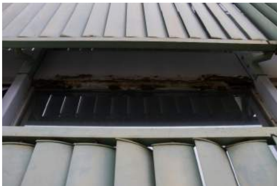
Figura 147. Corrosão metálica em esquadria da Fachada Oeste do Edifício Sede, na área da copa. Imagem: Alba Bispo, mar/2020.
