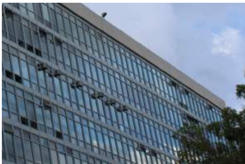
Figura 367. Detalhe dos volumes externos dos aparelhos de ar condicionado, na fachada leste do bloco B.
