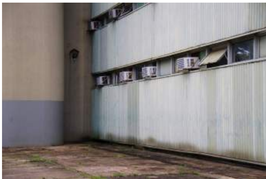
Figura 146. Adição de unidades de ar-condicionado aparentes na Fachada Oeste, incluindo tubos que interseccionam esquadrias e dutos que projetam pingos d'água constantemente na fachada, provocando danos de corrosão nas esquadrias e infiltrações pontuais; sobretudo no térreo; notar umidade localizada nos brises. Imagem: Alba Bispo, mar/2020.
