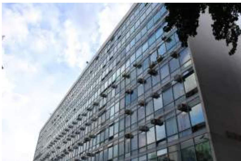
Figura 573. Detalhe dos volumes externos dos aparelhos de ar condicionado, na fachada leste do bloco F.
