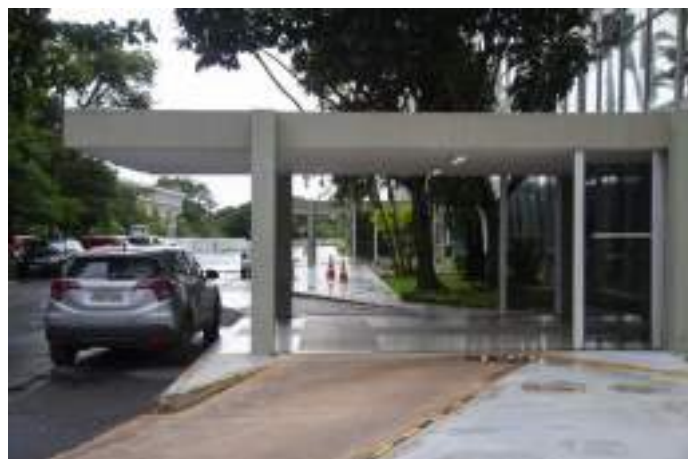
Figura 114. Ausência de esquadria de vidro na marquise da entrada privativa do Edifício Sede, com pavimentação da área ajardinada para acesso veicular, diferente dos demais blocos. Imagem: Alba Bispo, mar/2020.
