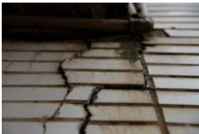
Figura 52. Detalhe do destacamento de placas cerâmicas na entrada do acesso veicular do Edifício Sede. Imagem: Alba Bispo, mar/2020.
