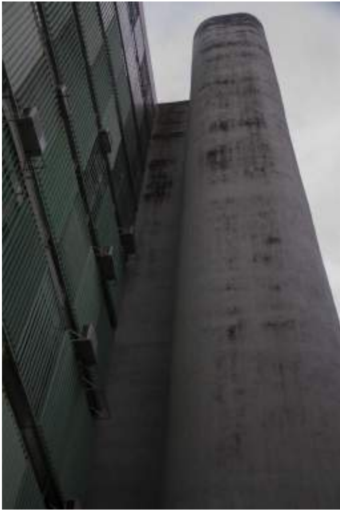
Figura 101. Umidade localizada, com sujidades nas escadas de emergência da Fachada Oeste do Edifício Sede. Imagem: Alba Bispo, mar/2020.
