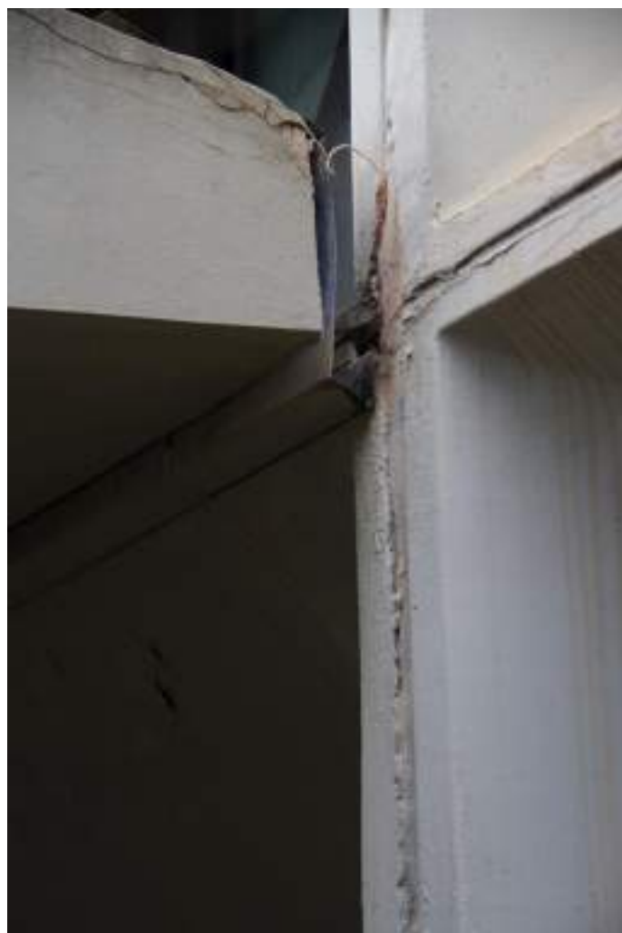
Figura 94. Movimentação da marquise de entrada da Fachada Oeste do Edifício Anexo. Imagem: Alba Bispo, mar/2020.
