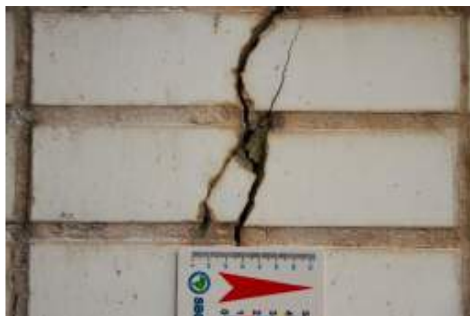
Figura 54. Detalhe das fissuras, trincas e rachaduras na entrada do acesso veicular do Edifício Sede. Imagem: Alba Bispo, mar/2020.
