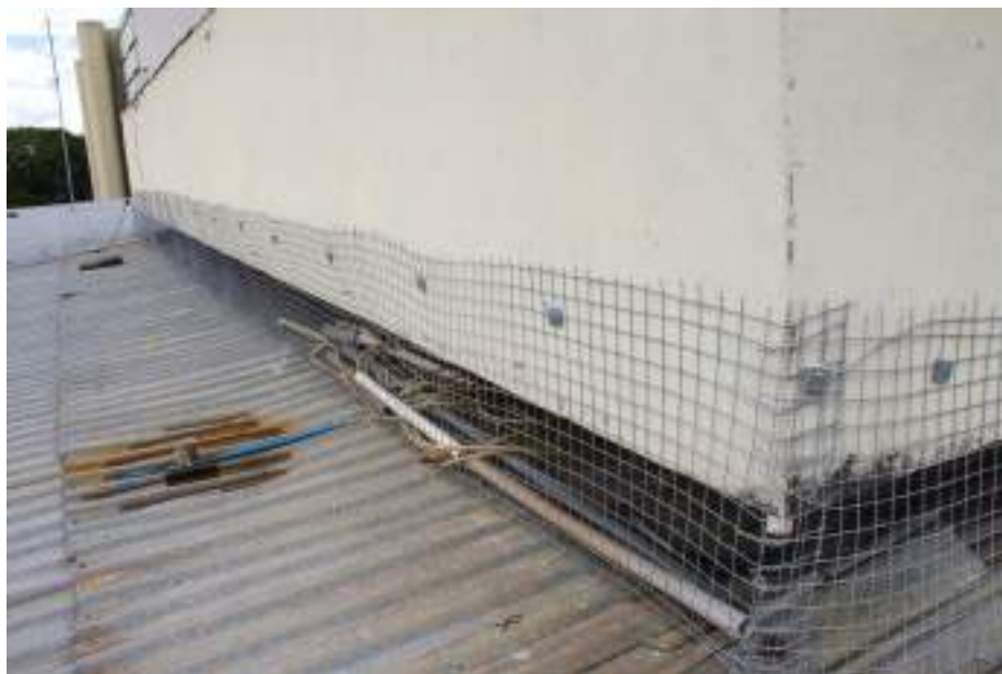
Figura 172. Deformação pontual das telhas da cobertura com acúmulo de água; adição de telas metálicas para evitar a entrada de pombos no volume de acesso à cobertura do Edifício Anexo. Imagem: Alba Bispo, mar/2020.
