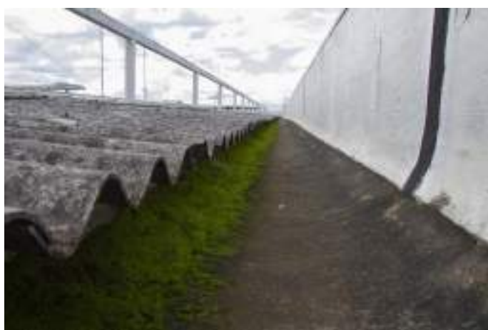
Figura 86. Colonização biológica nas calhas da cobertura do Edifício Sede. Imagem: Alba Bispo, mar/2020.
