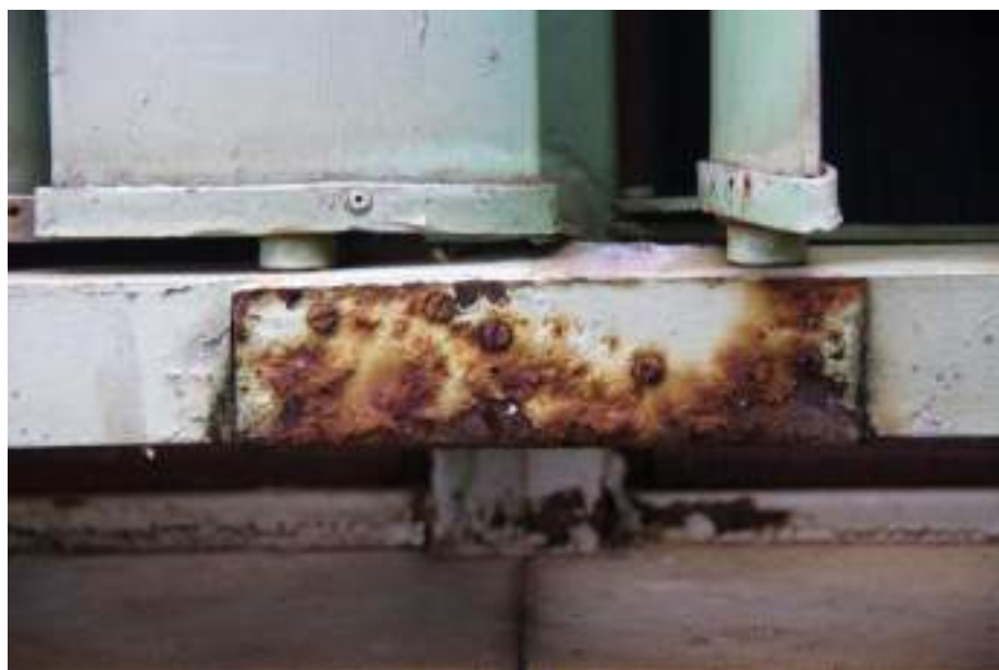
Figura 201. Corrosão metálica dos brises. Imagem: Alba Bispo, mar/2020.
