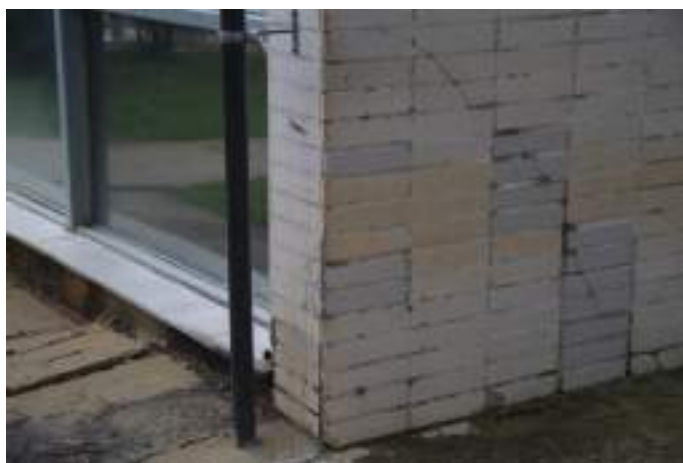
Figura 120. Trinca na Fachada Norte em função de movimentações de recalque no Edifício Sede. Imagem: Alba Bispo, mar/2020.
