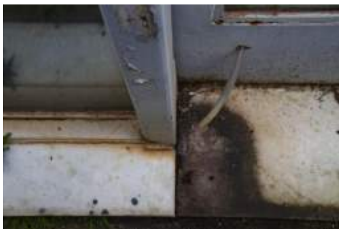
Figura 139. Intersecção de duto de ar-condicionado em esquadria com oxidação na Fachada Leste do Edifício Sede; manchas e sujidades no mármore branco do térreo. Imagem: Alba Bispo, mar/2020.
