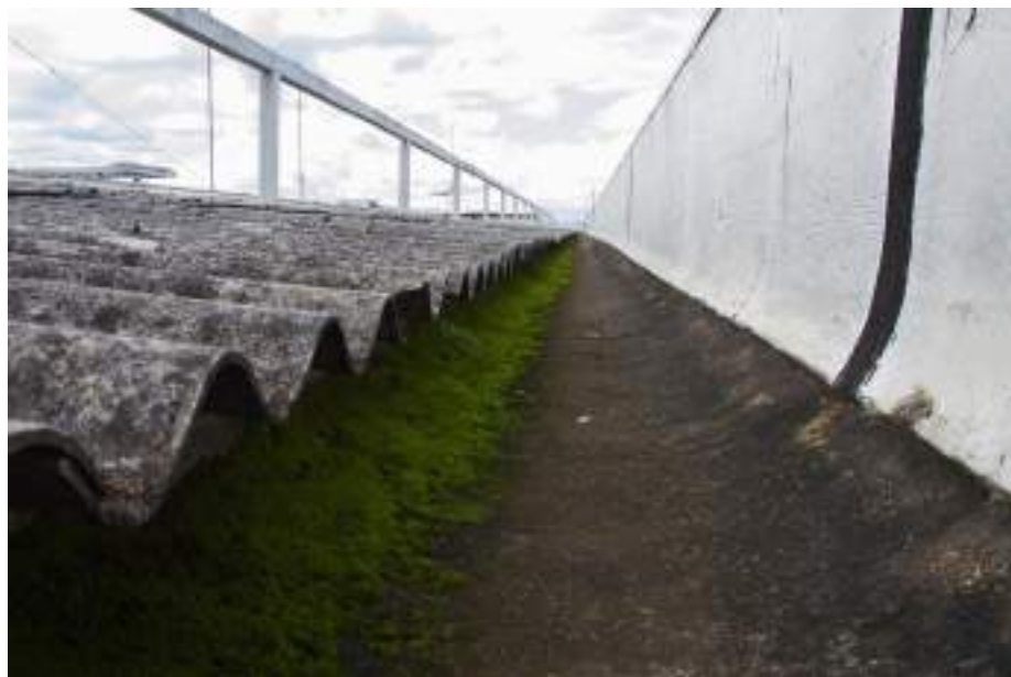
Figura 160. Colonização biológica nas calhas da cobertura do Edifício Sede. Imagem: Alba Bispo, mar/2020.
