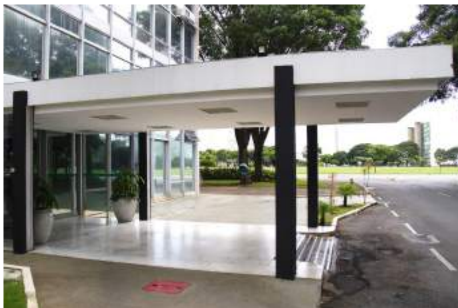
Figura 144. Ausência de esquadria de vidro na marquise da entrada privativa do Edifício Sede, com pavimentação da área ajardinada para acesso veicular, diferente dos demais blocos. Imagem: Alba Bispo, mar/2020.
