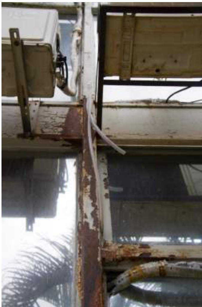
Figura 177. Oxidação e corrosão nas esquadrias da Fachada Leste; esquadrias interseccionadas por dutos de unidades aparentes de ar-condicionado. Imagem: Alba Bispo, mar/2020.
