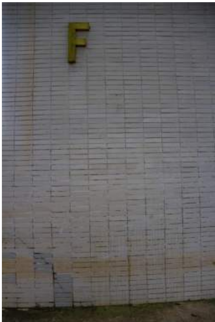
Figura 121. Trinca na Fachada Norte em função de movimentações de recalque no Edifício Sede. Imagem: Alba Bispo, mar/2020.
