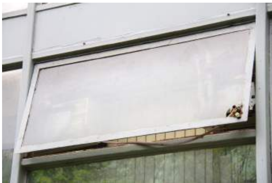
Figura 216. Adição de duto de ar-condicionado através de intersecção do vidro da esquadria na Fachada Leste do Edifício Sede. Imagem: Alba Bispo, mar/2020.
