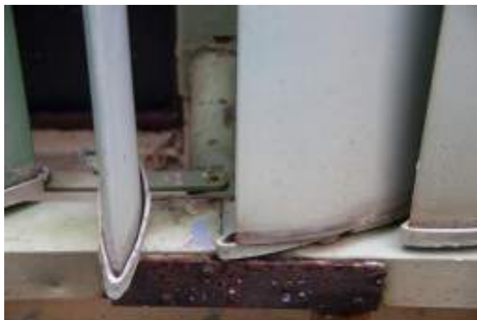
Figura 125. Corrosão metálica dos brises. Imagem: Alba Bispo, mar/2020.
