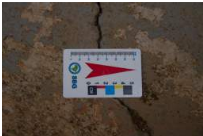
Figura 133. Trinca no passeio da Fachada Oeste, próximo ao volume das escadas de emergência decorrentes de movimentação de recalque no Edifício Sede. Imagem: Alba Bispo, mar/2020.
