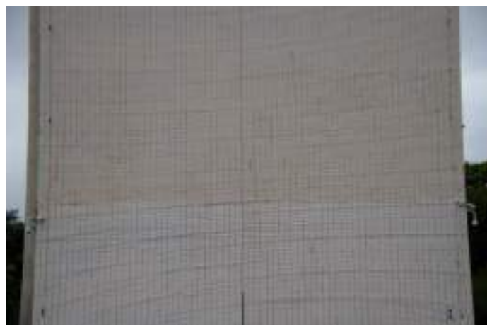
Figura 44. Alteração cromática no revestimento cerâmico da Fachada Sul do Edifício Sede. Imagem: Alba Bispo, mar/2020.
