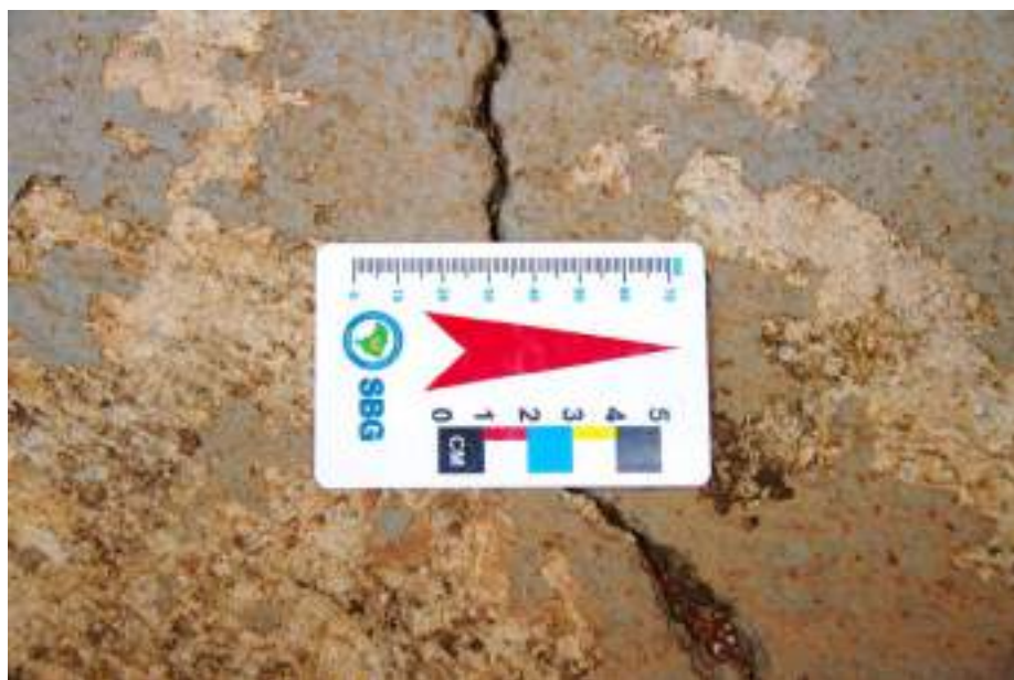
Figura 207. Trinca no passeio da Fachada Oeste, próximo ao volume das escadas de emergência decorrentes de movimentação de recalque no Edifício Sede. Imagem: Alba Bispo, mar/2020.
