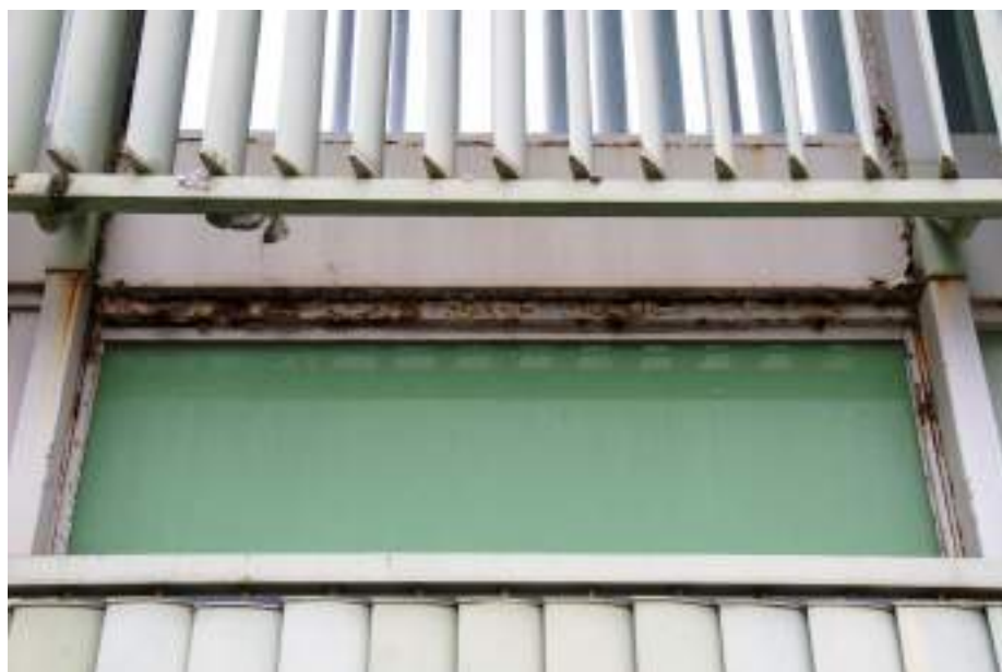
Figura 153. Oxidação de brises e esquadrias na Fachada Oeste do Edifício Sede. Imagem: Alba Bispo, mar/2020.
