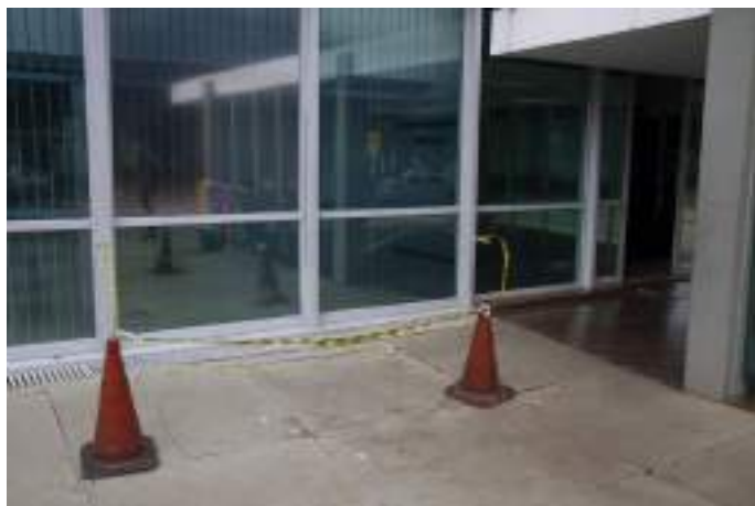
Figura 6. Trincas pontuais no pavimento do passeio junto à Fachada Leste do Edifício Sede. Imagem: Alba Bispo, mar/2020.
