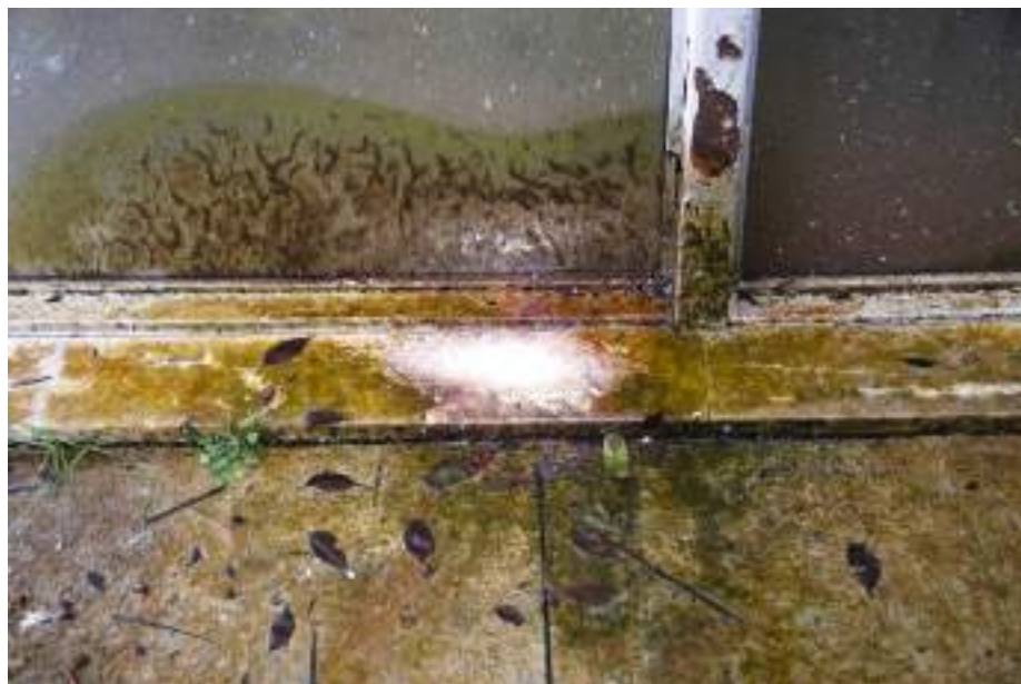
Figura 214. Manchas e sujidades no mármore branco, sobretudo no térreo, derivadas dos pingos de água das unidades de ar-condicionado aparentes na fachada que provocam oxidação e corrosão de esquadrias, sobretudo no térreo. Imagem: Alba Bispo, mar/2020.
