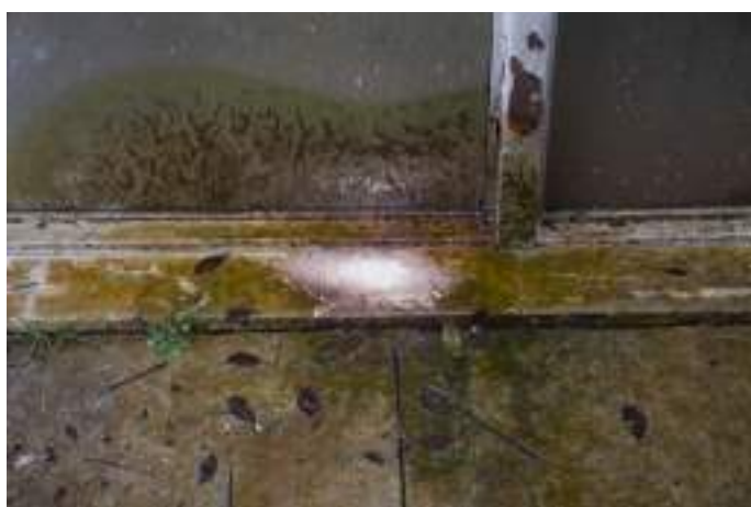
Figura 140. Manchas e sujidades no mármore branco, sobretudo no térreo, derivadas dos pingos de água das unidades de ar-condicionado aparentes na fachada que provocam oxidação e corrosão de esquadrias, sobretudo no térreo. Imagem: Alba Bispo, mar/2020.
