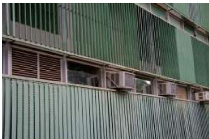
Figura 31. Variedade cromática de películas; adição pontual de venezianas em substituição ao vidro, papelões e unidades de ar-condicionado aparentes na Fachada Oeste do Edifício Sede. Imagem: Alba Bispo, mar/2020.
