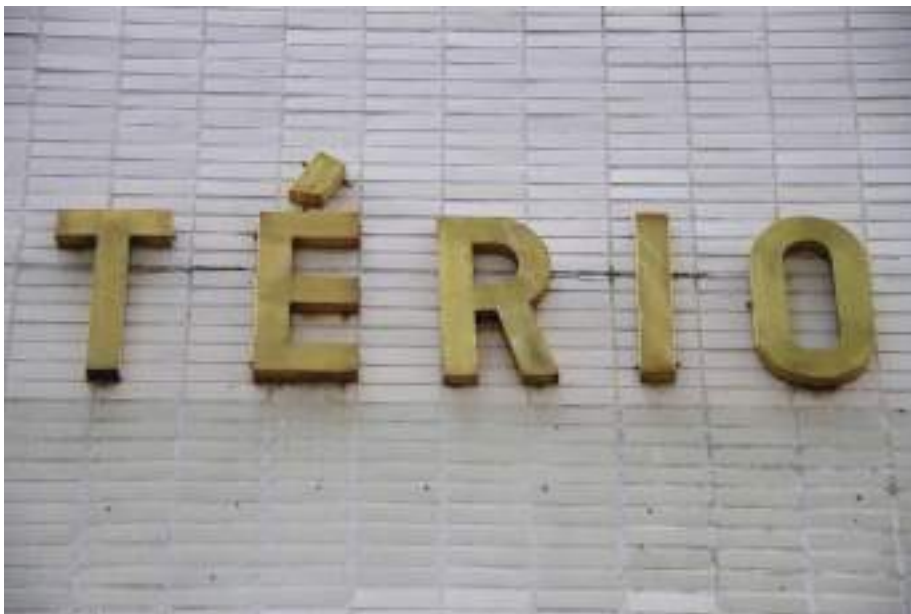
Figura 193. Fissuras abaixo do letreiro em função de movimentações na laje da sobreloja, com destacamento do revestimento cerâmico na Fachada Norte do Edifício Sede. Imagem: Alba Bispo, mar/2020.
