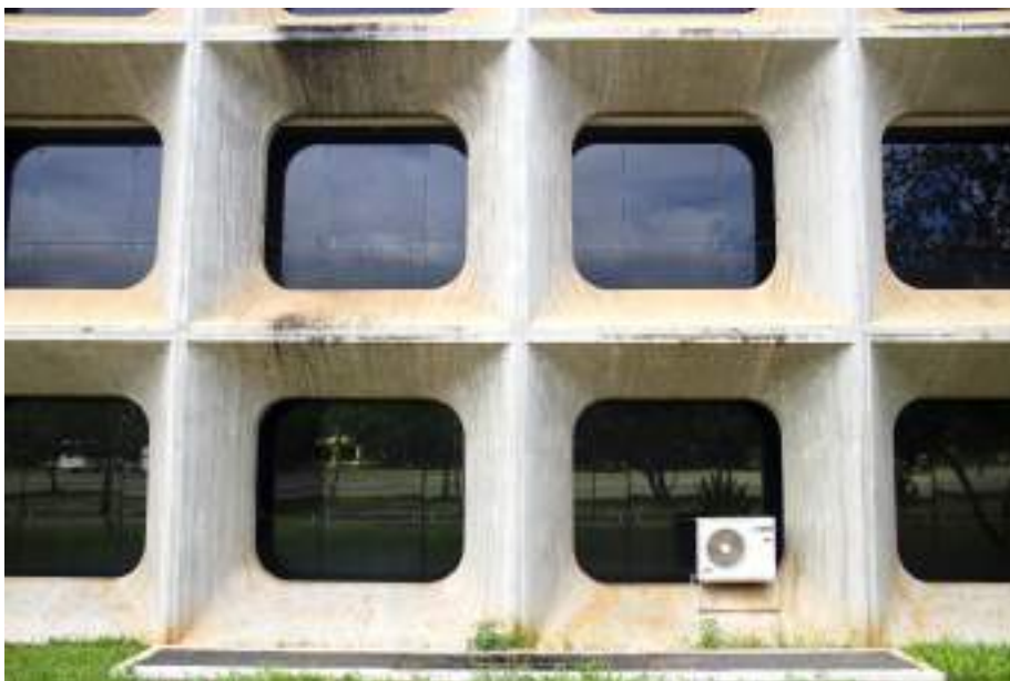
Figura 229. Sujidades no concreto aparente no térreo do Edifício Anexo; dano estético provocado por instalação de unidade aparente de ar-condicionado na fachada. Imagem: Alba Bispo, mar/2020.
