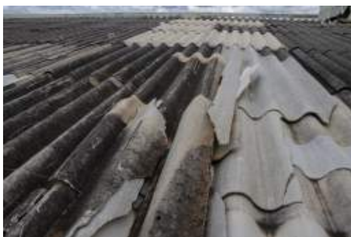
Figura 85. Substituição pontual com remendos e telhas quebradas do Edifício Sede. Imagem: Alba Bispo, mar/2020.
