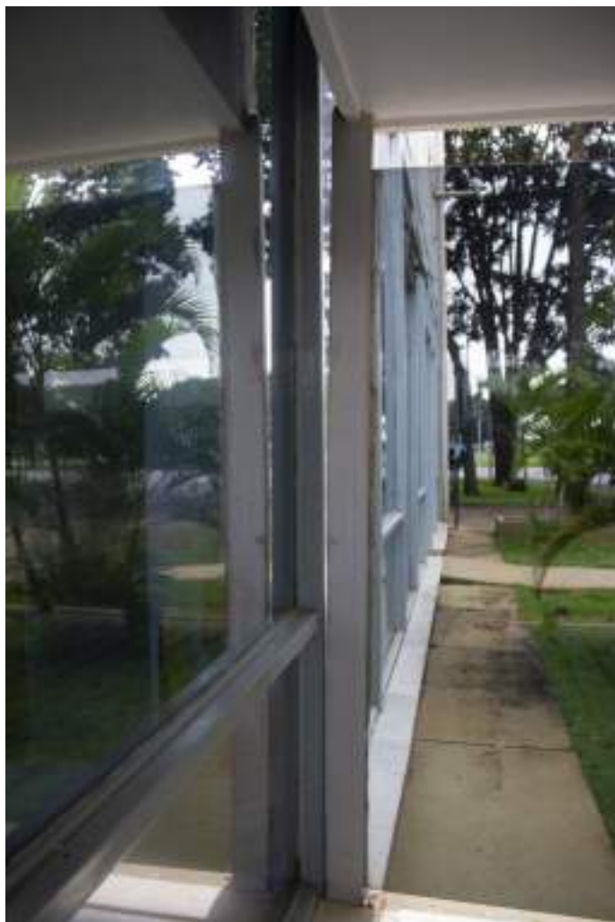
Figura 147. Desaprumo da marquise da entrada privativa em função de movimentações de recalque no Edifício Sede. Imagem: Alba Bispo, mar/2020.
