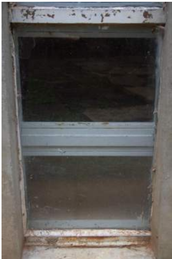
Figura 135. Oxidação em esquadria na torre das escadas de emergência do Edifício Sede. Imagem: Alba Bispo, mar/2020.
