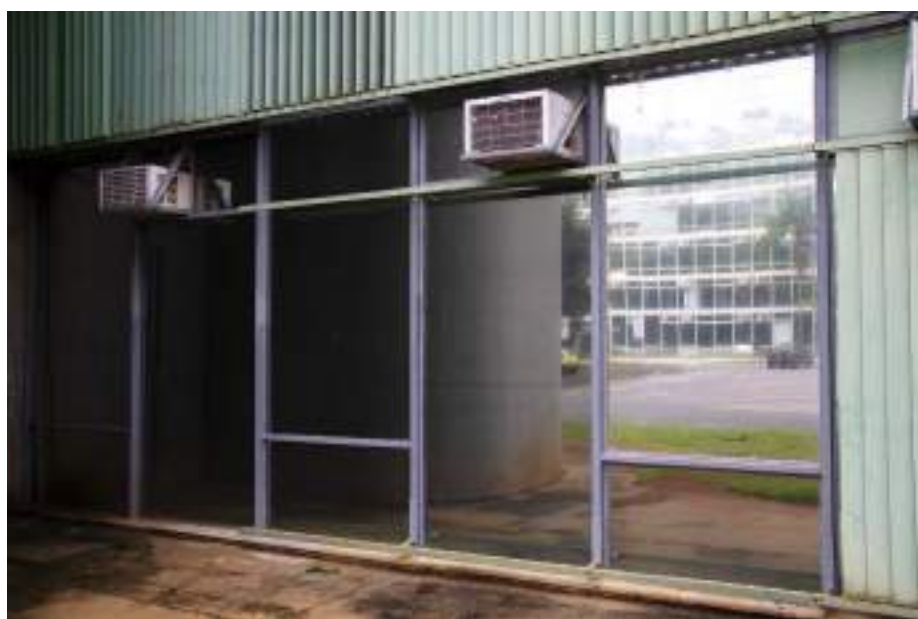
Figura 205. Supressão parcial de brises da Fachada Oeste do Edifício Sede; infiltrações no piso e na parede derivadas dos dutos de ar-condicionado aparentes. Imagem: Alba Bispo, mar/2020.
