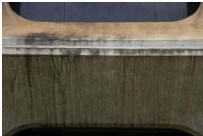
Figura 159. Sujidades e manchas de infiltrações no concreto na Fachada Oeste na área dos jardins internos do Edifício Anexo. Imagem: Alba Bispo, mar/2020.
