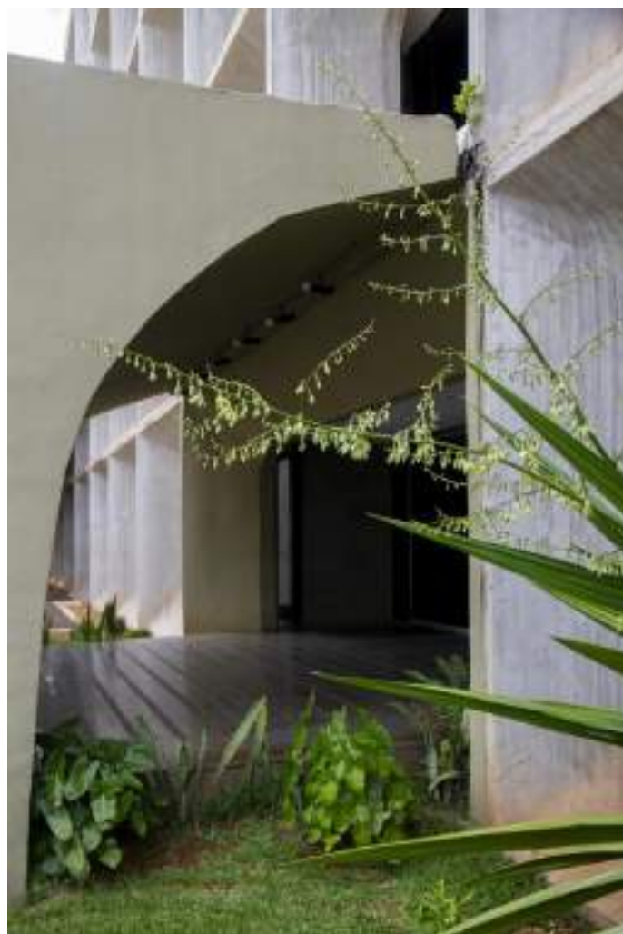
Figura 158. Movimentação da marquise de entrada da Fachada Oeste do Edifício Anexo. Imagem: Alba Bispo, mar/2020.
