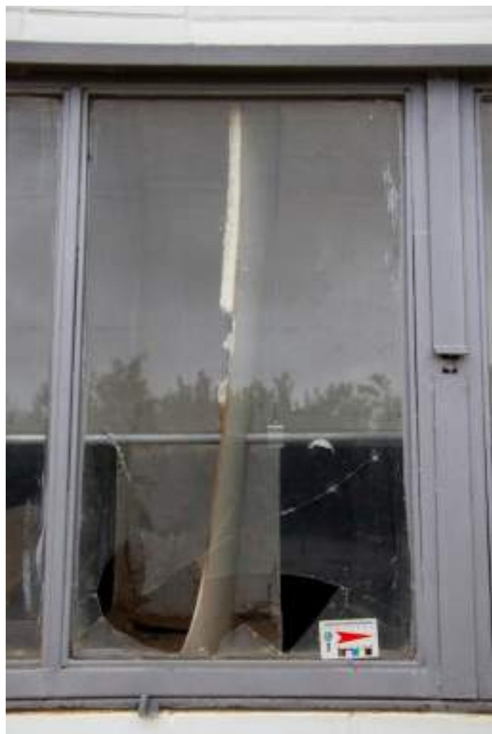
Figura 37. Vidro quebrado em esquadria na Fachada Sul, no subsolo, próximo à entrada de carga e descarga do Edifício Sede. Imagem: Alba Bispo, mar/2020.
