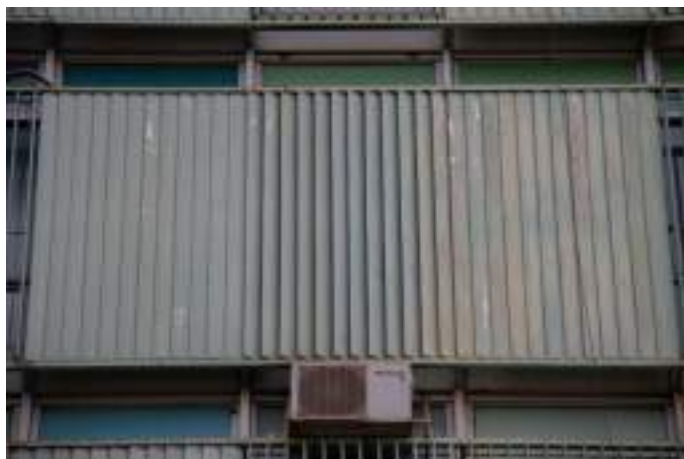
Figura 61. Diversidade cromática de películas de proteção; degradação material com descascamento da pintura dos brises. Imagem: Alba Bispo, mar/2020.
