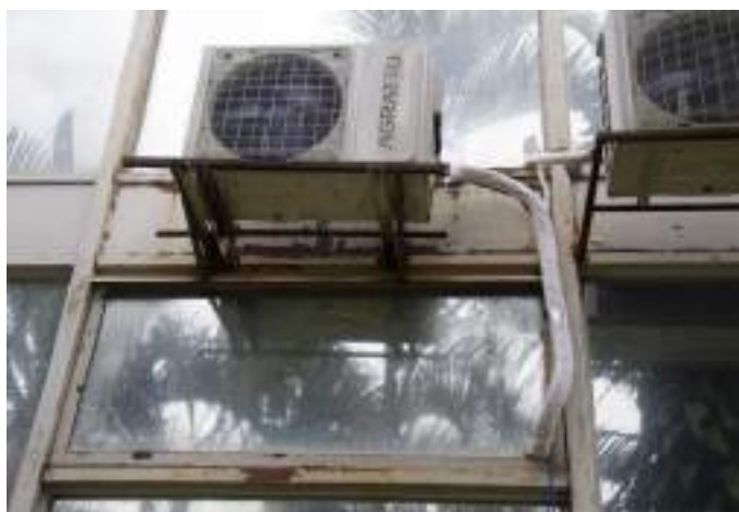
Figura 178. Oxidação e corrosão nas esquadrias da Fachada Leste; esquadrias interseccionadas por dutos de unidades aparentes de ar-condicionado. Imagem: Alba Bispo, mar/2020.
