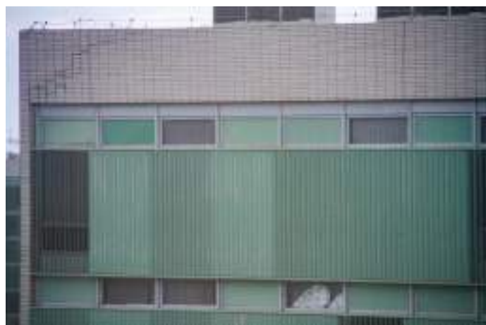
Figura 41. Trincas na platibanda, na extremidade da Fachada Oeste do Edifício Sede. Imagem: Alba Bispo, mar/2020.
