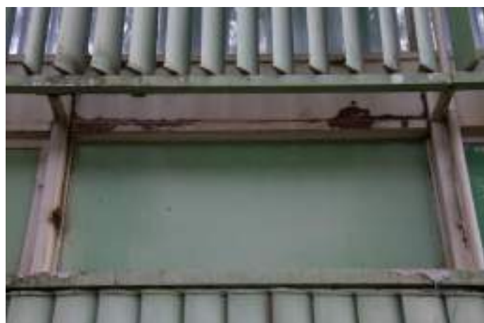
Figura 107. Oxidação e corrosão nas esquadrias da Fachada Oeste do Edifício Sede; desgastes na pintura dos brises. Imagem: Alba Bispo, mar/2020.
