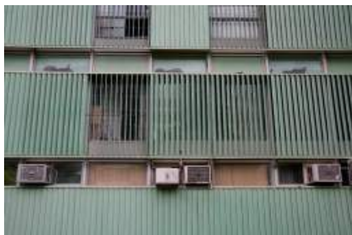
Figura 32. Desgaste de películas; adição de papelões e unidades de ar-condicionado aparentes na Fachada Oeste do Edifício Sede. Imagem: Alba Bispo, mar/2020.
