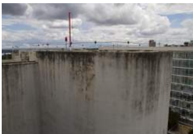
Figura 172. Umidade localizada, com sujidades nas escadas de emergência da Fachada Oeste do Edifício Sede. Imagem: Alba Bispo, mar/2020.
