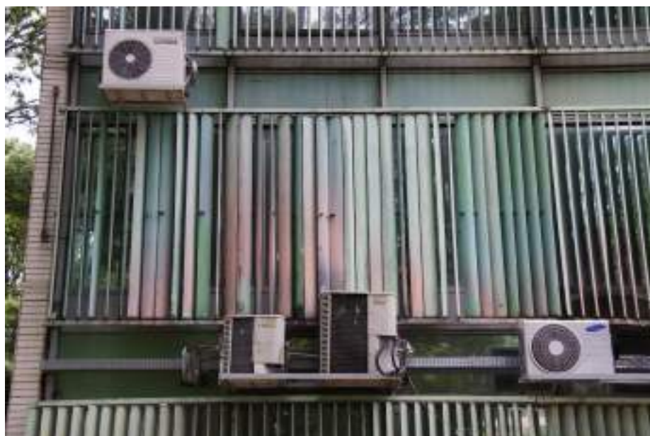
Figura 149. Alterações cromáticas nos brises em função de incêndio ocorrido na área do auditório; unidades aparentes de ar-condicionado na Fachada Oeste do Edifício Sede. Imagem: Alba Bispo, mar/2020.
