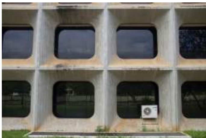
Figura 155. Sujeidades no concreto aparente no térreo do Edifício Anexo; dano estético provocado por instalação de unidade aparente de ar-condicionado na fachada. Imagem: Alba Bispo, mar/2020.
