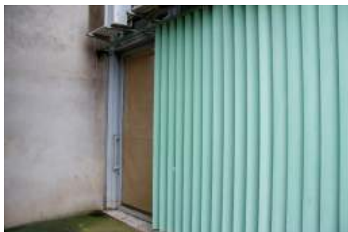
Figura 30. Supressão pontual de brises na Fachada Oeste do Edifício Sede; notar umidade localizada derivada das unidades de ar-condicionado aparentes. Imagem: Alba Bispo, mar/2020.
