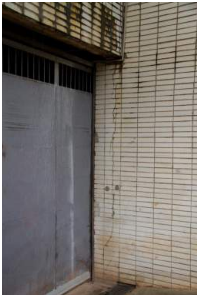
Figura 51. Degradação material com destacamento de placas cerâmicas, umidade localizada, fissuras, trincas e rachaduras na entrada do acesso veicular do Edifício Sede. Imagem: Alba Bispo, mar/2020.
