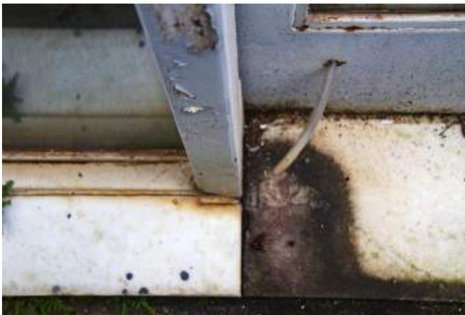
Figura 213. Intersecção de duto de ar-condicionado em esquadria com oxidação na Fachada Leste do Edifício Sede; manchas e sujidades no mármore branco do térreo. Imagem: Alba Bispo, mar/2020.
