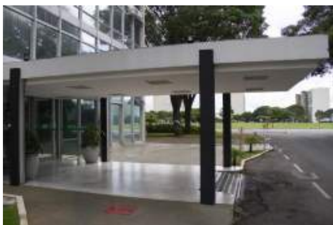
Figura 70. Ausência de esquadria de vidro na marquise da entrada privativa do Edifício Sede, com pavimentação da área ajardinada para acesso veicular, diferente dos demais blocos. Imagem: Alba Bispo, mar/2020.
