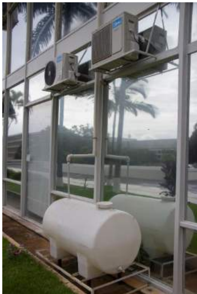
Figura 112. Adição de unidades de ar-condicionado aparentes na Fachada Leste do Edifício Sede; notar depósito de água dos dutos que está sendo direcionada para coleta e reuso. Imagem: Alba Bispo, mar/2020.
