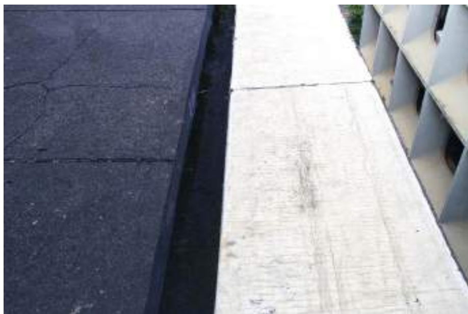
Figura 169. Umidade localizada e pequena incidência de fissuras na cobertura da passarela de ligação para o Edifício Anexo. Imagem: Alba Bispo, mar/2020.
