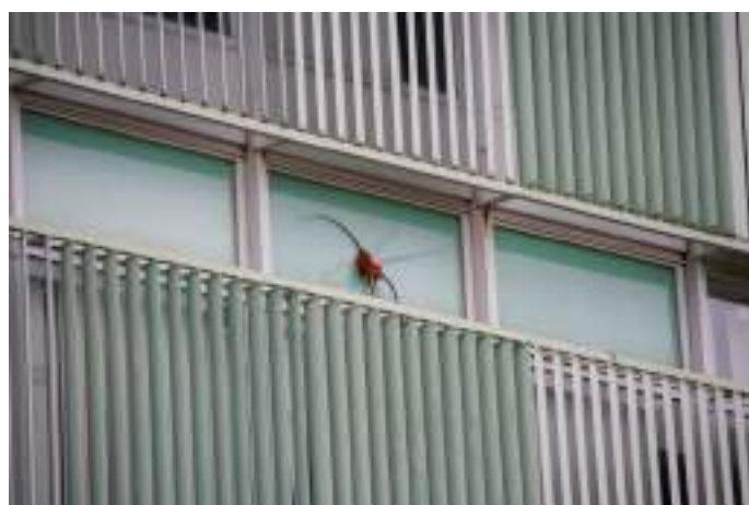
Figura 11. Vidro trincado na Fachada Oeste do Edifício Sede. Imagem: Alba Bispo, mar/2020.
