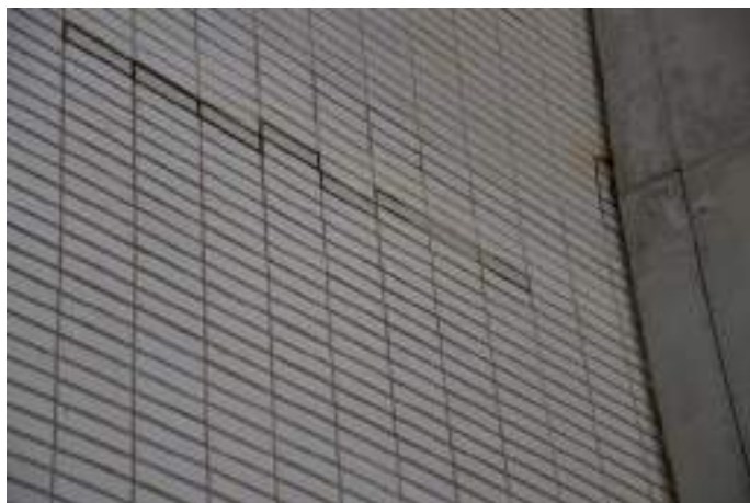
Figura 82. Fissuras pontuais com destacamento do revestimento cerâmico na Fachada Sul do Edifício Sede. Imagem: Alba Bispo, mar/2020.
