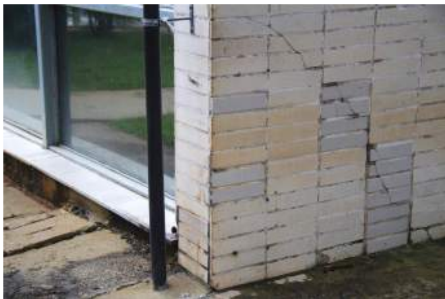
Figura 194. Trinca na Fachada Norte em função de movimentações de recalque no Edifício Sede. Imagem: Alba Bispo, mar/2020.
