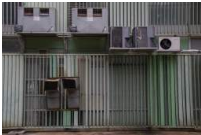
Figura 74. Interferências de elementos não pertencentes à construção original ou espúrios, tais como dutos de exaustão e unidades aparentes de ar-condicionado na Fachada Oeste do Edifício Sede; unidade localizada nos brises, sobretudo no térreo. Imagem: Alba Bispo, mar/2020.
