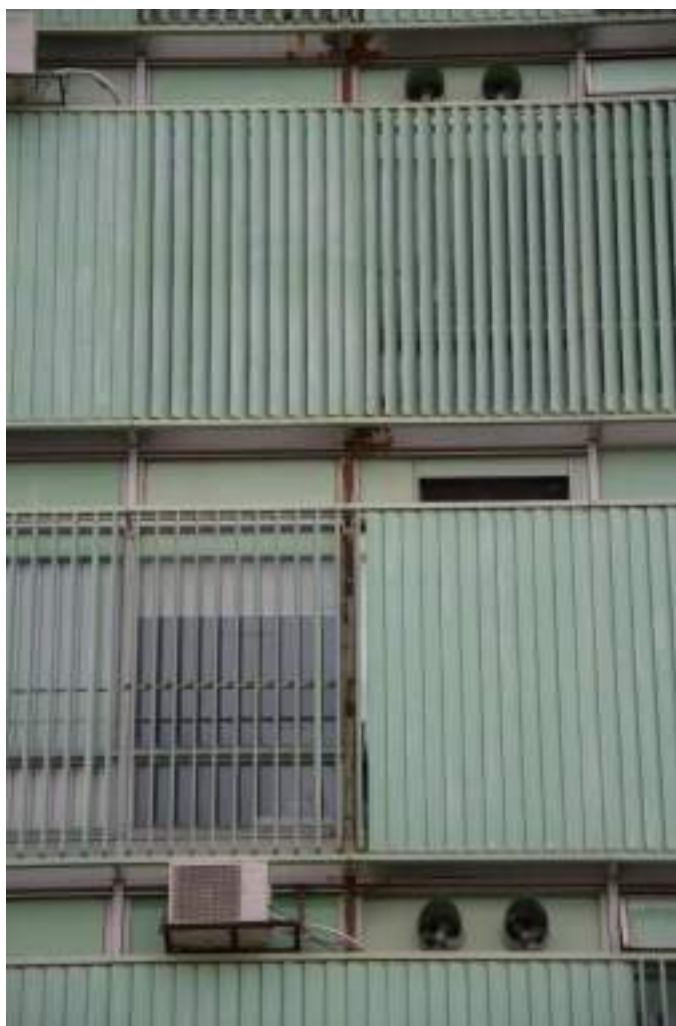
Figura 164. Interferências de elementos não pertencentes à construção original ou espúrios, tais como dutos de exaustão e unidades aparentes de ar-condicionado na Fachada Oeste do Edifício Sede; oxidação e corrosão de esquadrias. Imagem: Alba Bispo, mar/2020.
