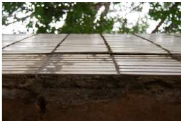
Figura 50. Detalhe do destacamento de placas cerâmicas na entrada do acesso veicular do Edifício Sede. Imagem: Alba Bispo, mar/2020.
