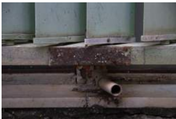
Figura 123. Corrosão metálica dos brises; notar tubo de água de unidades de ar-condicionado aparentes na fachada. Imagem: Alba Bispo, mar/2020.
