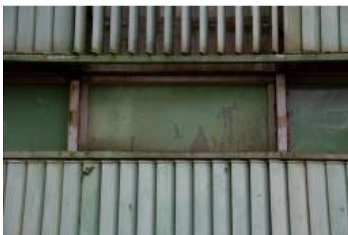
Figura 60. Degradação material com descascamento da pintura dos brises; oxidação de brises e esquadrias; películas desgastadas. Imagem: Alba Bispo, mar/2020.
