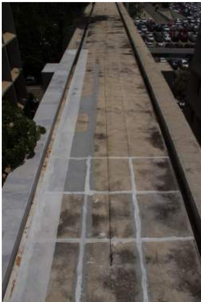
Figura 152. Sujidades e reparos pontuais na impermeabilização da cobertura da passarela de conexão entre o Edifício Sede e o Edifício Anexo. Imagem: Alba Bispo, mar/2020.
