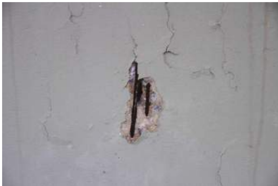
Figura 166. Lacuna no concreto com exposição de ferragens no teto da marquise do Edifício Anexo. Imagem: Alba Bispo, mar/2020.
