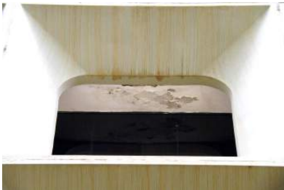
Figura 164. Umidade localizada no teto, infiltrações pontuais, manchas e sujidades no concreto. Imagem: Alba Bispo, mar/2020.
