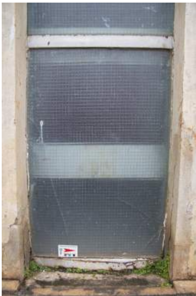
Figura 15. Vidros trincados na saída de emergência na Fachada Oeste do Edifício Sede. Imagem: Alba Bispo, mar/2020.
