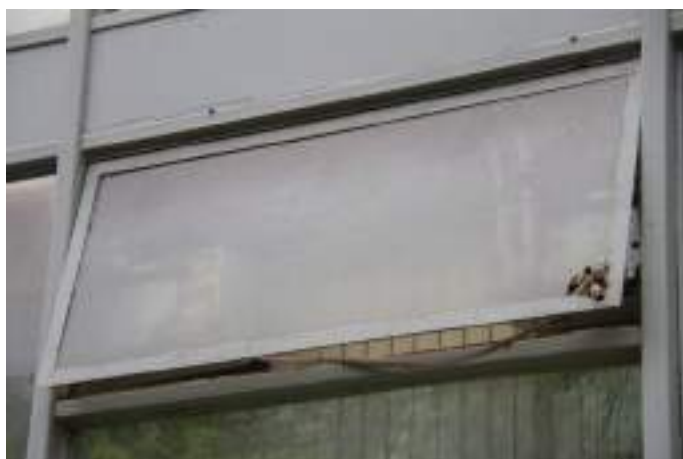
Figura 142. Adição de duto de ar-condicionado através de intersecção do vidro da esquadria na Fachada Leste do Edifício Sede. Imagem: Alba Bispo, mar/2020.
