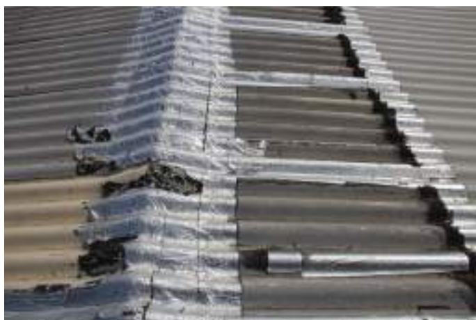
Figura 65. Detalhe dos remendos nas telhas e mantas de impermeabilização na cobertura. Imagem: Alba Bispo, mar/2020.
