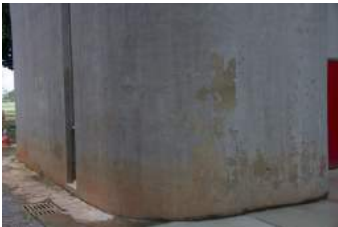
Figura 102. Umidade localizada no pavimento e alterações cromáticas no concreto aparente do volume das escadas de emergência. Imagem: Alba Bispo, mar/2020.
