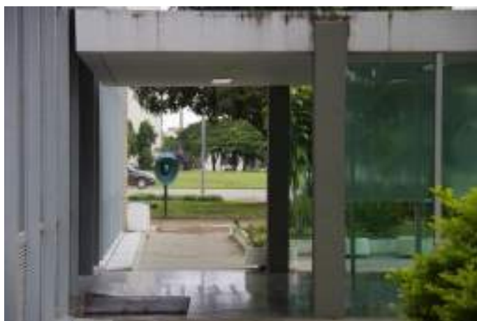
Figura 4. Ausência de esquadria de vidro na marquise do acesso privativo do Edifício Sede. Imagem: Alba Bispo, mar/2020.
