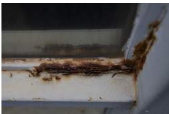
Figura 141. Grau de oxidação e corrosão das esquadrias do térreo na Fachada Leste do Edifício Sede. Imagem: Alba Bispo, mar/2020.
