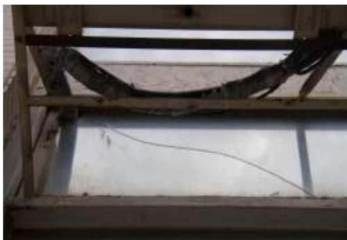
Figura 179. Vidro trincado em esquadria interseccionada por dutos de unidades aparentes de ar-condicionado na Fachada Leste do Edifício Sede. Imagem: Alba Bispo, mar/2020.
