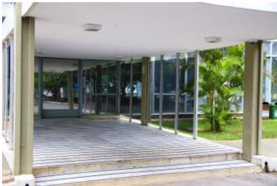
Figura 218. Visão geral do piso da marquise que apresenta fissuras e deformações pontuais com pequeno rebaixo no piso da marquise da entrada privativa em função de movimentações de recalque no Edifício Sede. Imagem: Alba Bispo, mar/2020.
