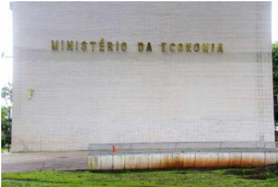
Figura 192. Deformações estruturais em função de movimentações na laje da sobreloja, com destacamento do revestimento cerâmico na Fachada Norte do Edifício Sede. Imagem: Alba Bispo, mar/2020.
