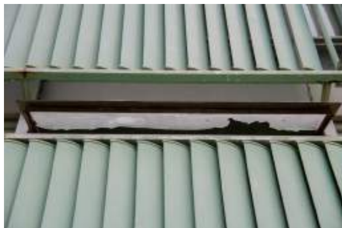
Figura 35. Desgaste de película e oxidação em esquadria na Fachada Oeste do Edifício Sede. Imagem: Alba Bispo, mar/2020.
