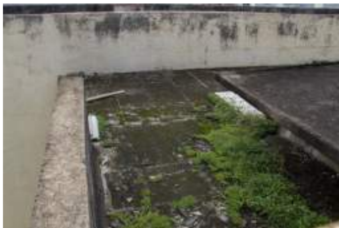
Figura 87. Colonização biológica na laje das escadas de emergência do Edifício Sede. Imagem: Alba Bispo, mar/2020.
