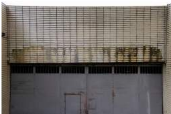
Figura 49. Degradação material com destacamento de placas cerâmicas, umidade localizada, grande incidência de fissuras, trincas e rachaduras na entrada do acesso veicular do Edifício Sede. Imagem: Alba Bispo, mar/2020.
