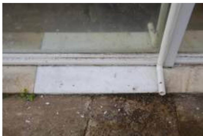
Figura 113. Umidade localizada na Fachada Leste do Edifício Sede derivada da água das unidades aparentes de ar-condicionado; notar substituição pontual do revestimento em mármore do piso. Imagem: Alba Bispo, mar/2020.
