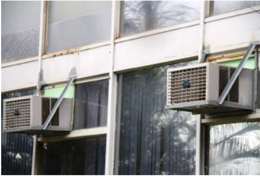
Figura 210. Adição de unidades de ar-condicionado aparentes na Fachada Leste do Edifício Sede, com incluindo tubos que interseccionam esquadrias e dutos que projetam pingos d'água constantemente na fachada, provocando danos de corrosão nas esquadrias e infiltrações, sobretudo no térreo. Imagem: Alba Bispo, mar/2020.
