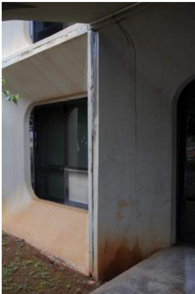
Figura 91. Manchas e sujidades no concreto aparente da marquise de entrada da Fachada Oeste do Edifício Anexo, sobretudo em pontos de infiltrações e umidade localizada. Imagem: Alba Bispo, mar/2020.
