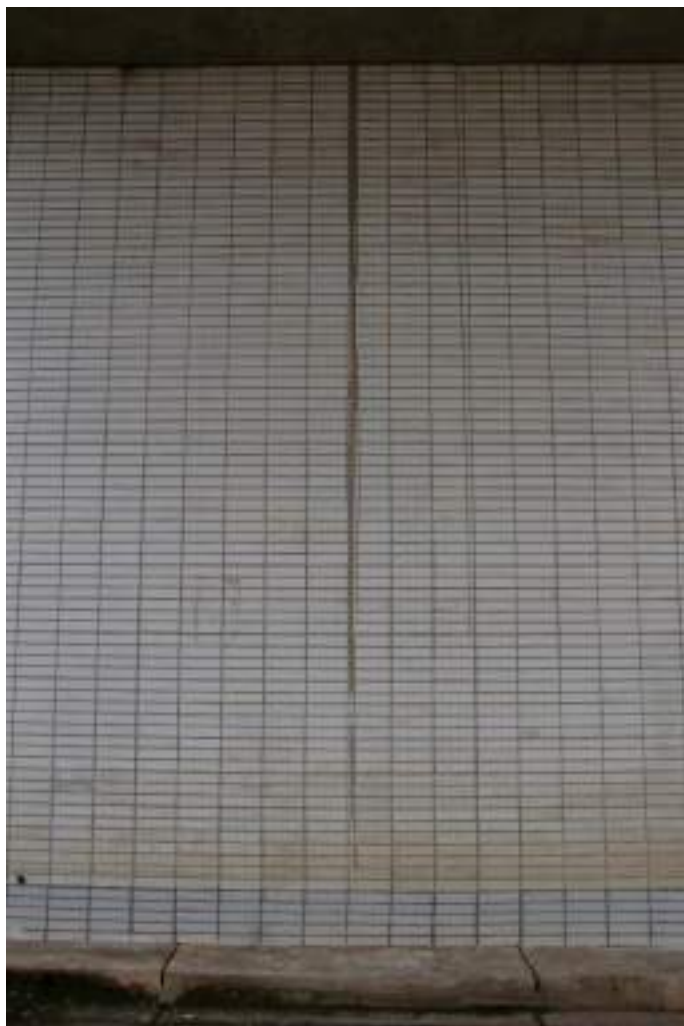
Figura 83. Sujidades e substituições pontuais do revestimento cerâmico, no trecho inferior da Fachada Sul do Edifício Sede. Imagem: Alba Bispo, mar/2020.
