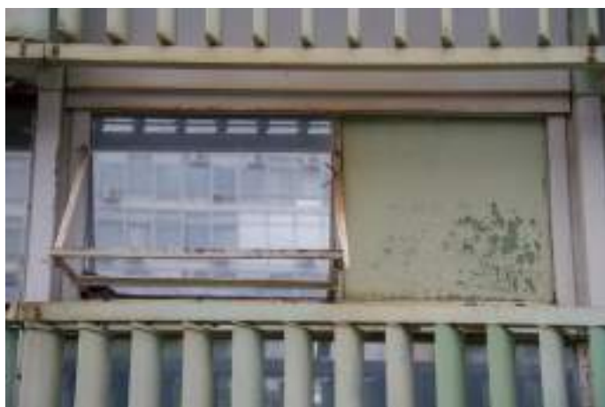
Figura 78. Oxidação de brises e esquadrias na Fachada Oeste do Edifício Sede; películas desgastadas. Imagem: Alba Bispo, mar/2020.
