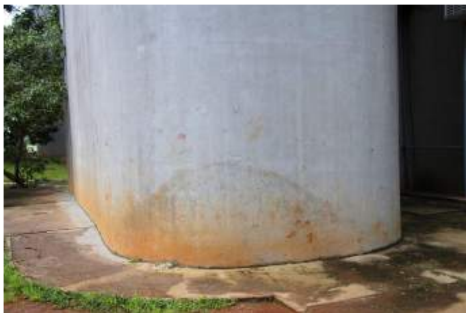
Figura 203. Sujidades e umidade localizada no concreto aparente da torre de emergência. Imagem: Alba Bispo, mar/2020.
