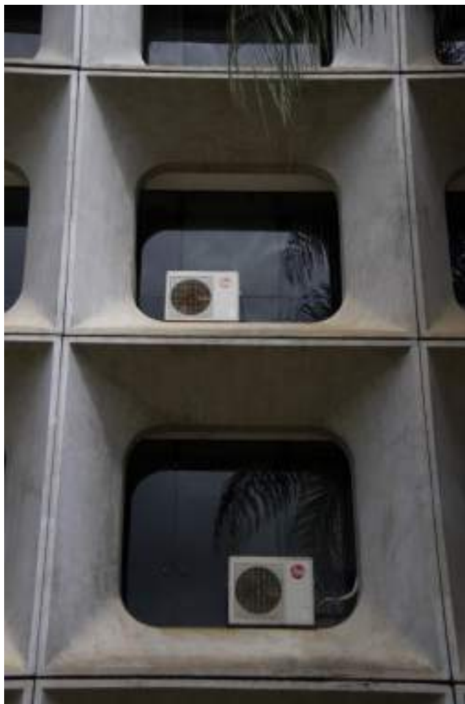
Figura 188. Adição de unidades aparentes de ar-condicionado na Fachada Oeste do Edifício Anexo; manchas e sujidades no concreto aparente. Imagem: Alba Bispo, mar/2020.
