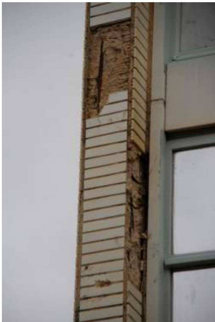
Figura 55. Perdas no revestimento cerâmico com exposição de ferragens na Fachada Leste do Edifício Sede. Imagem: Alba Bispo, mar/2020.
