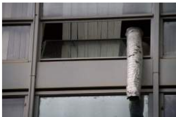
Figura 24. Interferências de elementos não pertencentes à construção original, incluindo tubos que interseccionam esquadrias e dutos que projetam pingos d'água constantemente na fachada, provocando danos de corrosão nas esquadrias e infiltrações pontuais na Fachada Leste do Edifício Sede. Imagem: Alba Bispo, mar/2020.
