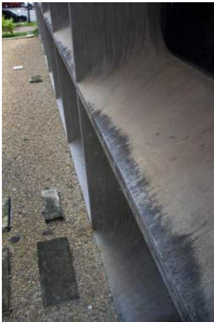
Figura 161. Sujidades e manchas de infiltrações no concreto na Fachada Oeste na área dos jardins internos do Edifício Anexo. Imagem: Alba Bispo, mar/2020.
