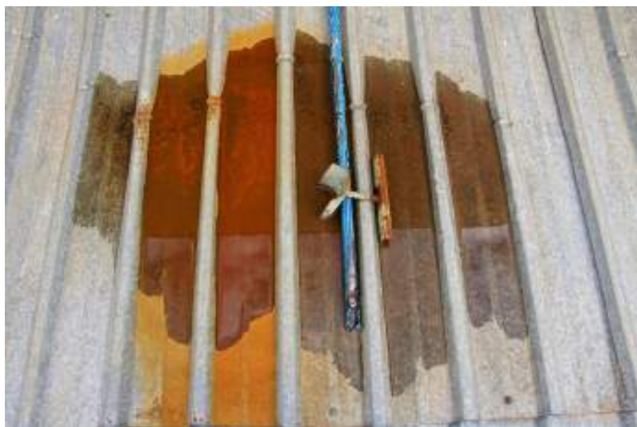
Figura 171. Umidade localizada com acúmulo pontual de água na cobertura do Edifício Anexo. Imagem: Alba Bispo, mar/2020.
