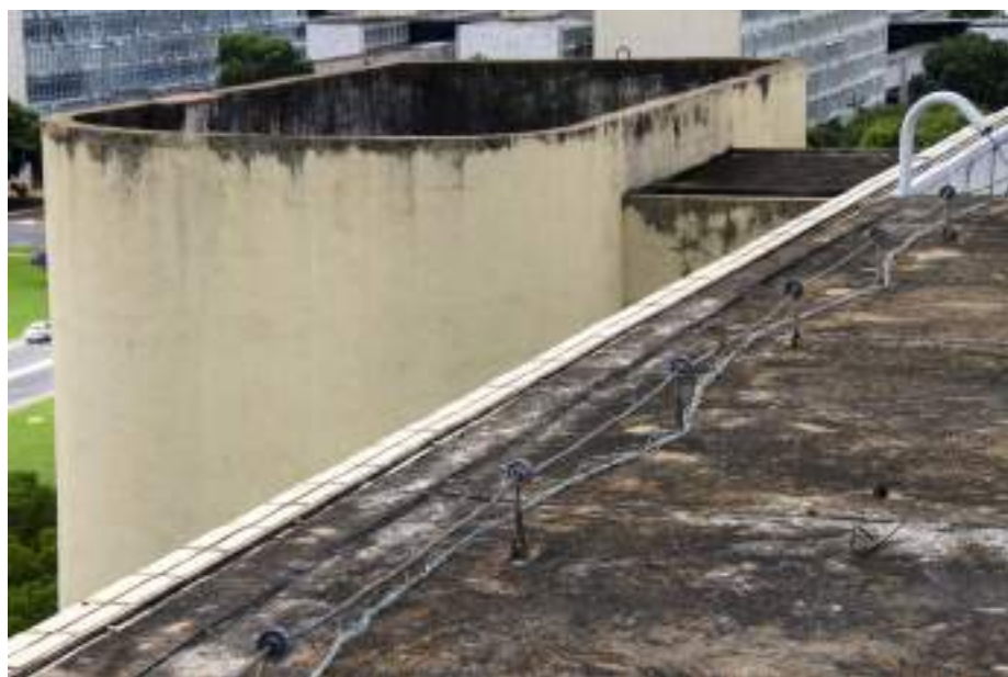
Figura 158. Sujeidades na escada de emergência do Edifício Sede. Imagem: Alba Bispo, mar/2020.
