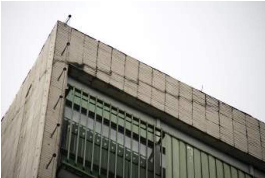
Figura 223. Trincas na área da extremidade da platibanda entre as Fachadas Norte e Oeste do Edifício Sede. Imagem: Alba Bispo, mar/2020.
