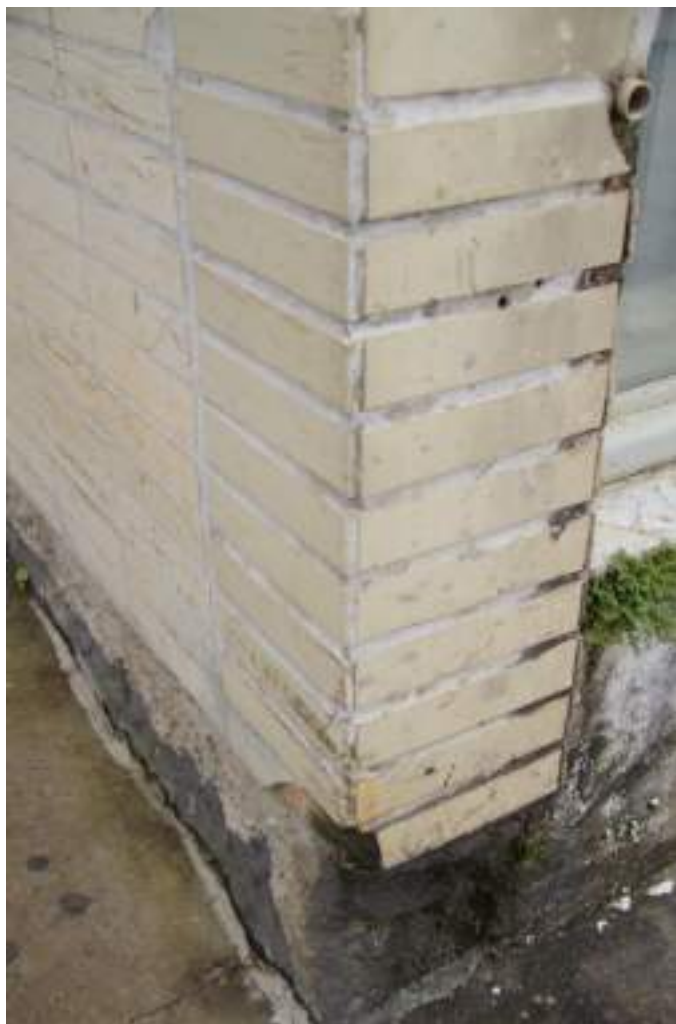
Figura 183. Umidade localizada e perda de revestimento cerâmico na Fachada Sul do Edifício Sede. Imagem: Alba Bispo, mar/2020.
