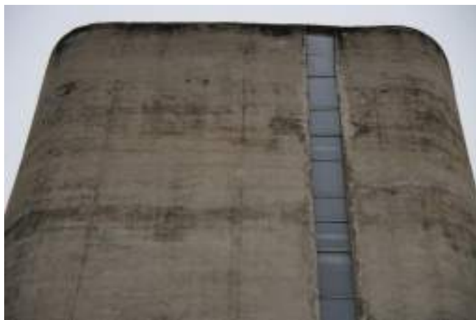
Figura 3. Umidade descendente e sujidades no concreto aparente das escadas de emergência do Edifício Sede. Imagem: Alba Bispo, mar/2020.
