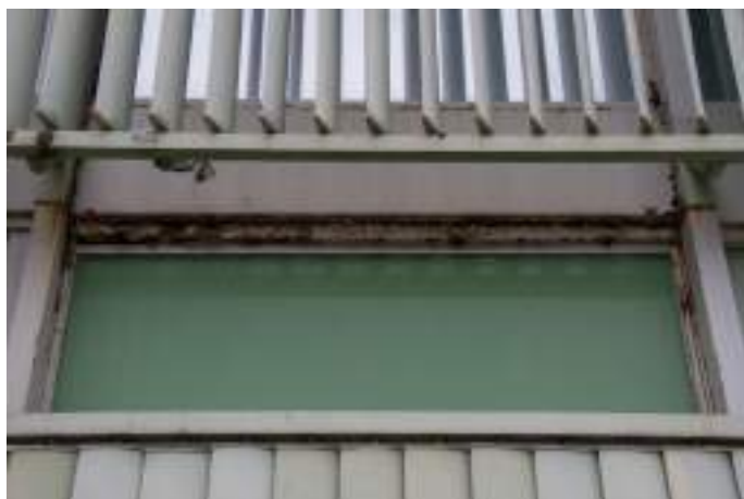
Figura 79. Oxidação de brises e esquadrias na Fachada Oeste do Edifício Sede. Imagem: Alba Bispo, mar/2020.
