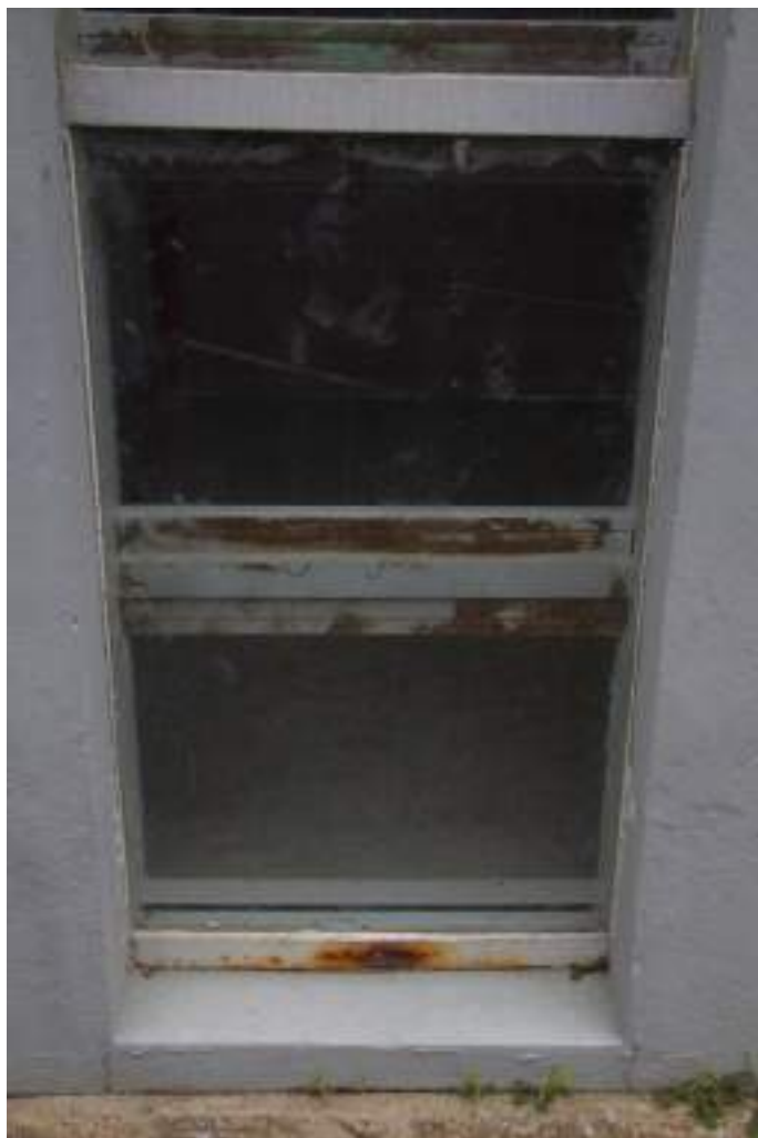
Figura 81. Corrosão metálica em esquadria na torre das escadas de emergência do Edifício Sede. Imagem: Alba Bispo, mar/2020.
