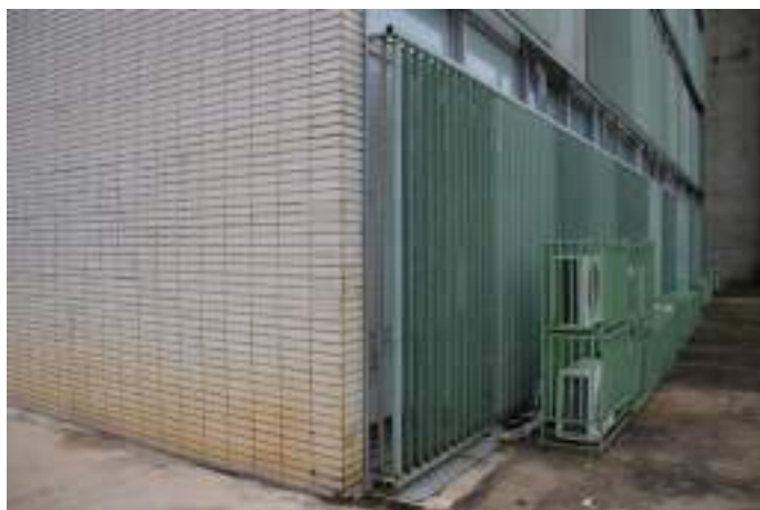
Figura 8. Adição de tubulação aparente junto à Fachada Oeste do Edifício Sede. Imagem: Alba Bispo, mar/2020.
