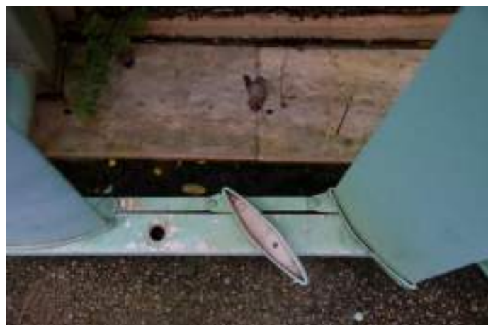
Figura 29. Detalhe da supressão pontual de brises na Fachada Oeste do Edifício Sede. Imagem: Alba Bispo, mar/2020.
