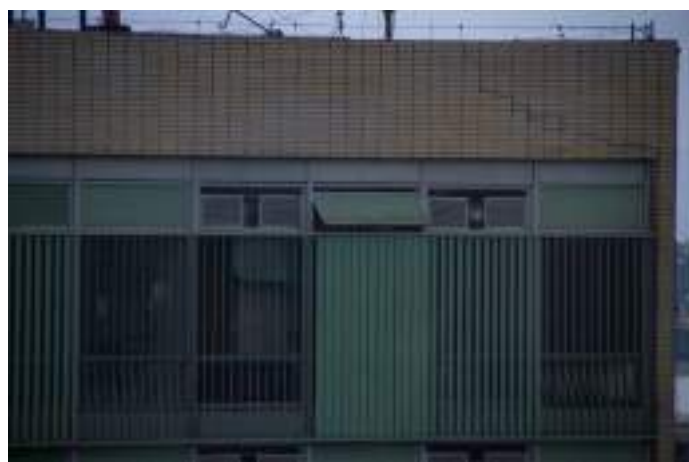
Figura 40. Trincas na platibanda, na extremidade da Fachada Oeste do Edifício Sede. Imagem: Alba Bispo, mar/2020.
