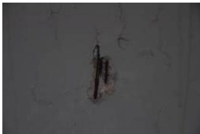
Figura 92. Lacuna no concreto com exposição de ferragens no teto da marquise do Edifício Anexo. Imagem: Alba Bispo, mar/2020.
