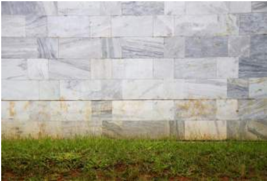
Figura 228. Sujidades pontuais em mármore branco no térreo da fachada do Edifício Anexo. Imagem: Alba Bispo, mar/2020.
