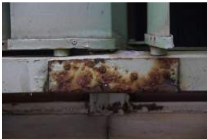
Figura 127. Corrosão metálica dos brises. Imagem: Alba Bispo, mar/2020.
