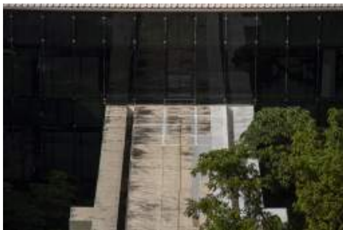
Figura 153. Sujeidades e reparos pontuais na impermeabilização da cobertura da passarela de conexão entre o Edifício Sede e o Edifício Anexo. Imagem: Alba Bispo, mar/2020.
