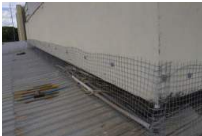
Figura 98. Deformação pontual das telhas da cobertura com acúmulo de água; adição de telas metálicas para evitar a entrada de pombos no volume de acesso à cobertura do Edifício Anexo. Imagem: Alba Bispo, mar/2020.
