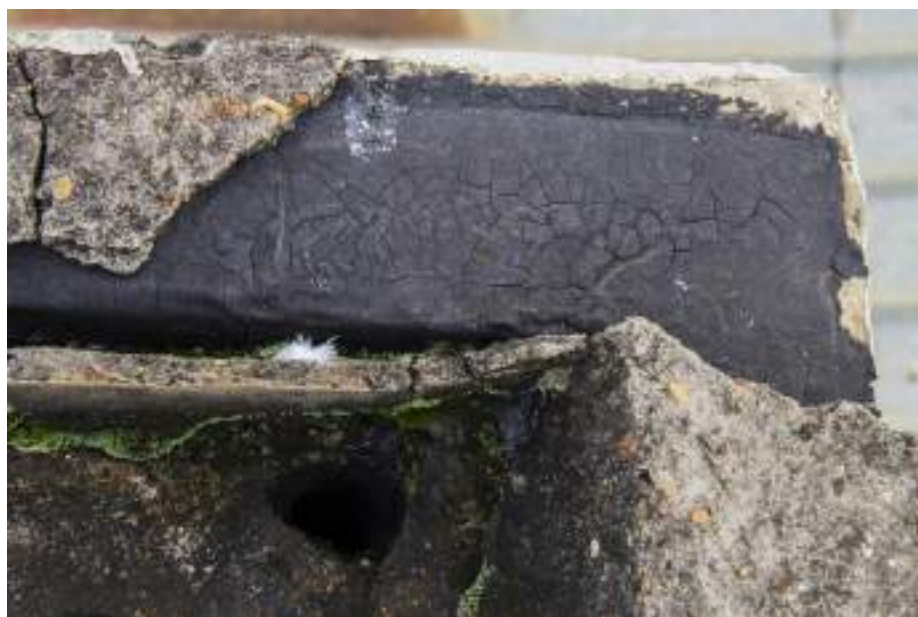
Figura 170. Umidade localizada em função da ineficiência dos ralos na cobertura do Edifício Anexo. Imagem: Alba Bispo, mar/2020.
