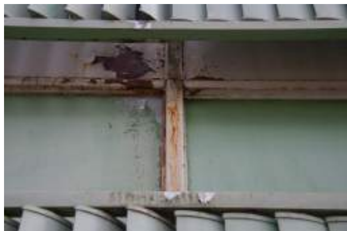
Figura 106. Oxidação e corrosão nas esquadrias da Fachada Oeste do Edifício Sede; desgastes nas películas e na pintura dos brises. Imagem: Alba Bispo, mar/2020.
