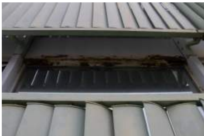
Figura 73. Corrosão metálica em esquadria da Fachada Oeste do Edifício Sede, na área da copa. Imagem: Alba Bispo, mar/2020.
