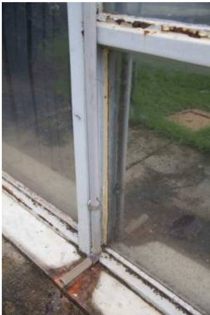
Figura 138. Manchas e sujidades no mármore branco, sobretudo no térreo, derivadas de dutos de ar-condicionado; substituição do vidro; oxidação da esquadria na Fachada Leste do Edifício Sede. Imagem: Alba Bispo, mar/2020.
