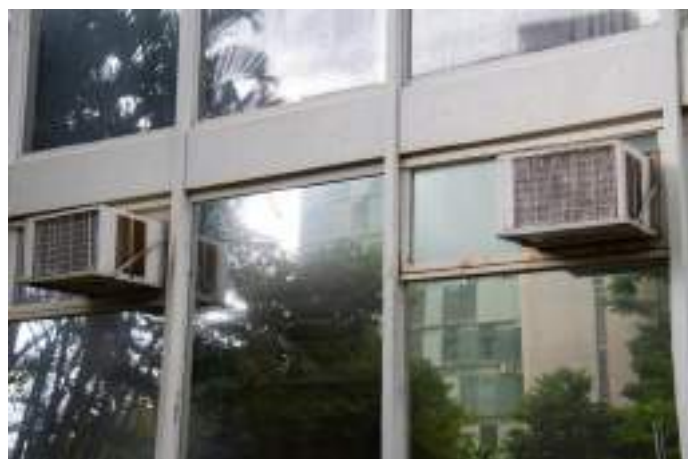
Figura 25. Adição pontual de unidades de ar-condicionado aparentes na Fachada Leste do Edifício Sede, incluindo tubos que interseccionam esquadrias e dutos que projetam pingos d'água constantemente na fachada, provocando danos de corrosão nas esquadrias e infiltrações pontuais. Imagem: Alba Bispo, mar/2020.
