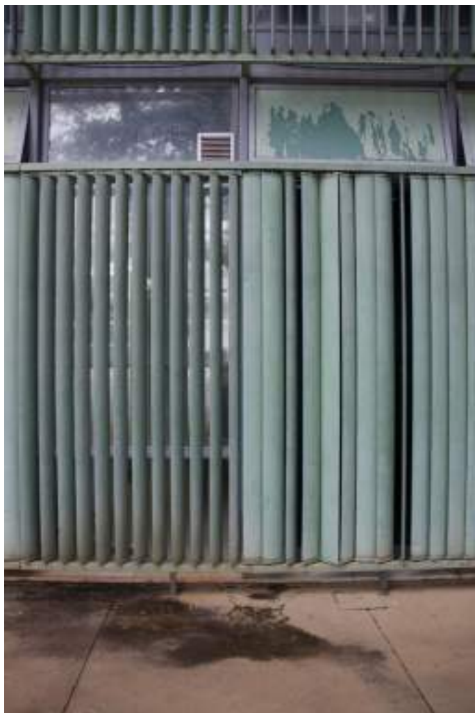
Figura 124. Adição pontual de veneziana em substituição ao vidro; desgaste e diversidade cromática de películas; umidade localizada no pavimento. Imagem: Alba Bispo, mar/2020.
