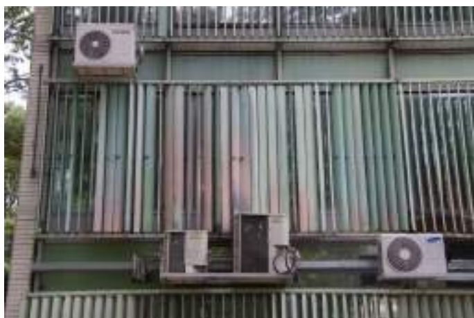
Figura 75. Alterações cromáticas nos brises em função de incêndio ocorrido na área do auditório; unidades aparentes de ar-condicionado na Fachada Oeste do Edifício Sede. Imagem: Alba Bispo, mar/2020.
