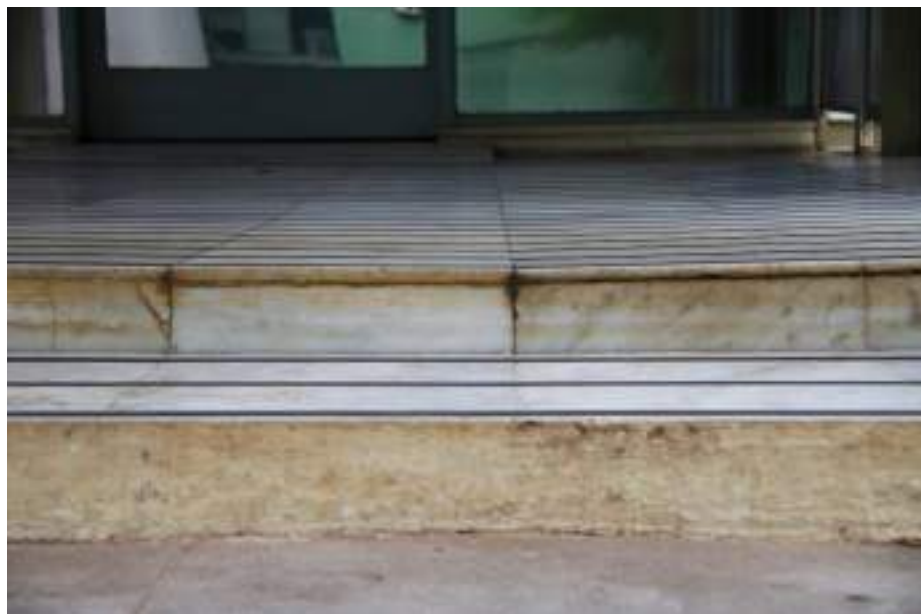
Figura 219. Deformações pontuais com pequeno rebaixo no piso da marquise da entrada privativa em função de movimentações de recalque no Edifício Sede. Imagem: Alba Bispo, mar/2020.
