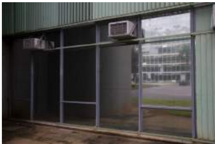
Figura 131. Supressão parcial de brises da Fachada Oeste do Edifício Sede; infiltrações no piso e na parede derivadas dos dutos de ar-condicionado aparentes. Imagem: Alba Bispo, mar/2020.
