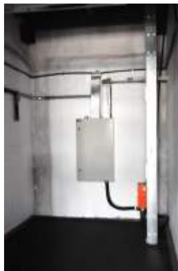
Figura 695. Sala de máquinas, próximo à escada de saída de incêndio.
