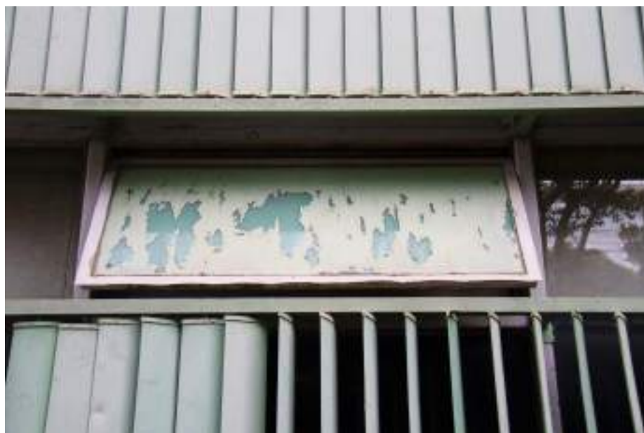
Figura 208. Desgaste e diversidade cromática de películas na Fachada Oeste do Edifício Sede. Imagem: Alba Bispo, mar/2020.
