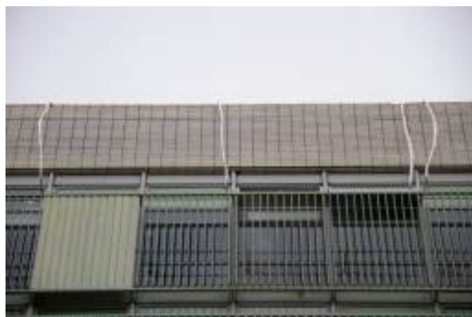
Figura 9. Adição de tubulação aparente junto à Fachada Oeste do Edifício Sede; alterações cromáticas nas películas. Imagem: Alba Bispo, mar/2020.
