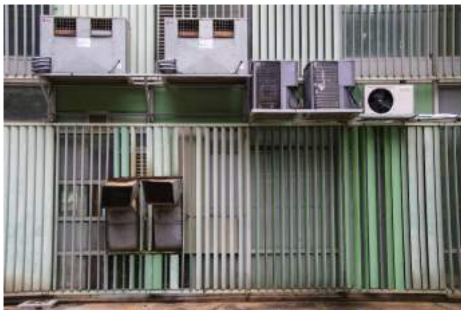
Figura 148. Interferências de elementos não pertencentes à construção original ou espúrios, tais como dutos de exaustão e unidades aparentes de ar-condicionado na Fachada Oeste do Edifício Sede; unidade localizada nos brises, sobretudo no térreo. Imagem: Alba Bispo, mar/2020.
