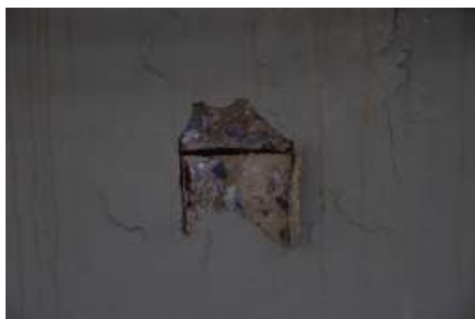
Figura 93. Lacuna no concreto com exposição de ferragens no teto da marquise do Edifício Anexo. Imagem: Alba Bispo, mar/2020.
