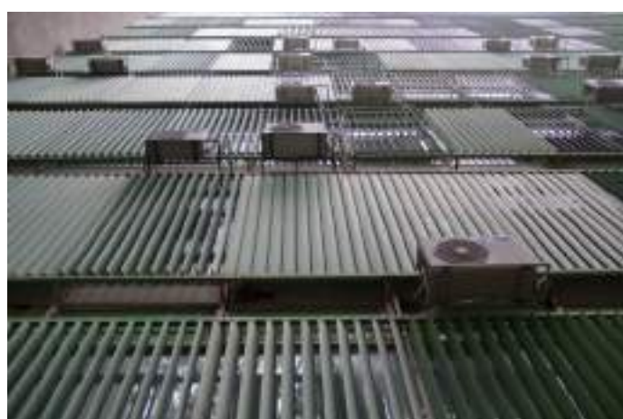
Figura 104. Visão geral da tubulação de coleta para reuso da água derivada das unidades aparentes de ar-condicionado na Fachada Oeste do Edifício Sede, incluindo tubos que interseccionam esquadrias e dutos que projetam pingos d'água constantemente na fachada, provocando danos de corrosão nas esquadrias e infiltrações pontuais, com. Imagem: Alba Bispo, mar/2020.
