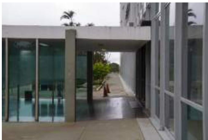
Figura 5. Ausência de esquadria de vidro na marquise do acesso principal do Edifício Sede. Imagem: Alba Bispo, mar/2020.
