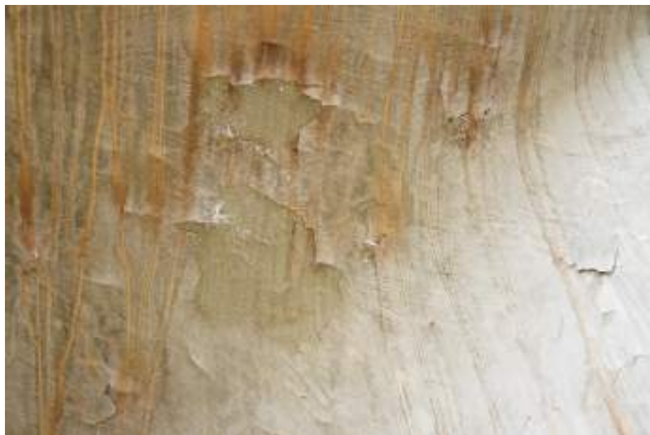
Figura 234. Sujidades e descascamento no concreto aparente no térreo do Edifício Anexo. Imagem: Alba Bispo, mar/2020.
