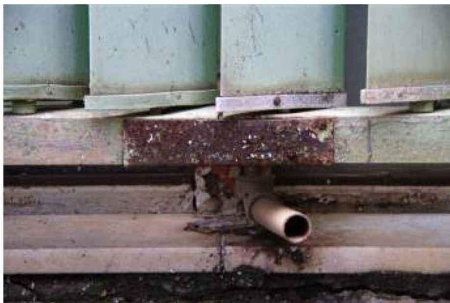
Figura 197. Corrosão metálica dos brises; notar tubo de água de unidades de ar-condicionado aparentes na fachada. Imagem: Alba Bispo, mar/2020.
