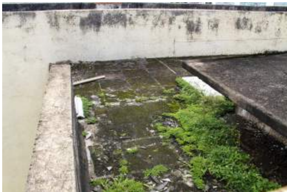
Figura 161. Colonização biológica na laje das escadas de emergência do Edifício Sede. Imagem: Alba Bispo, mar/2020.
