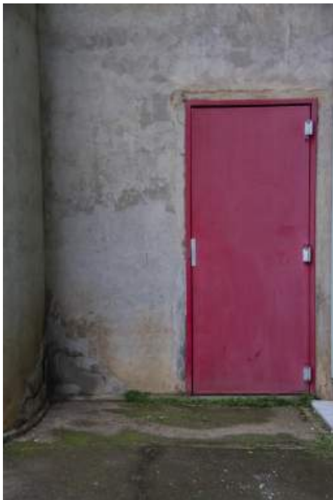
Figura 14. Unidade localizada junto à saída de emergência do Edifício Sede. Imagem: Alba Bispo, mar/2020.
