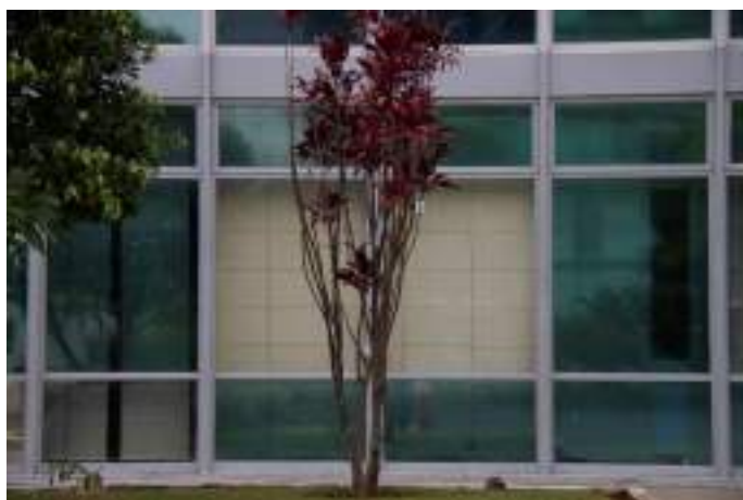
Figura 16. Alterações cromáticas nas películas na Fachada Leste do Edifício Sede. Imagem: Alba Bispo, mar/2020.
