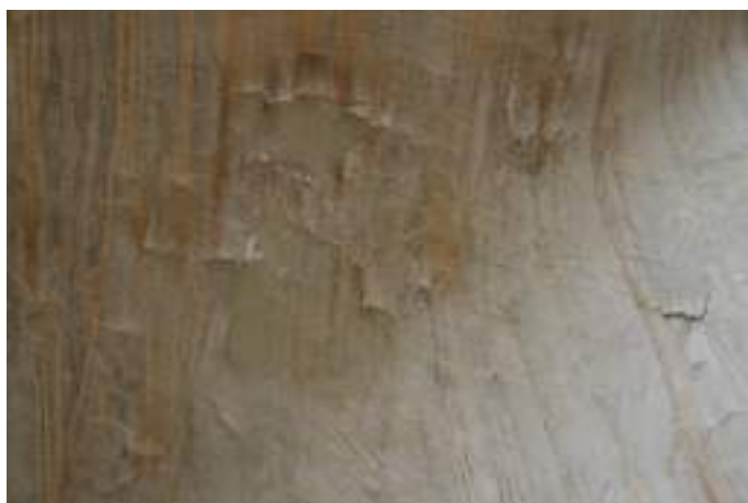
Figura 160. Sujidades e descascamento no concreto aparente no térreo do Edifício Anexo. Imagem: Alba Bispo, mar/2020.
