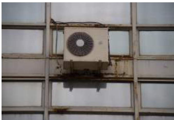
Figura 175. Oxidação e corrosão nas esquadrias da Fachada Leste. Imagem: Alba Bispo, mar/2020.
