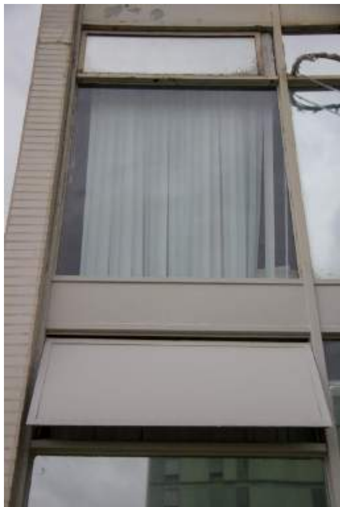
Figura 111. Adição de tubulações aparentes que interseccionam esquadrias na Fachada Leste do Edifício Sede; alterações cromáticas nas películas. Imagem: Alba Bispo, mar/2020.
