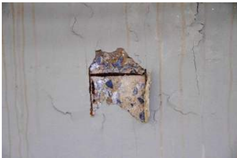
Figura 167. Lacuna no concreto com exposição de ferragens no teto da marquise do Edifício Anexo. Imagem: Alba Bispo, mar/2020.
