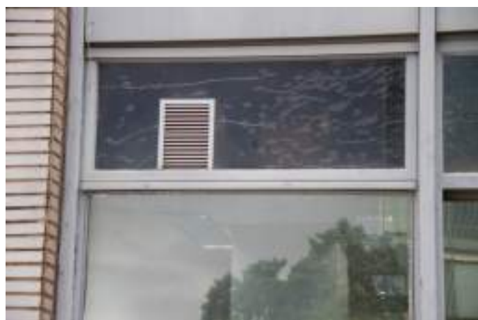
Figura 27. Adição pontual de veneziana na Fachada Leste do Edifício Sede, com interferências de elementos não pertencentes à construção original. Imagem: Alba Bispo, mar/2020.
