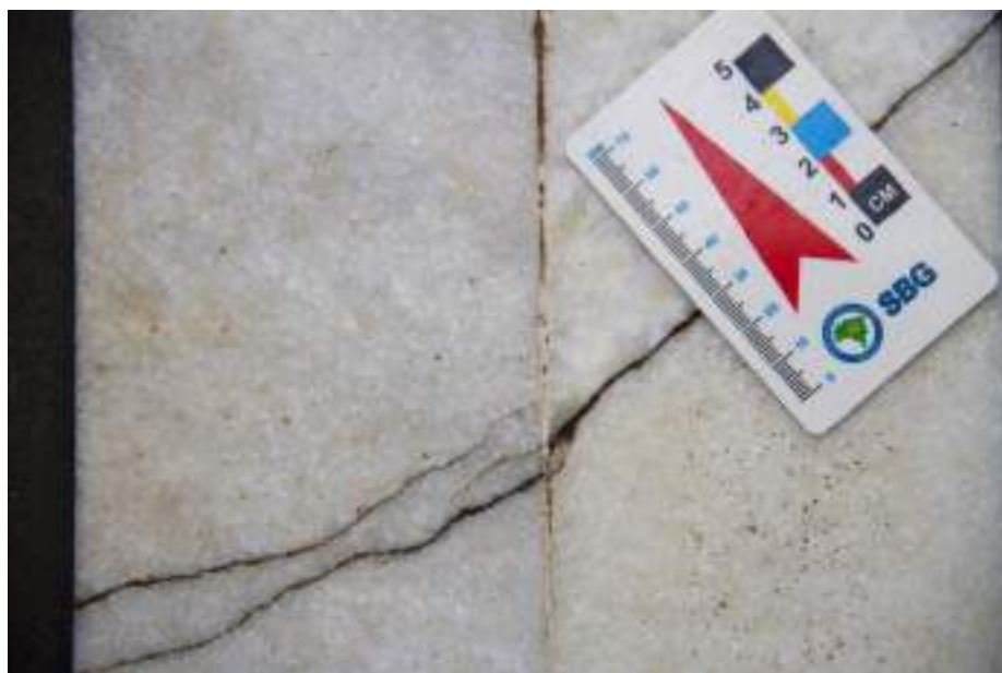
Figura 220. Dimensão das fissuras no piso da marquise da entrada privativa em função de movimentações de recalque no Edifício Sede. Imagem: Alba Bispo, mar/2020.
