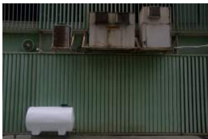
Figura 105. Adição com interferência negativa de elementos não pertencentes à construção original ou espúrios, tais como dutos de exaustão e unidades aparentes de ar-condicionado na Fachada Oeste do Edifício Sede. Imagem: Alba Bispo, mar/2020.
