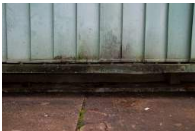
Figura 62. Umidade localizada, sujidades e oxidação dos brises, sobretudo no térreo da Fachada Oeste. Imagem: Alba Bispo, mar/2020.
