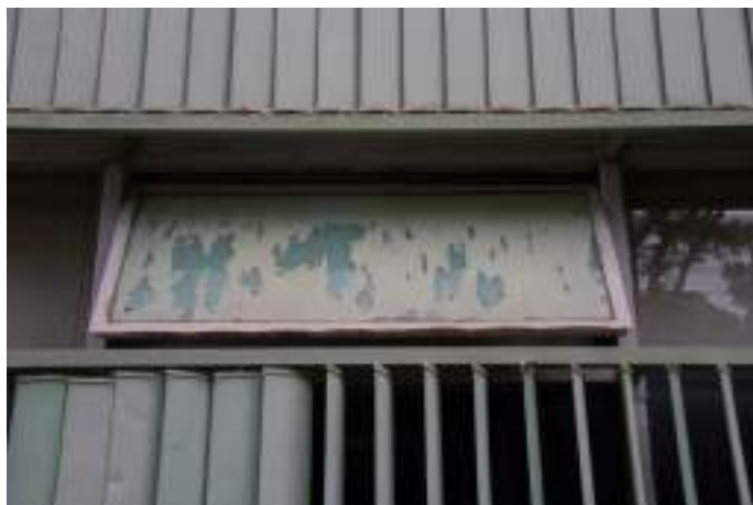
Figura 134. Desgaste e diversidade cromática de películas na Fachada Oeste do Edifício Sede. Imagem: Alba Bispo, mar/2020.
