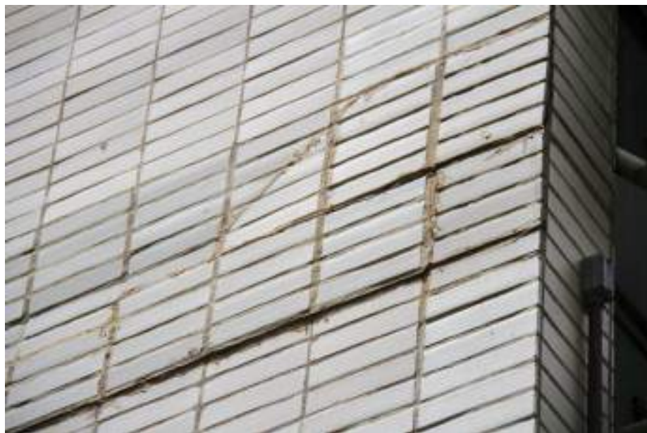
Figura 142. Deformações estruturais, trincas e rachaduras na laje da sobreloja, com destacamento do revestimento cerâmico na Fachada Norte do Edifício Sede. Imagem: Alba Bispo, mar/2020.
