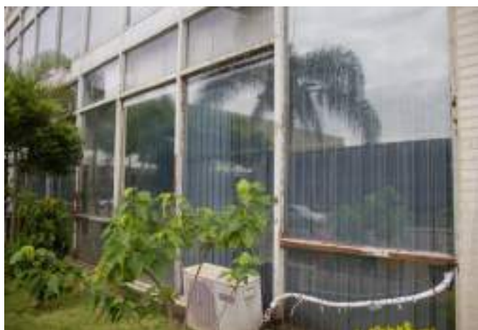
Figura 176. Oxidação e corrosão nas esquadrias da Fachada Leste; esquadrias interseccionadas por dutos de unidades aparentes de ar-condicionado. Imagem: Alba Bispo, mar/2020.
