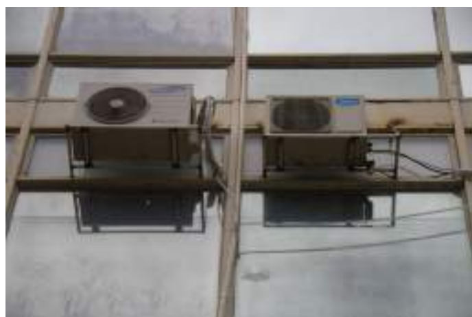
Figura 110. Oxidação e corrosão nas esquadrias da Fachada Leste; notar esquadrias interseccionadas pelos tubos de coleta para reuso da água derivada das unidades aparentes de ar-condicionado. Imagem: Alba Bispo, mar/2020.
