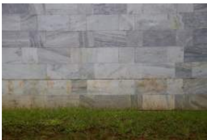
Figura 154. Sujeidades pontuais em mármore branco no térreo da fachada do Edifício Anexo. Imagem: Alba Bispo, mar/2020.
