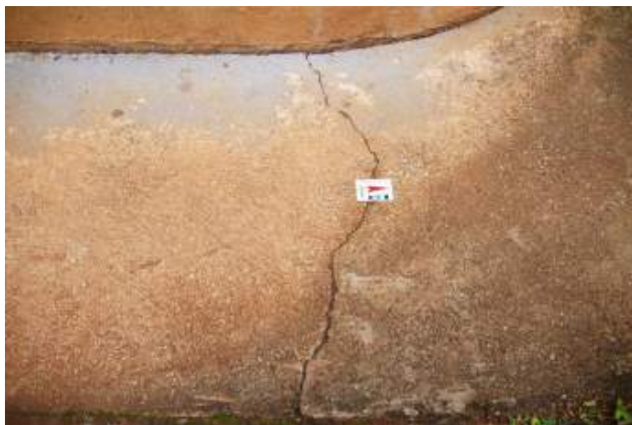
Figura 206. Trinca no passeio da Fachada Oeste, próximo ao volume das escadas de emergência decorrentes de movimentação de recalque no Edifício Sede. Imagem: Alba Bispo, mar/2020.
