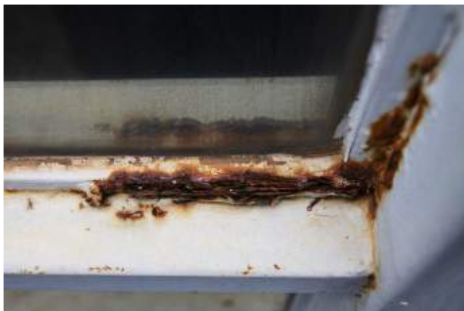
Figura 215. Grau de oxidação e corrosão das esquadrias do térreo na Fachada Leste do Edifício Sede. Imagem: Alba Bispo, mar/2020.
