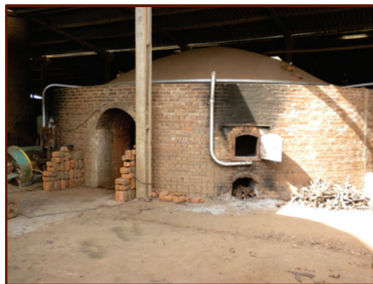
Figura 2: Forno abóbada, onde se visualiza uma fornalha, cinzeiro (abaixo desta), uma porta de carregamento do forno, e tubulação de ar de combustão.
