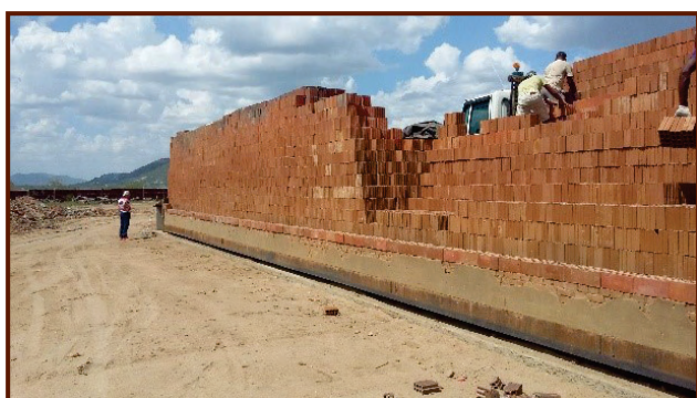
Figura 6: Cerâmica Nossa Senhora dos Impossíveis - forno vagão metálico e plataforma com carga (blocos) pronta para ser retirada.
