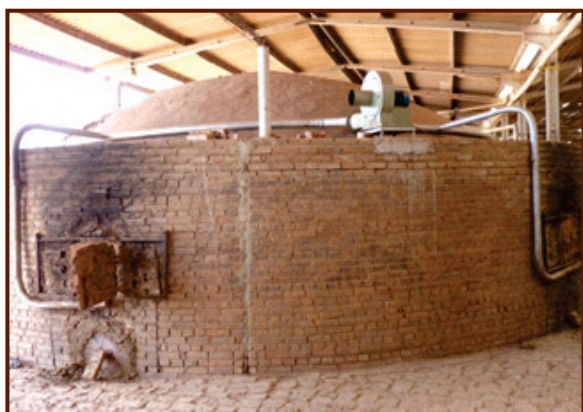
Figura 4: Insuflamento de ar de combustão.
