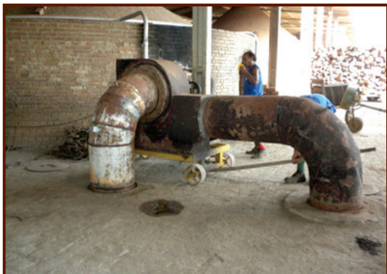
Figura 10: Dutos para preaquecimento.
