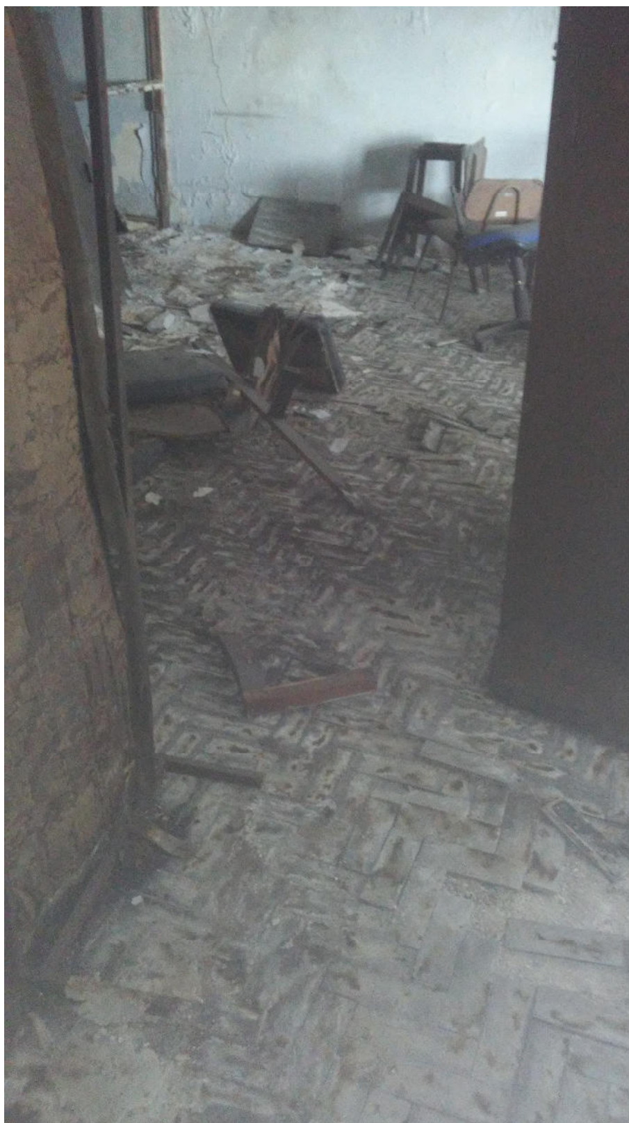
foto 12 - piso de tacos destruído e infiltração na parede entre os dois prédios
