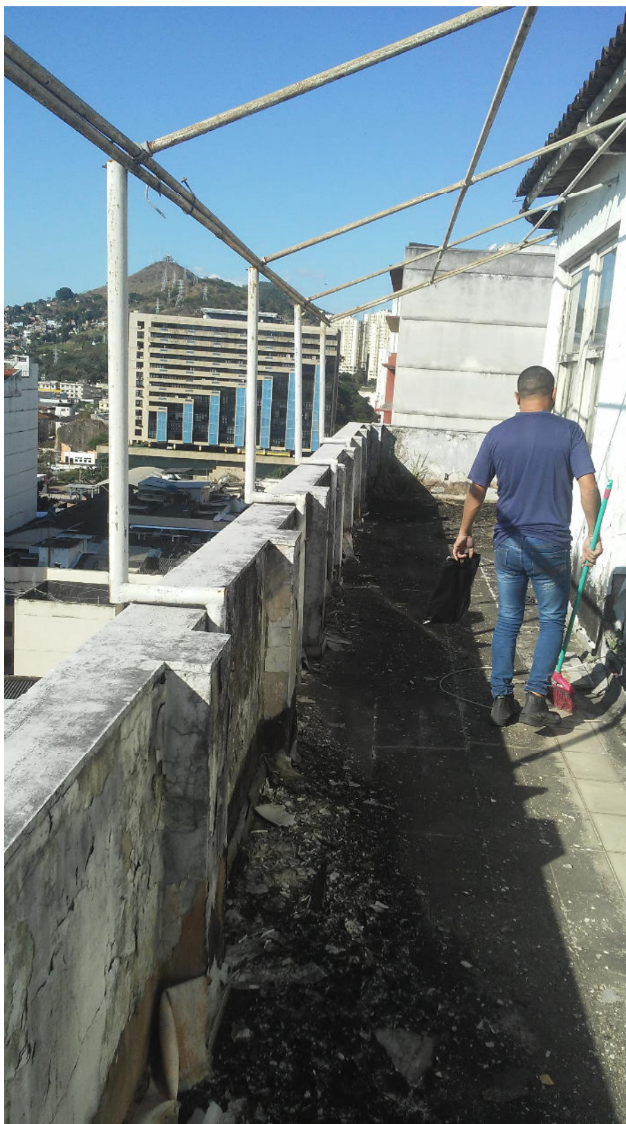
foto 27 - integridade da estrutura da mureta na cobertura voltada pra rua Cel. Machado
