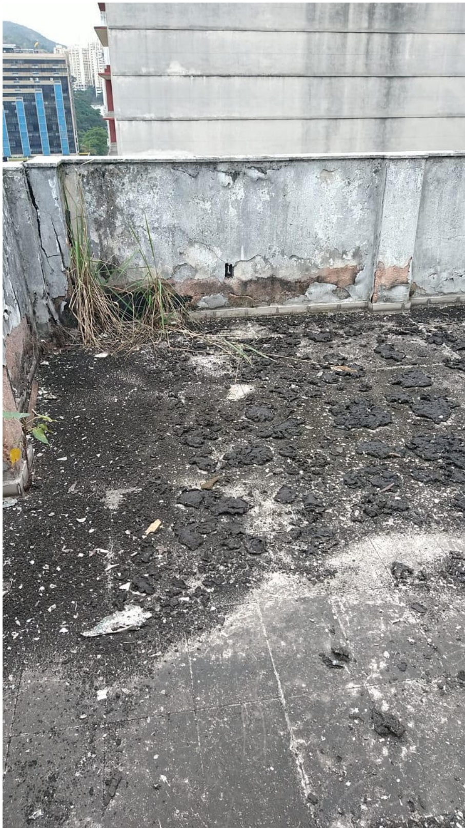
foto 28 - vista integridade da estrutura da mureta na cobertura trecho voltado para o estacionamento interno e do ralo totalmente obstruído.
