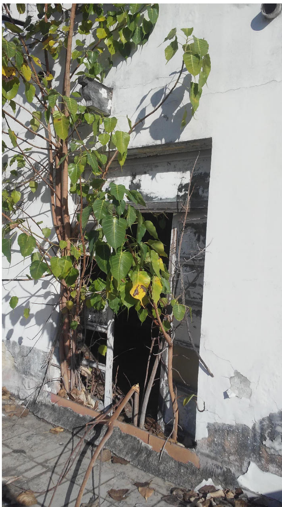
foto 23 - arbustos crescendo na impermeabilização do piso da cobertura
