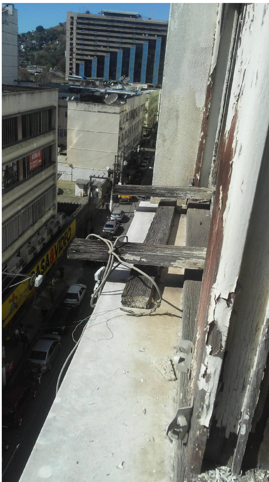
foto 7 - estrutura de madeira solta e cordas da veneziana partidas e pintura da esquadria deteriorada
