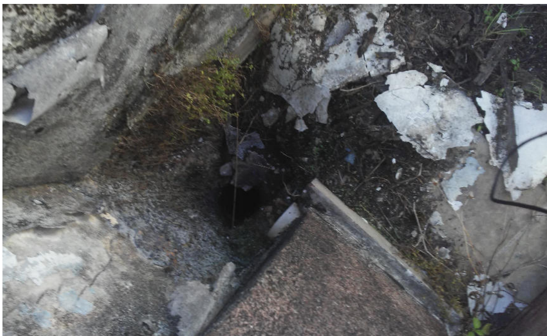
foto 22 - ralo da cobertura totalmente obstruído
