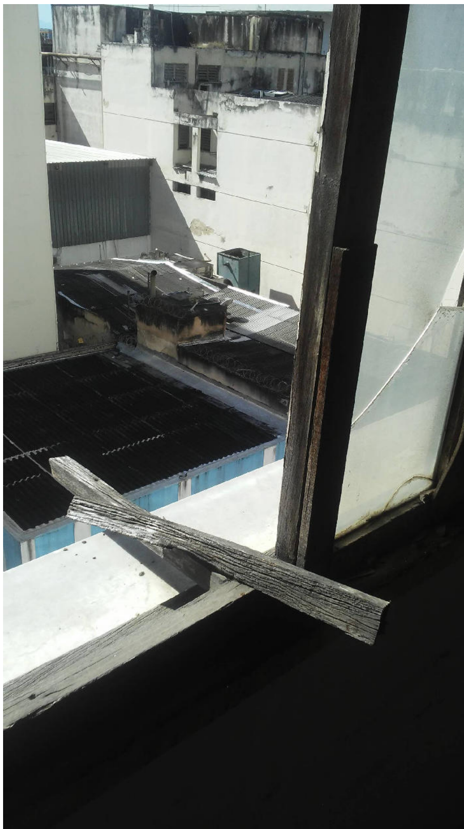
foto 9 - sobra de estrutura de madeira para o condicionador de ar, evidencia de dano as esquadrias e vidro quebrado se desprendendo.
