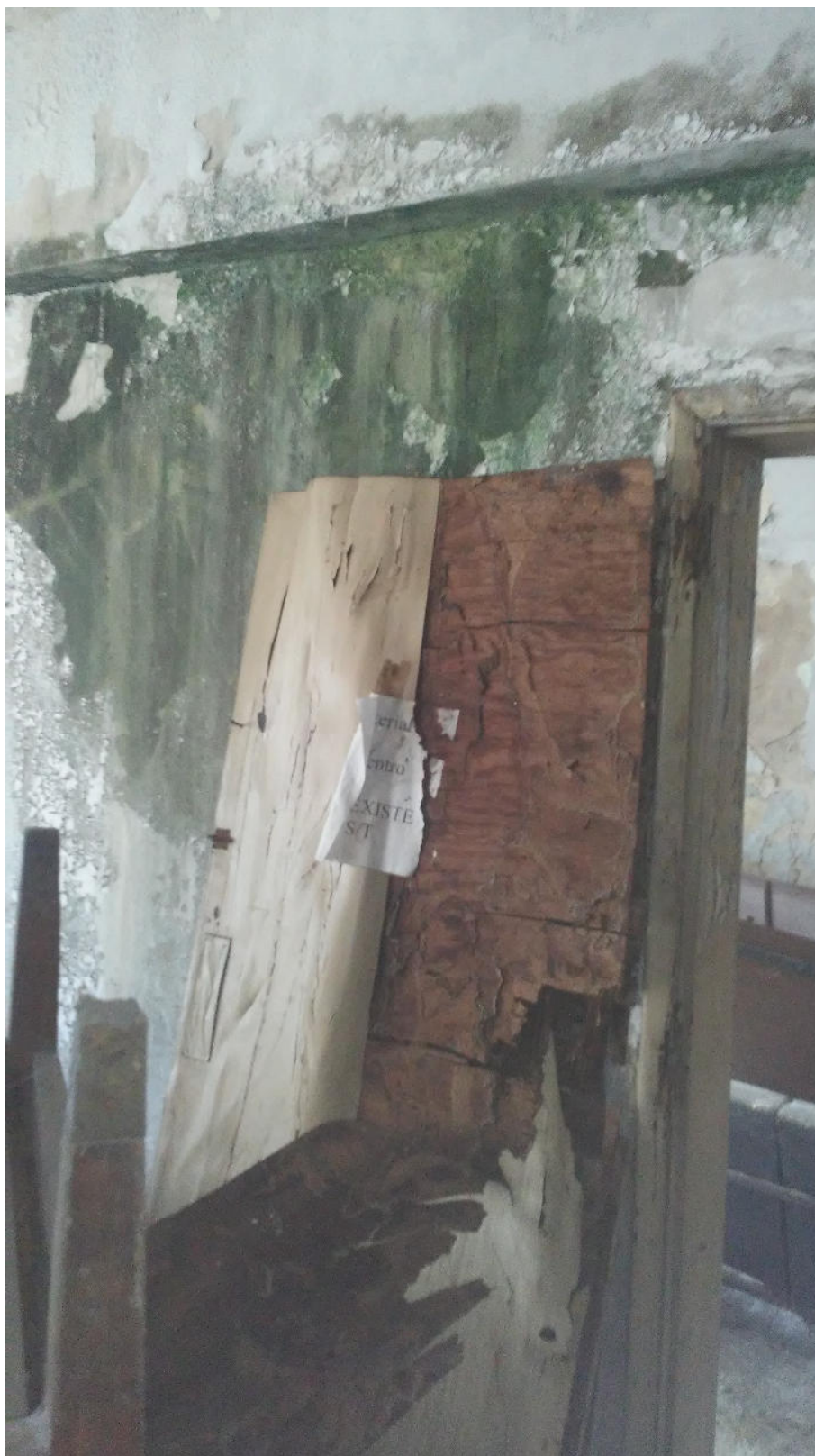
foto 13 - infiltração no trecho abaixo dos arbustos que crescem na cobertura, se percebe que ainda não há dano estrutural, somente aos revestimentos.
