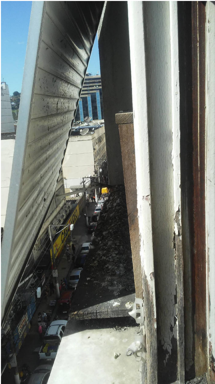
foto 8 - guia da veneziana quebrada e suporte de madeira coberto de fezes de pombos
