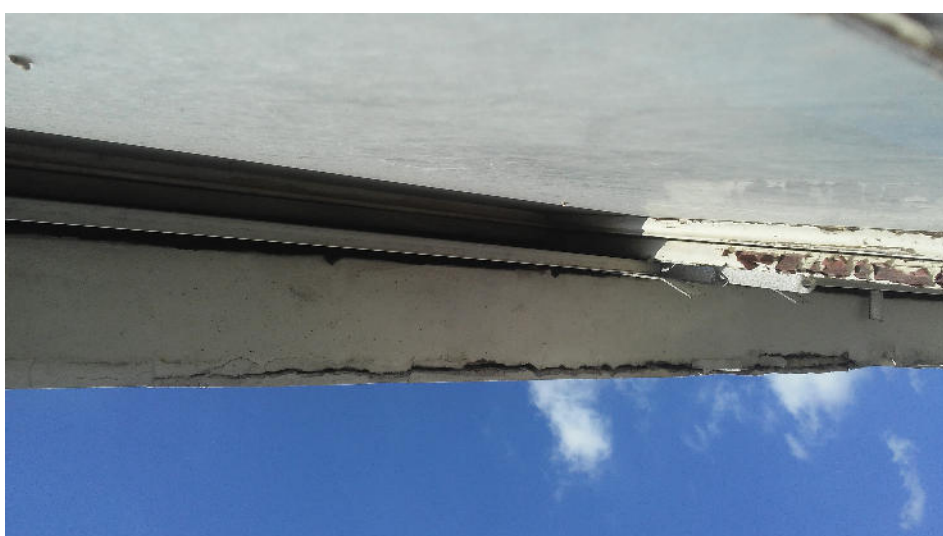
fotos 15, 16 e 17 - desprendimento do revestimento das vergas por oxidação das armaduras nos vãos de janela do 10 ° pav, devido a infiltração.
