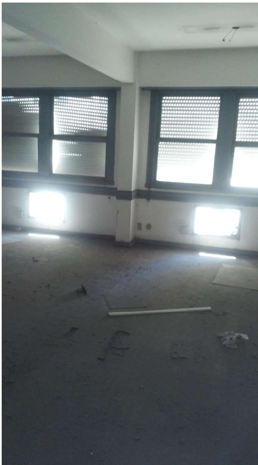
foto 10 - vãos dos condicionadores abertos e venezianas saindo das guias
