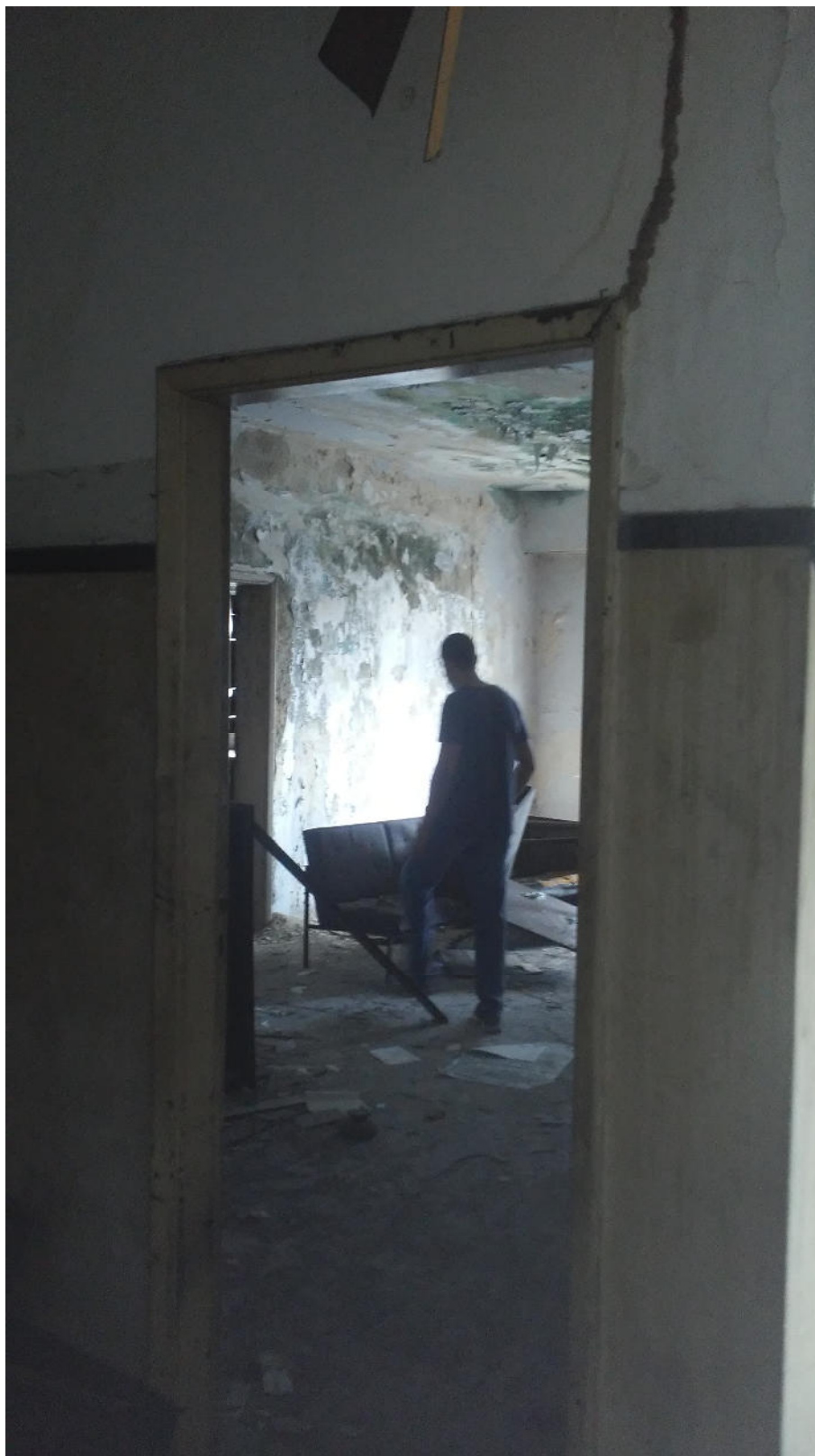
foto 11 - deterioração dos revestimentos das paredes e da laje pela infiltração no trecho sob a cobertura
