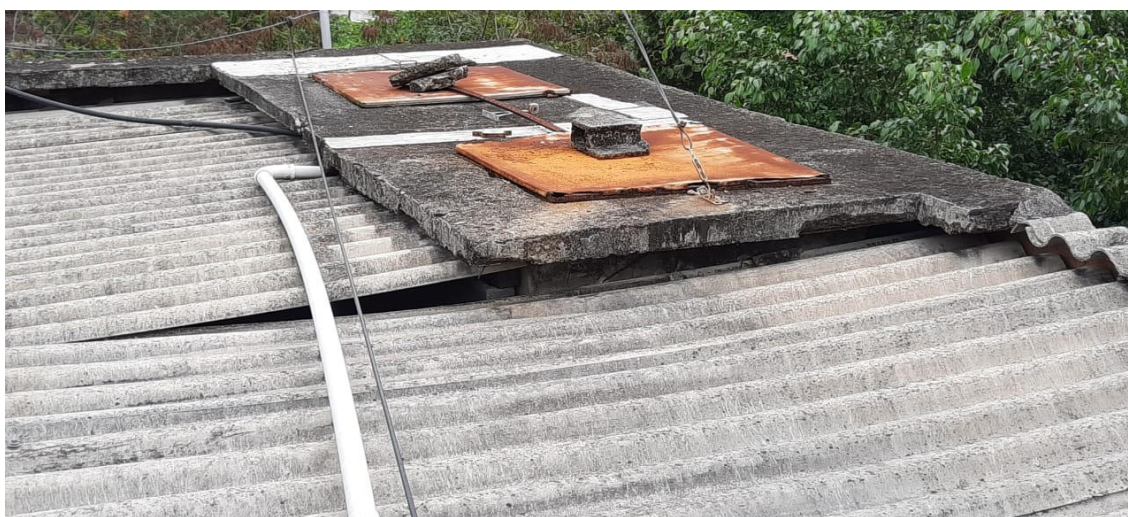
foto 36 - falha na vedação entre o telhado e o reservatório, tampas enferrujadas e soltas e a deterioração da laje do reservatório.
