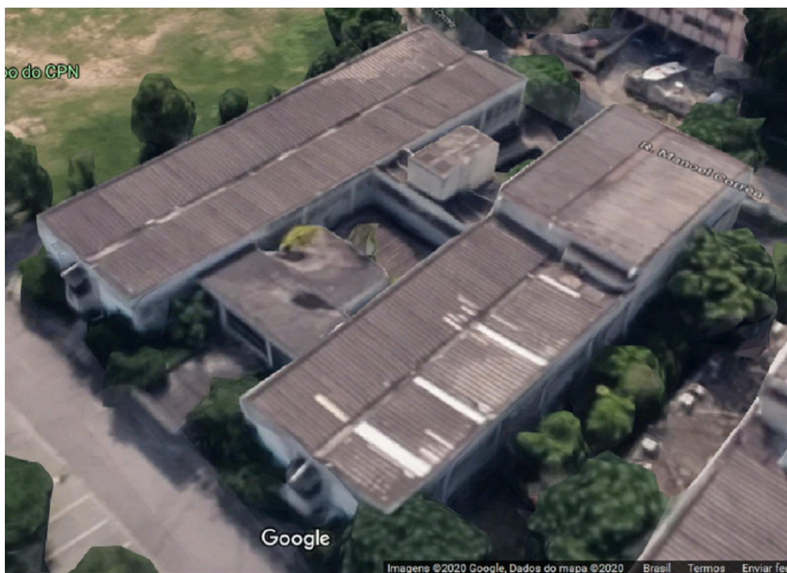
foto 30 - telhado dos 2 blocos do prédio do Arquivo, se observa algumas telhas substituídas, pontos de acumulação nas calhas e os extravasares instados nas calhas.
