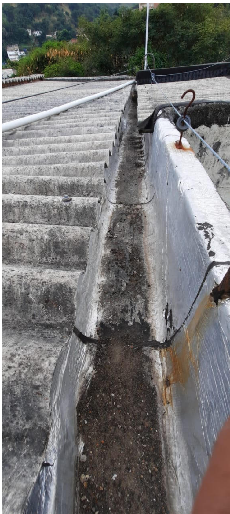
foto 34 - detalhe das telhas rentes a calha, falhas na impermeabilização, na vedação e no caimento formando pontos de acumulação.
