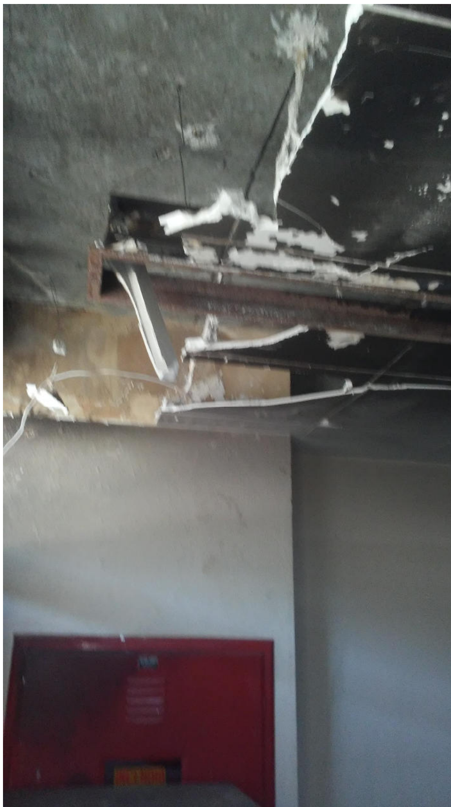
foto 12 - danos ao forro e a caixa de abrigo da mangueira de incêndio pelo fogo.
