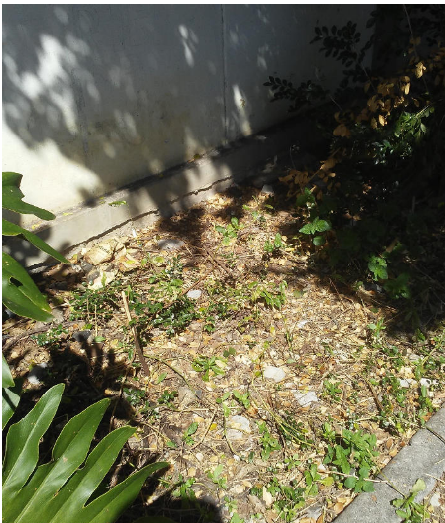
foto 38 - afundamento do terreno em volta do prédio do Arquivo
