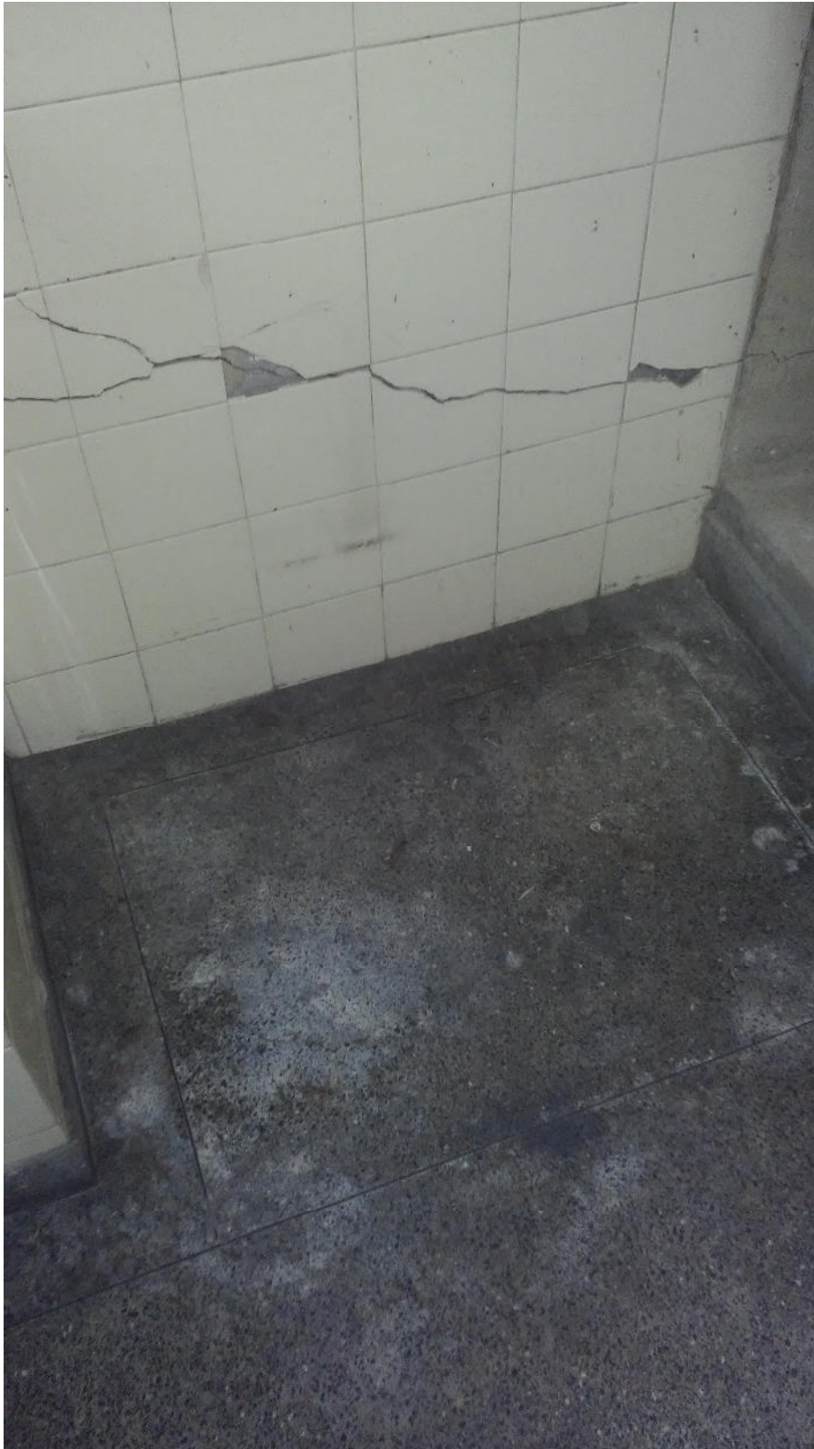
foto 23 - rachadura em parede apoiada diretamente no piso pav. térreo do prédio do Arquivo
