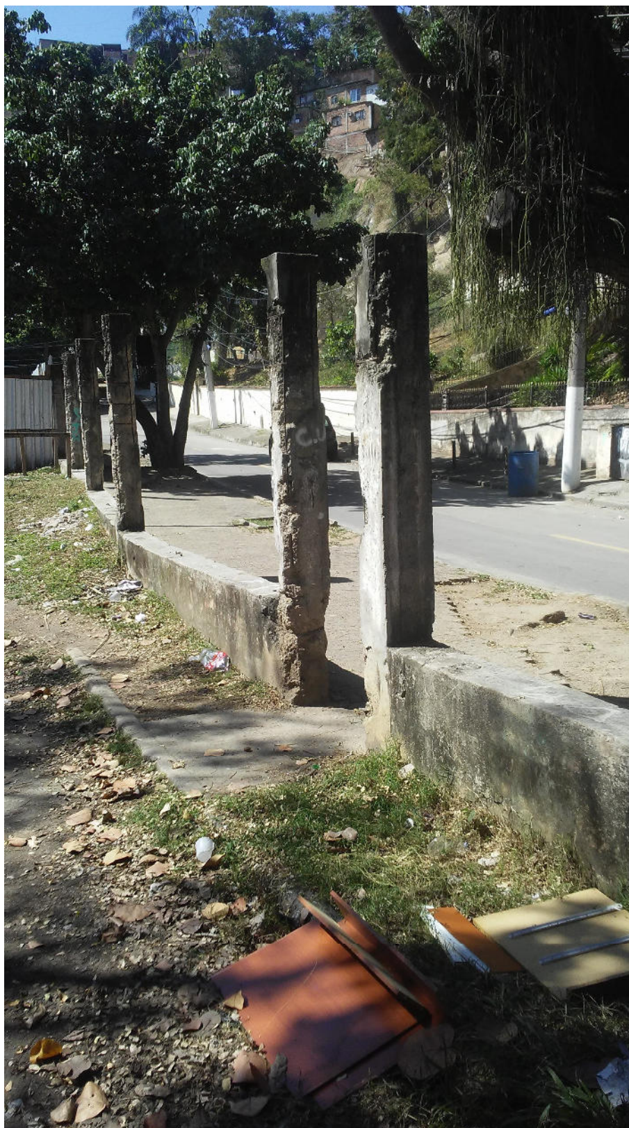
foto 9 - lixo e entulho entorno do prédio do Arquivo
