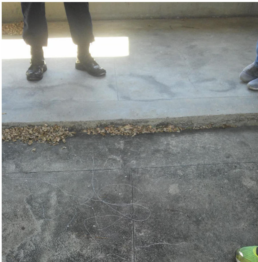
foto 24 - detalhe da diferença existente entre o piso da passarela e a rampa de acesso entre os blocos no prédio do arquivo.
