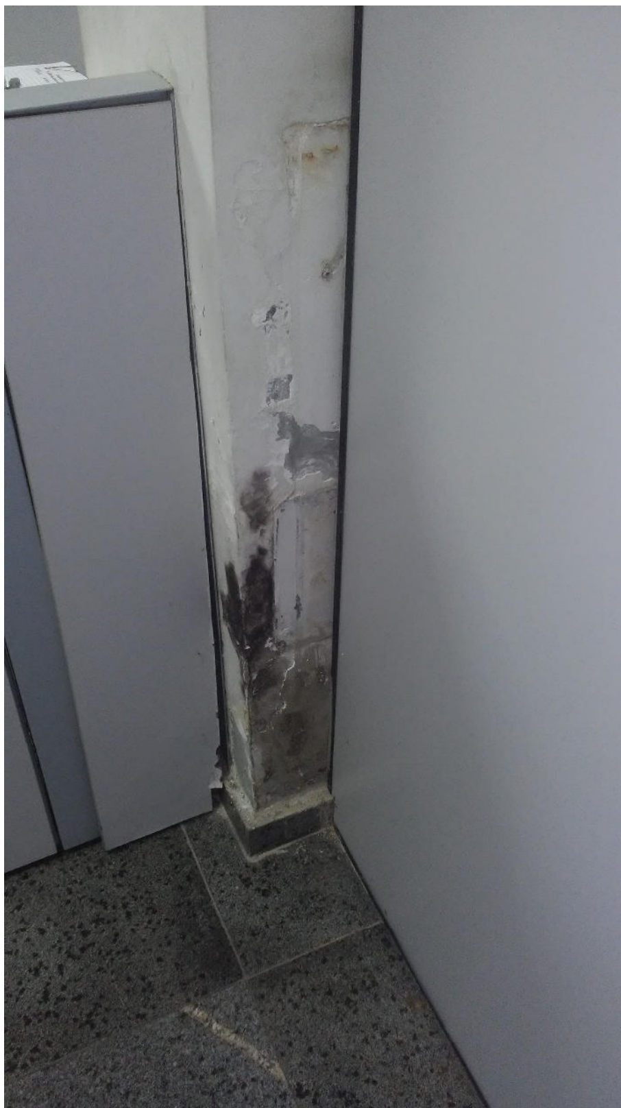
foto 21 - Reboco deteriorado pela proliferação de fungos
