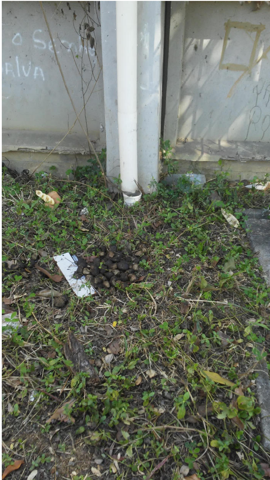
foto 10 - fezes de cavalo e o tubo de queda desconectado devido ao recalque do terreno.
