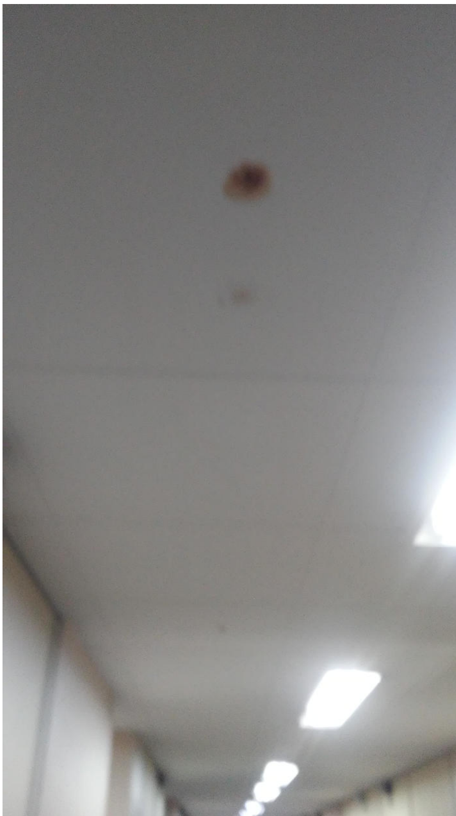
foto 16 - forro do corredor mancha de ferrugem proveniente das tubulações
