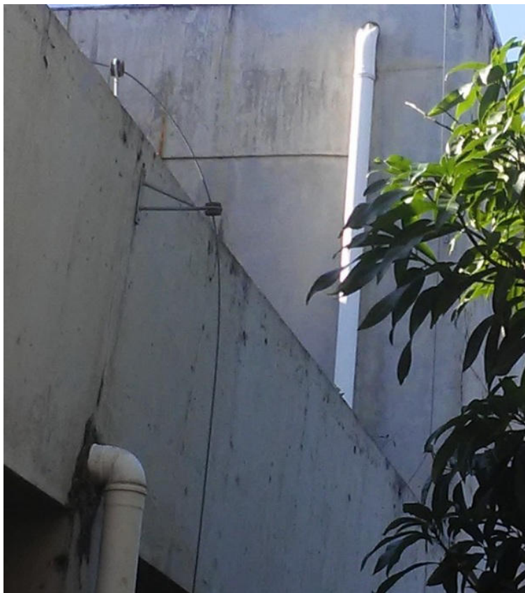
foto 35 - trecho de captação mal executado, com o aquecimento e a deformação do tubo e infiltração junto a captação.
