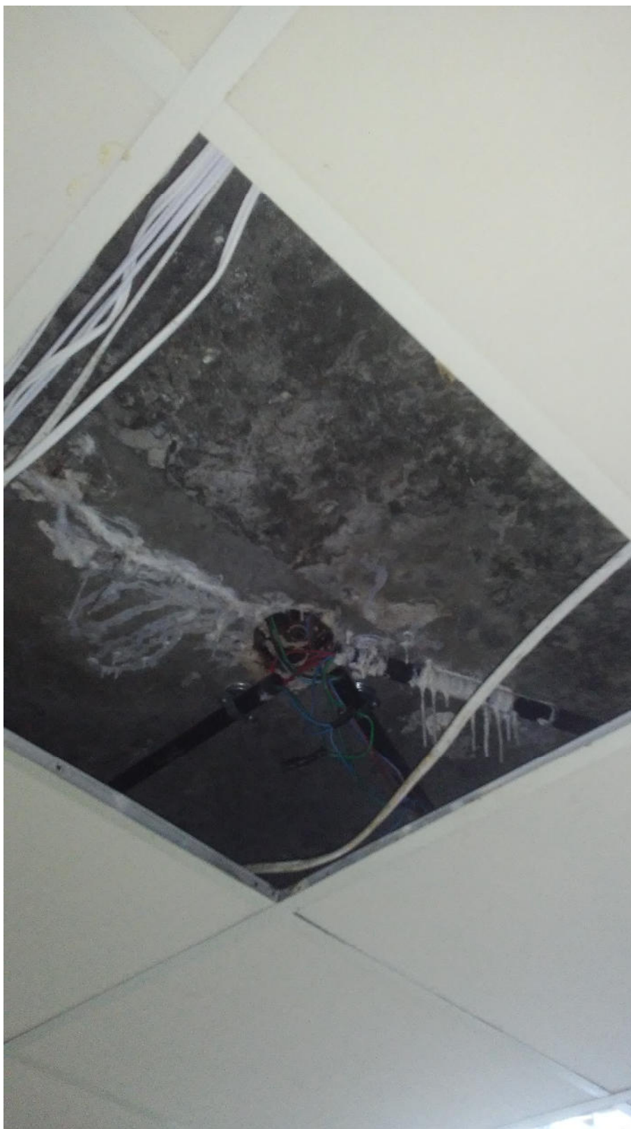
foto 18 - água infiltrando pela caixa de passagem - atendimento 1] pavimento
