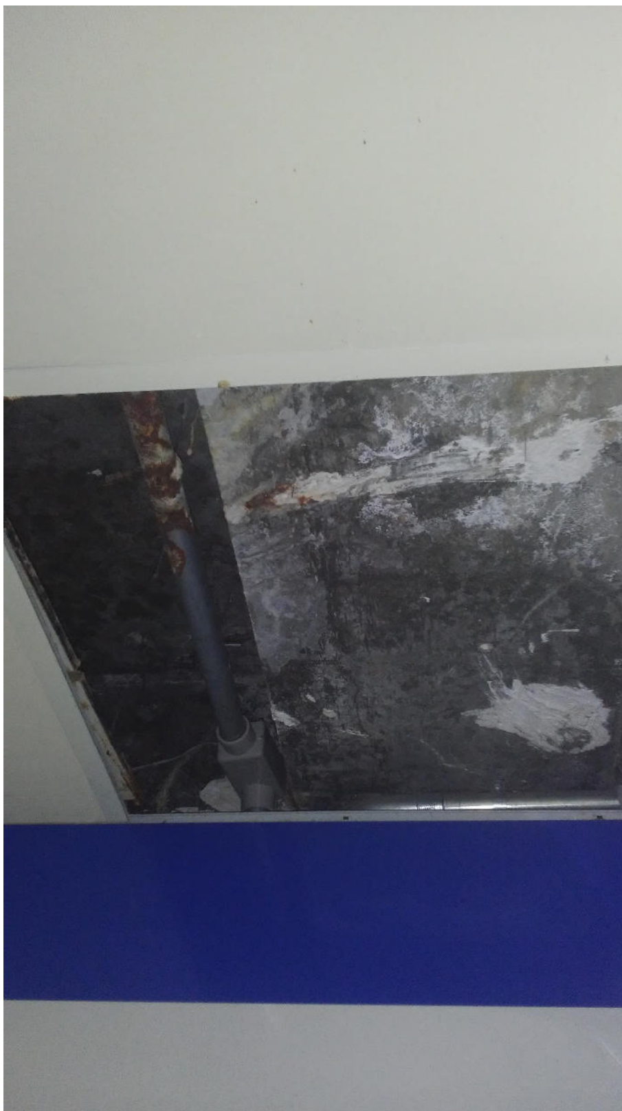
foto 17 - forro da área de atendimento na APS, oxidação nos eletrodutos
