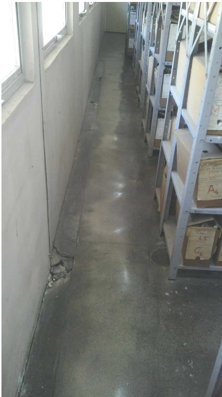
foto 22 - rachadura no piso no pavimento térreo do prédio do Arquivo no bloco mais próximo ao campo
