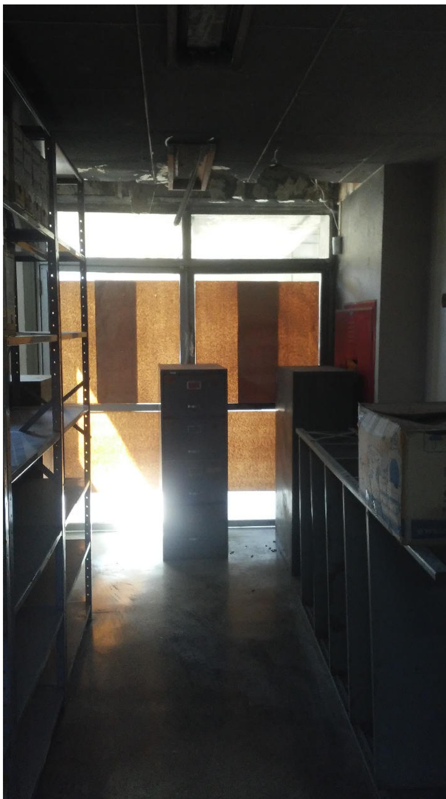
foto 11 - esquadria danificada pelo fogo
