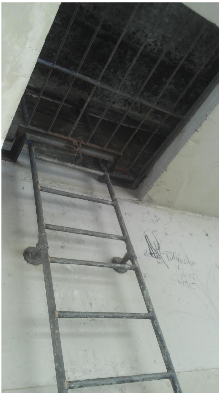
foto 25 - escada de acesso ao telhado ao lado da rampa, com a grade abrindo para o acesso sob o reservatório, dificultando bastante a passagem.
