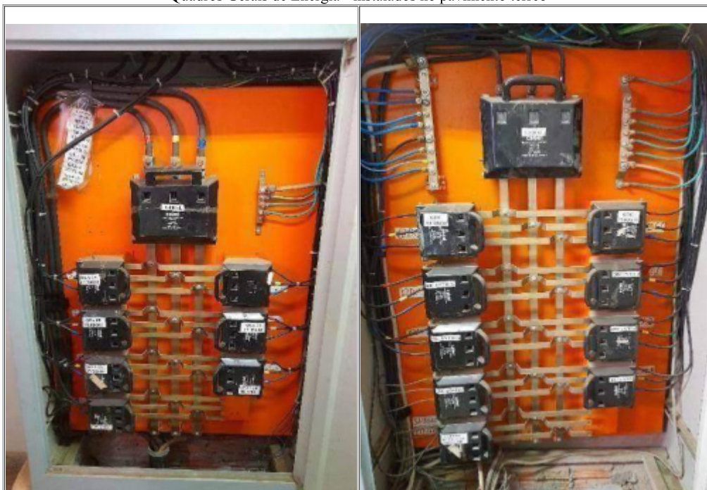
Fig. 6 - QGAC - Quadro Geral de Ar Condicionado
