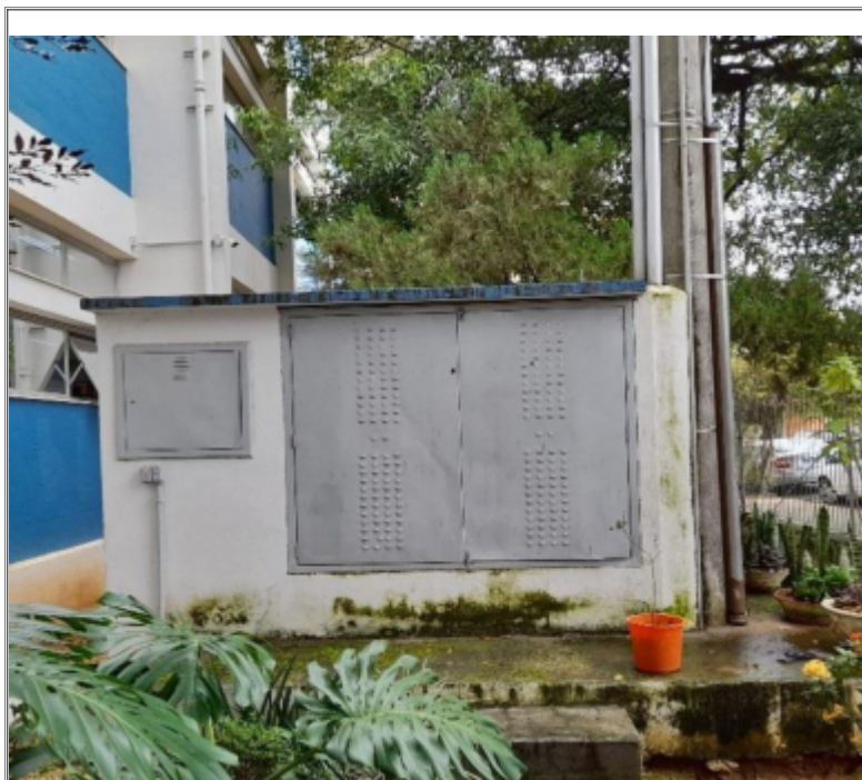
Fig. 1 - Entrada de Energia (AL1)
