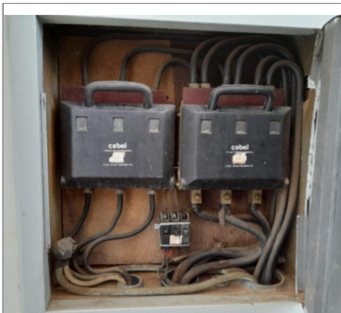
Fig. 2 - Quadro de proteção geral (QD13)
